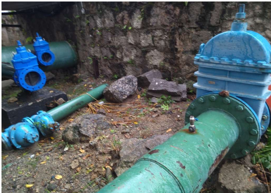
Fotografia 14 – Rede de recalque
