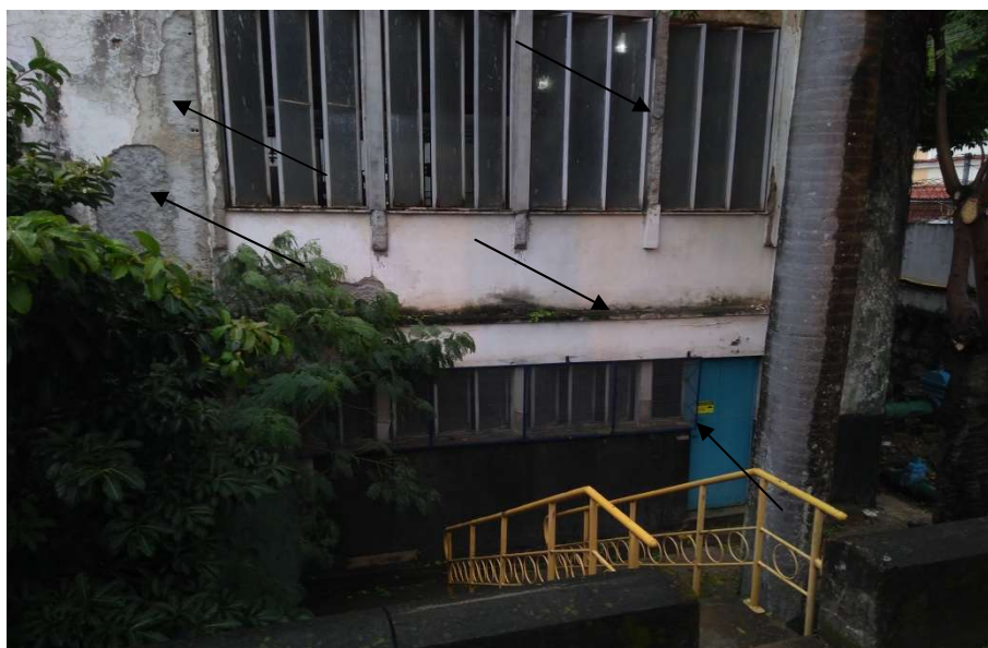
Fotografia 10 – Fachada da 2ª casa de máquinas. Setas indicam as patologias.
