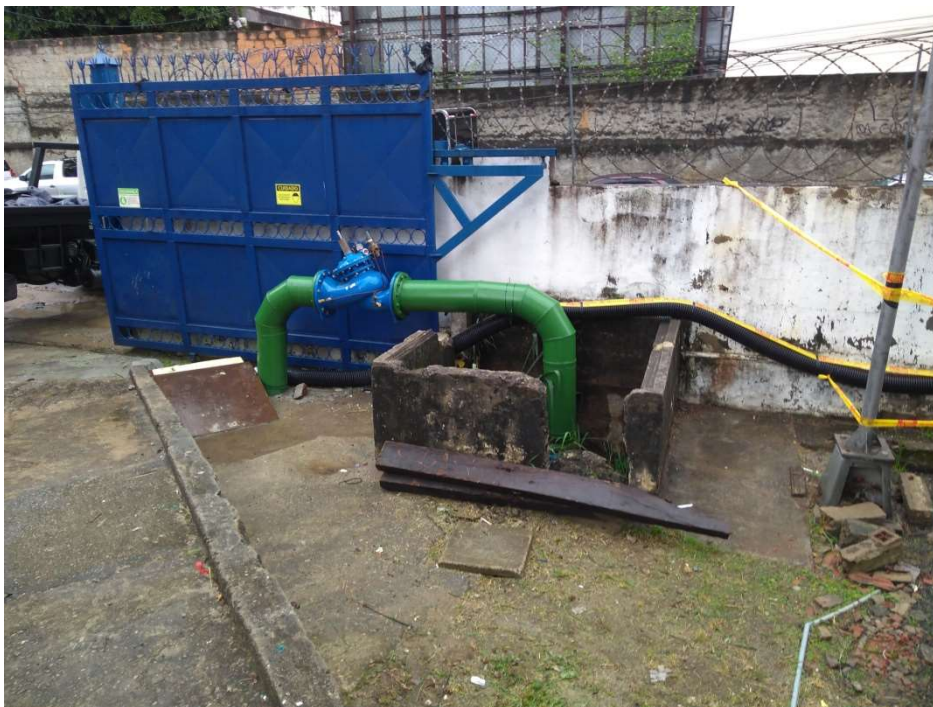
Fotografia 1 – Entrada da elevatória
