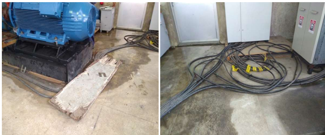
Fotografias 3 e 4 – Vazamentos próximos ao sistema elétrico
