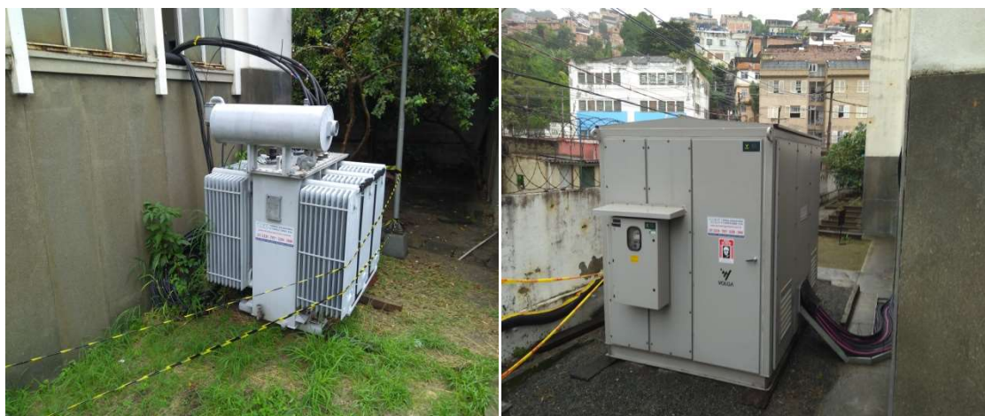
Fotografias 7 e 8 – Transformador e gerador locado
