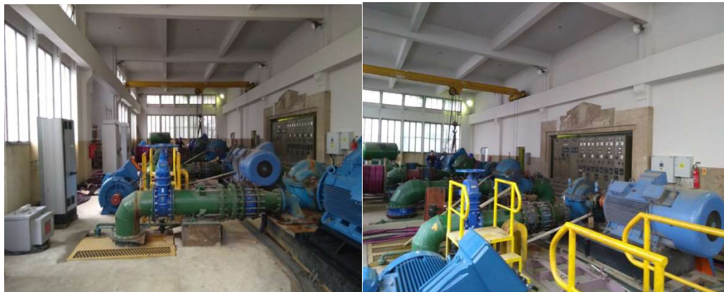
Fotografias 1 e 2 – Estação de bombeamento (05 grupos)
