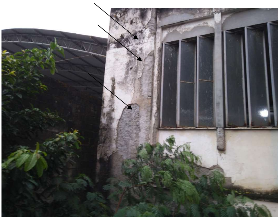
Fotografia 11 – Fachada da 2ª casa de máquinas. Setas indicam as patologias
