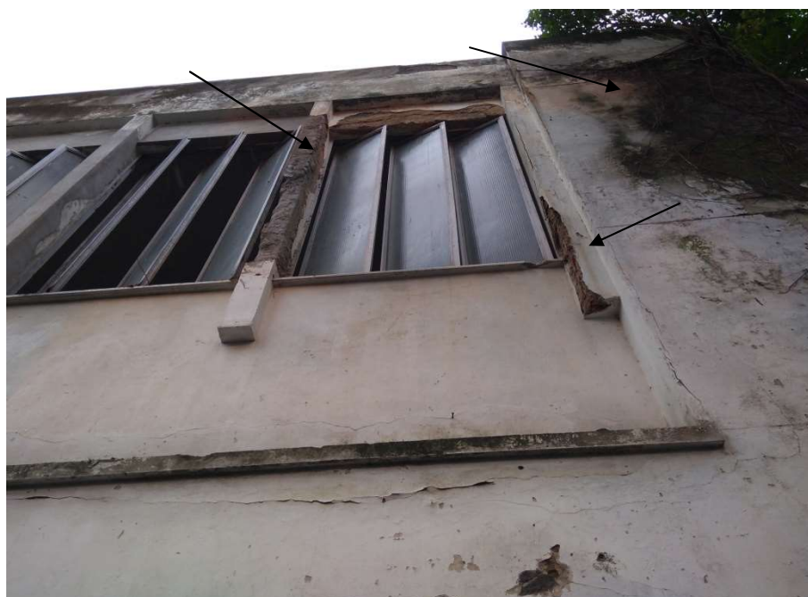
Fotografia 12 – Fachada da 2ª casa de máquinas. Setas indicam as patologias
