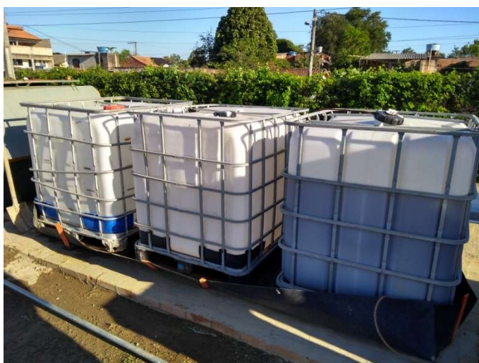
Foto 09 – Tanques Policloreto de Alumínio (PAC)
