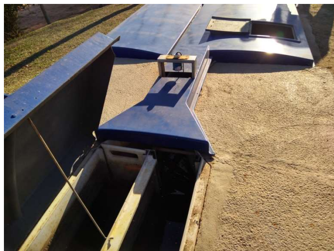
Foto 06 – Calha Parshall com Medidor de Vazão Ultrassônico
