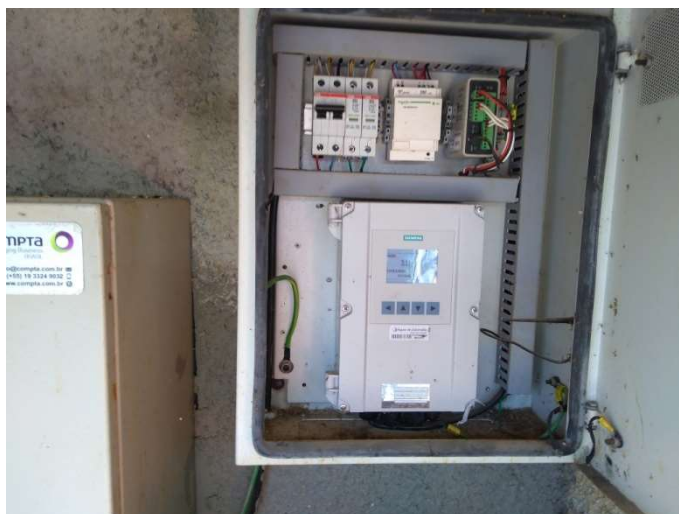
Foto 08 – Painel Medidor de Vazão 3,11 l/s
