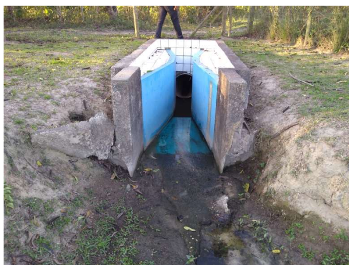
Foto 16 – Saída do Esgoto Tratado para o Rio Capivari
