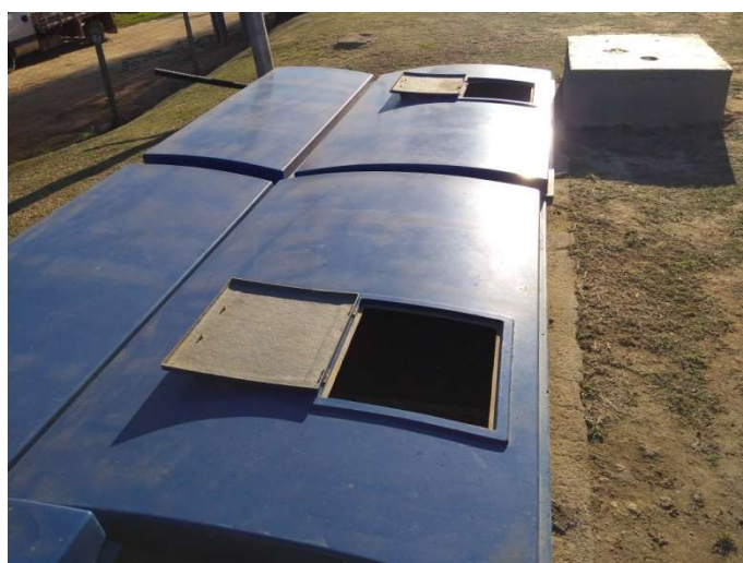
Foto 07 – Tanques de Gordura
