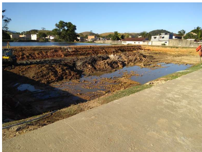
Foto 14 – Lagoa de Decantação (Em Manutenção)
