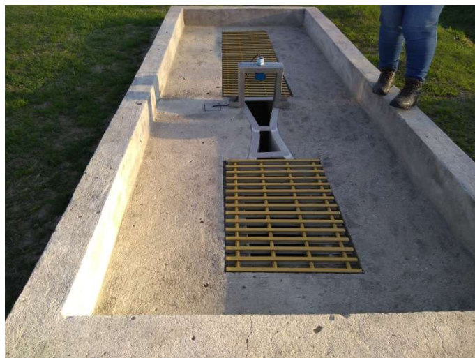
Foto 15 – Calha Parshall com Medidor de Vazão Ultrassônico na Saída do Esgoto Tratado
