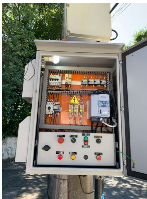
Fotografia 5 – Painel de comando da elevatória B. Mato 1
