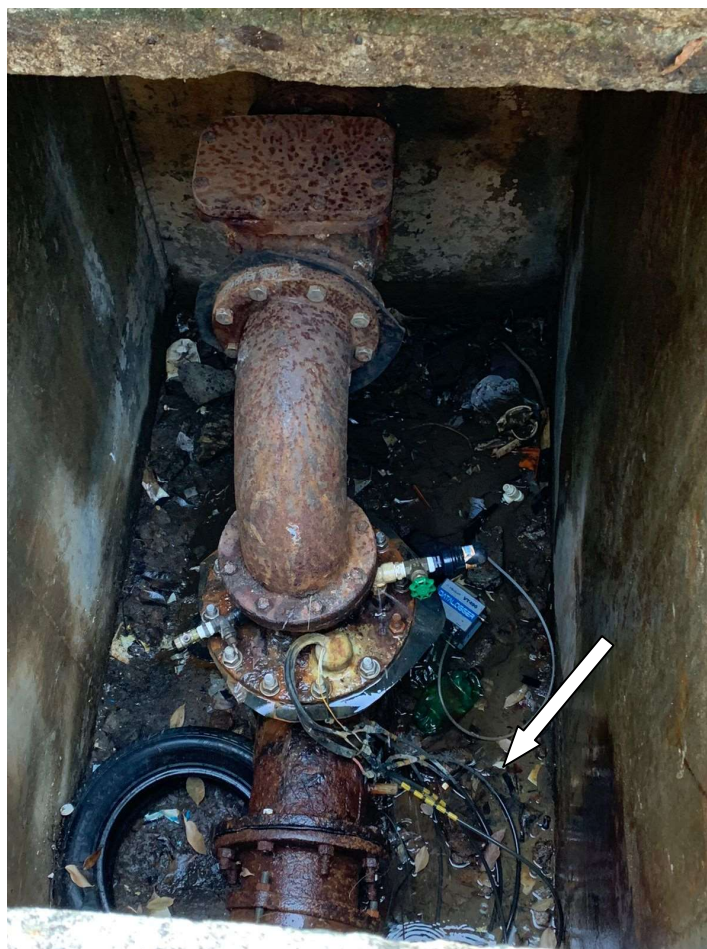
Fotografia 4 – Caixa alagada e tomada de resíduos
