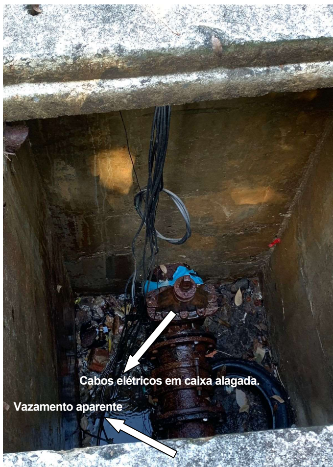
Fotografia 3 – Caixa de abrigo cheia de água
