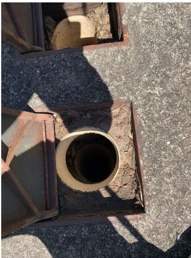
Fotografia 9 – Registros de retaguarda e recalque
