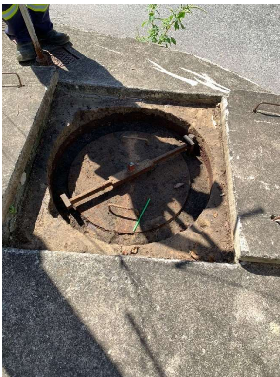
Fotografia 6 – Caixa de abrigo (panelão) da elevatória B. Mato 2
