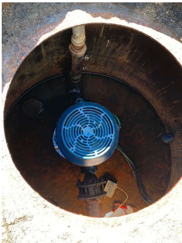
Fotografia 7 – Caixa de abrigo (panelão) da elevatória B. Mato 2
