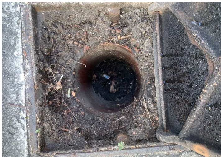
Fotografia 8 – Registro de recalque (com água na caixa)
