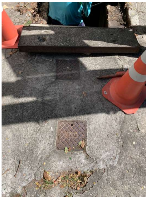
Fotografia 7 – Registro de recalque e ponto de pressão
