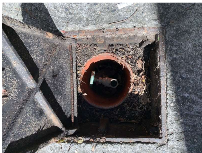
Fotografia 9 – Derivação para ponto de pressão
