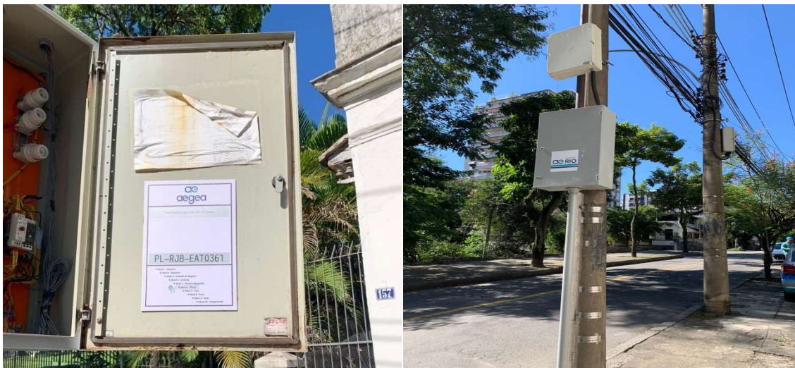
Fotografia 5 e 6 – Painel de alimentação elétrica
