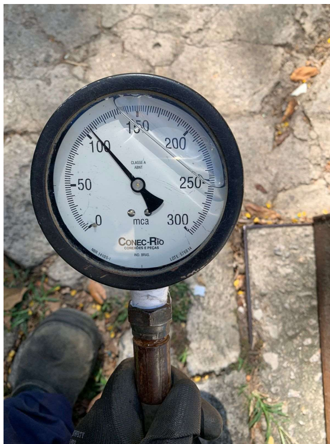
Fotografia 4 – Pressão manométrica de recalque
