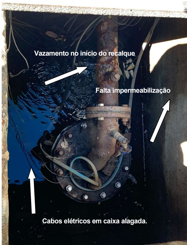
Fotografia 2 – Caixa de abrigo cheia de água
