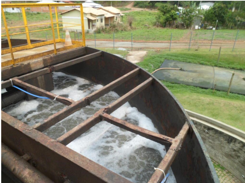
Foto 18 – Tanque de Aeração 2
