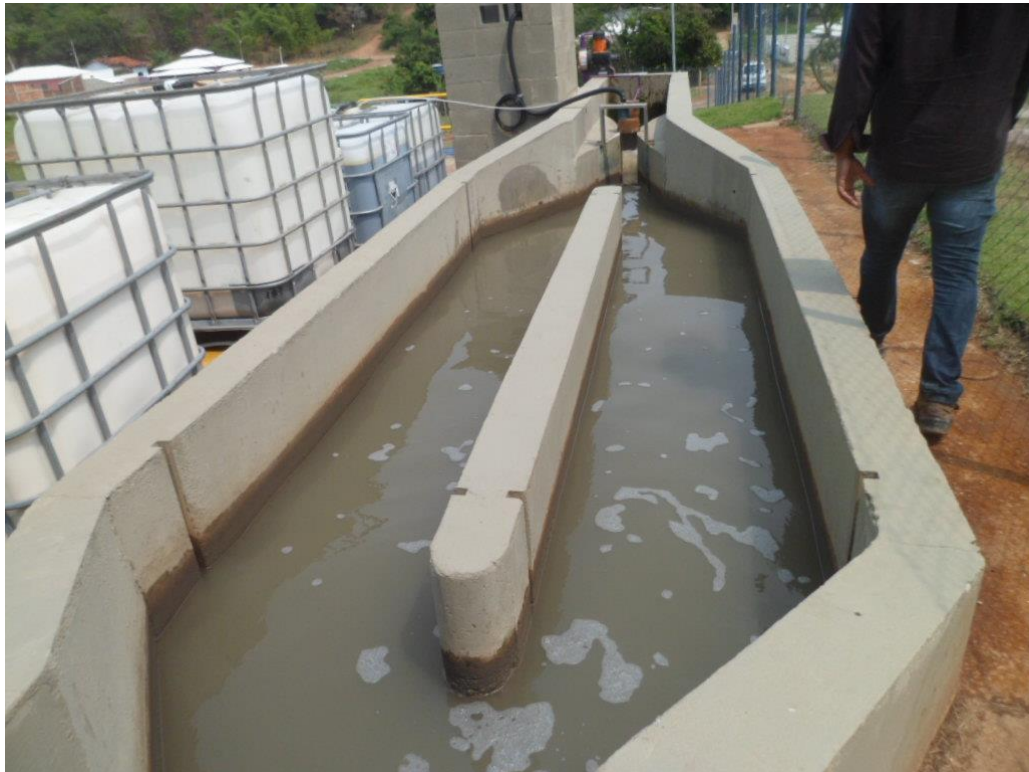
Foto 08 – Caixa de areia
