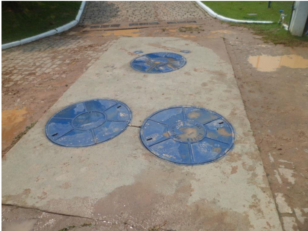
Foto 04 – Tampas sobre a Elevatória na entrada da ETE
