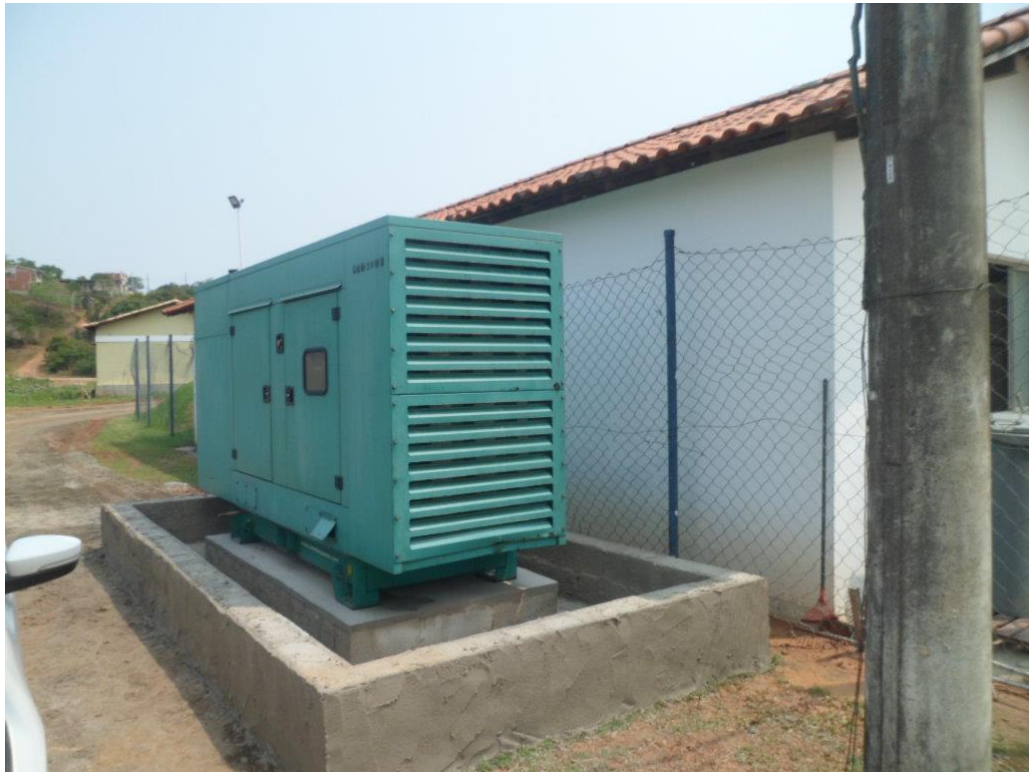
Foto 27 – Gerador para falta de energia
