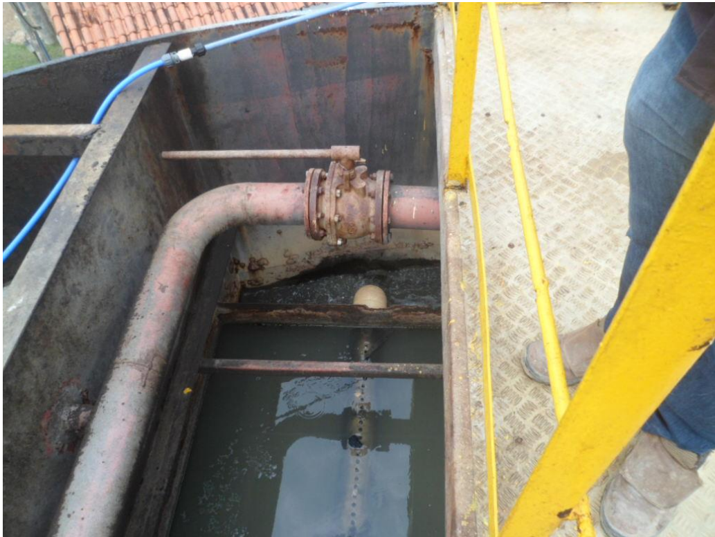
Foto 20 – Saída do Tanque de Decantação
