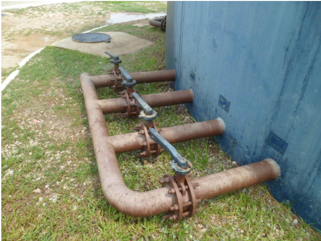
Foto 21 – Registros de controle da saída do lodo
