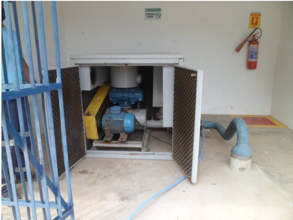
Foto 14 – Soprador que lança carga de ar para os Aeradores
