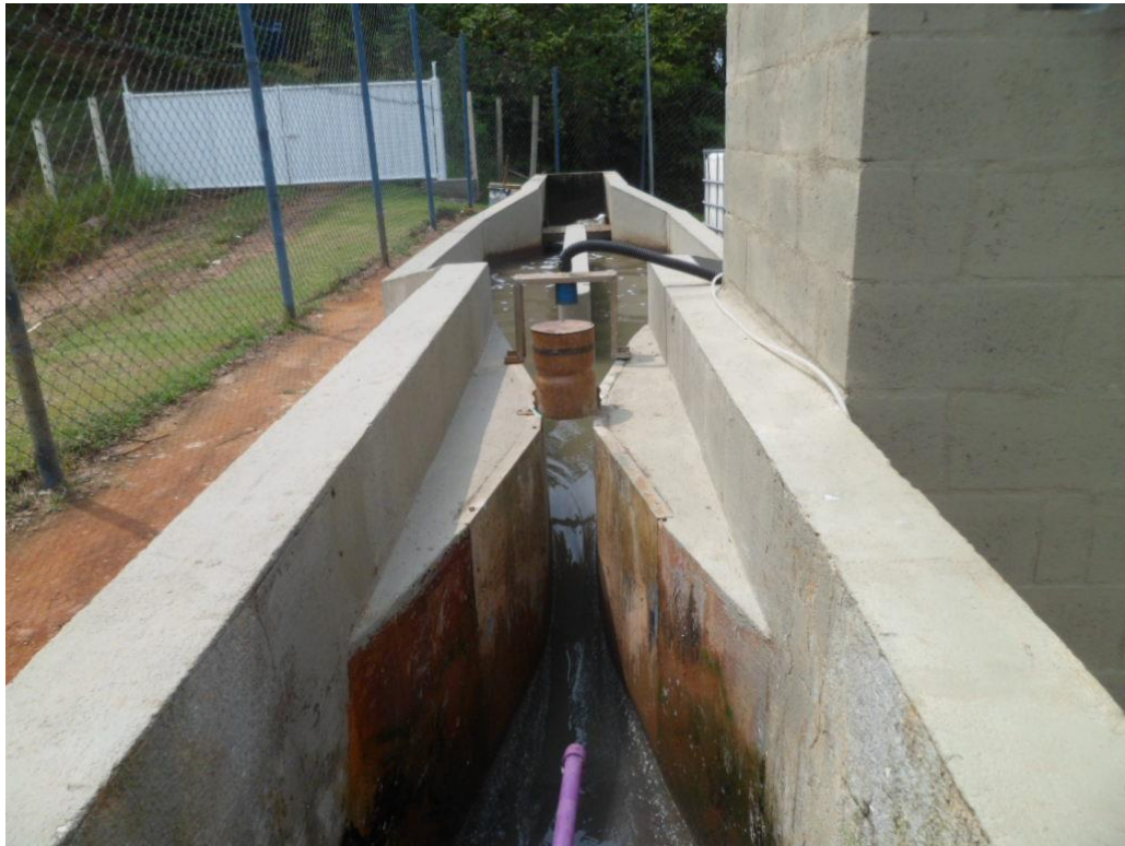
Foto 09 – Medidor de vazão calha Parshall
