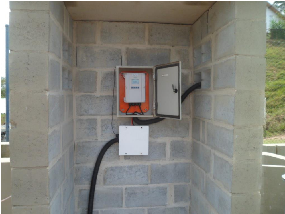
Foto 10 – Medidor de vazão ultrassônico
