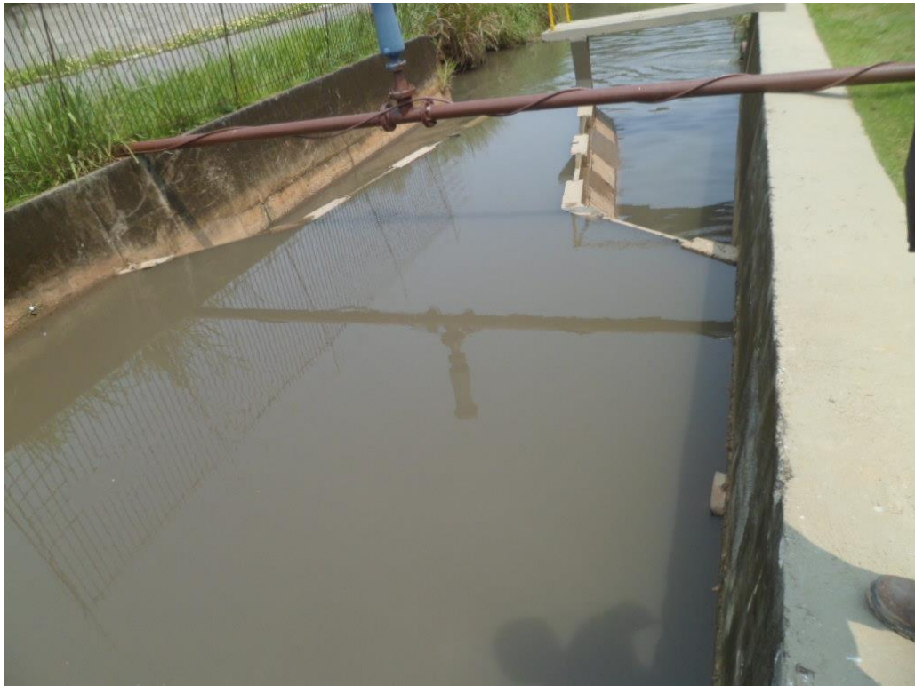
Foto 02 – Interceptor no Rio Bacaxá (extravasando por conta das chuvas) a Jusante
