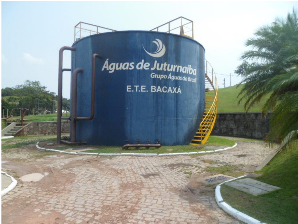
Foto 15 – Tanque de Aeração e Decantação
