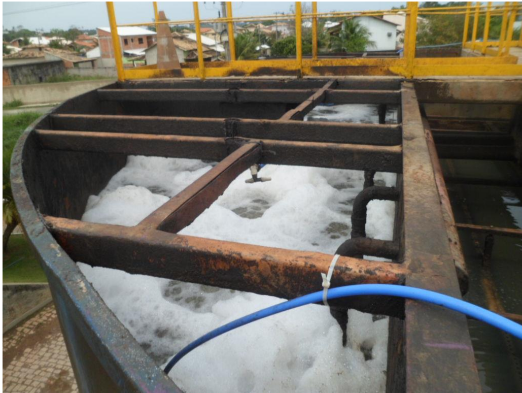
Foto 17 – Tanque de Aeração 1
