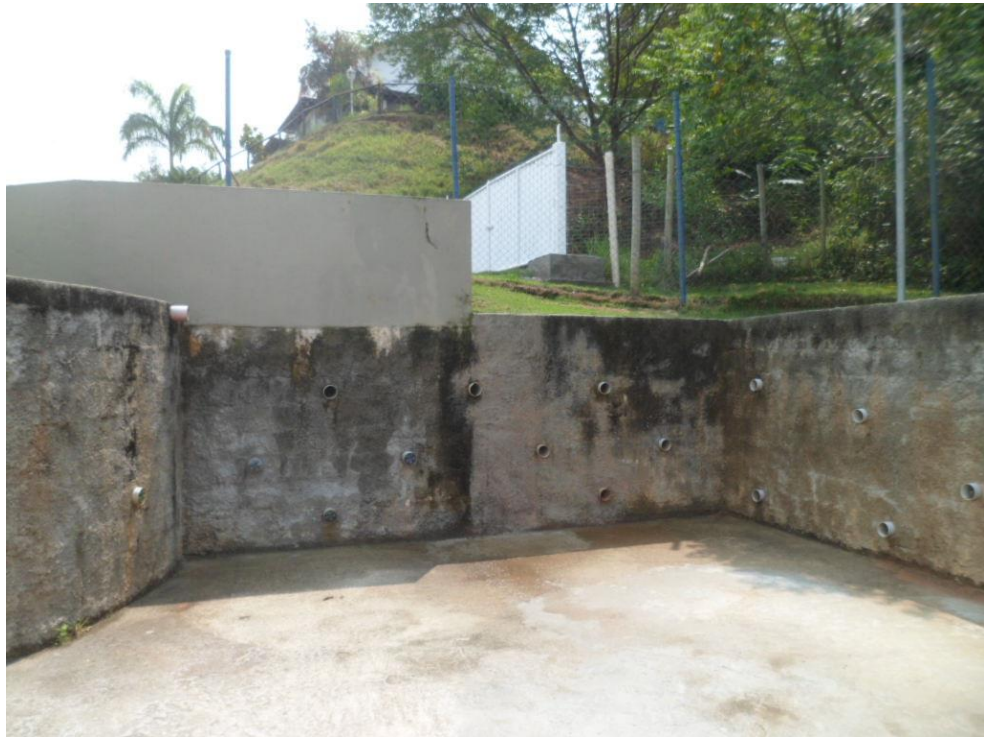
Foto 06 – Parada de caminhão hidrovácuo na entrada do esgoto bruto
