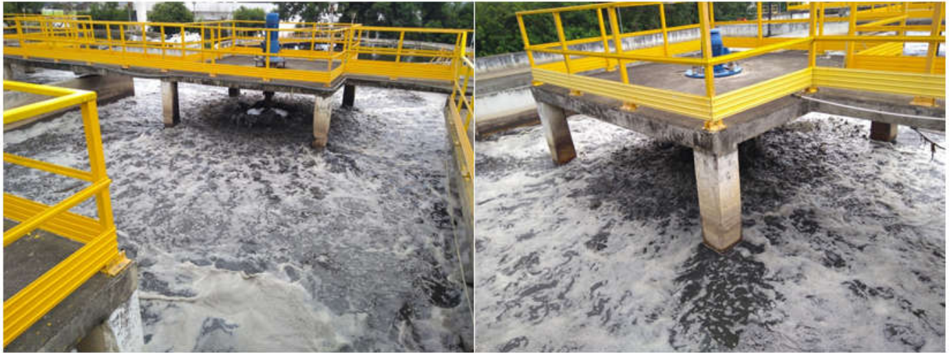
Foto 11 – Tanques com 04 (quatro) Aeradores, sendo 01 (um) aerador flutuante venturi
