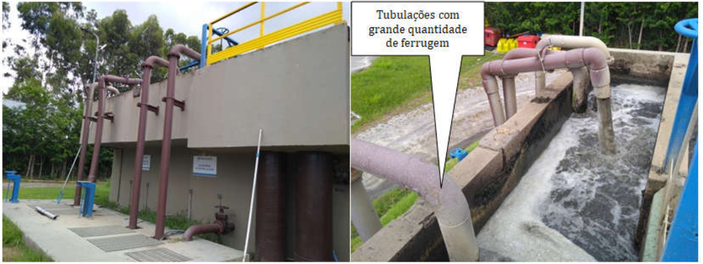
Foto 10 – Elevatórias do Esgoto Bruto e Recirculado
