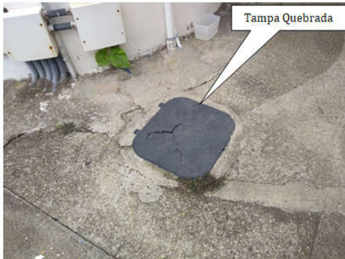
Foto 24 – Tampa da caixa de inspeção quebrada em frente ao laboratório
