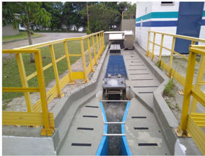
Foto 17 – Calha Parshall na Saída do Esgoto Tratado e Desinfecção com Ultravioleta
