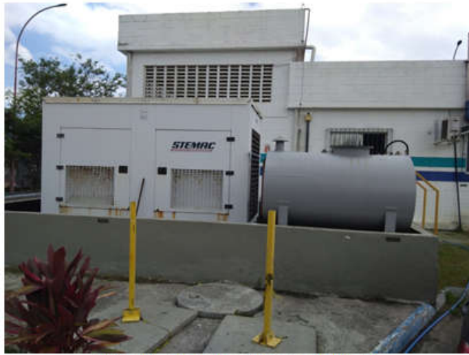
Foto 22 – Gerador e Tanque de Diesel
