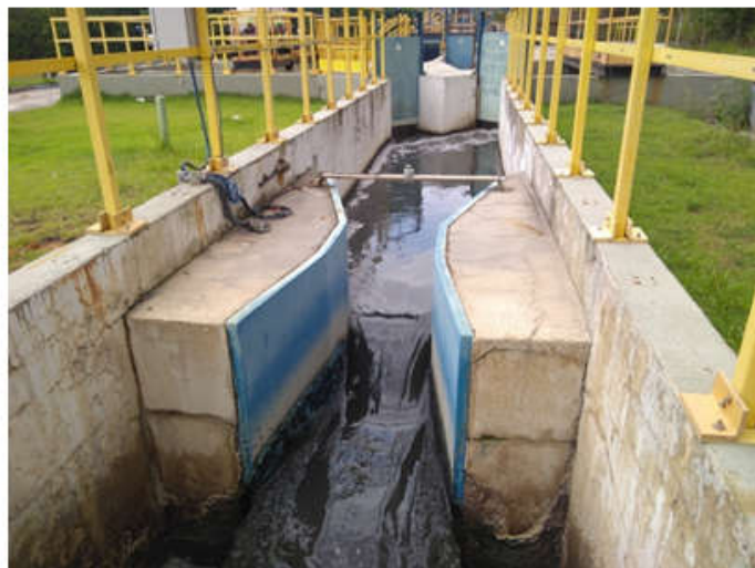
Foto 09 – Calha Parshall com Medidor de Vazão Ultrassônico
