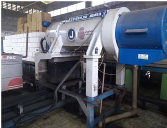
Foto 14 – Centrifuga de Desidratação do Lodo
