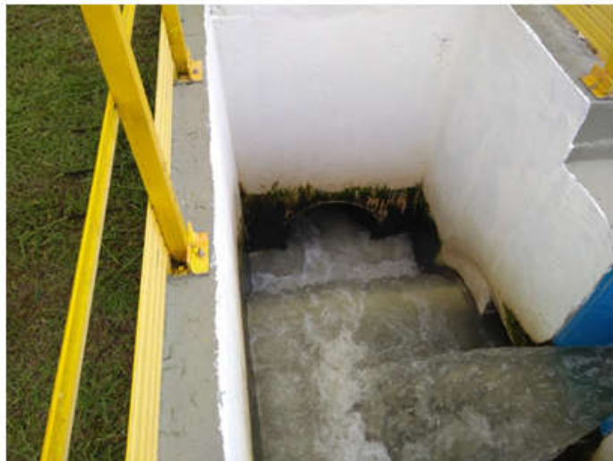
Foto 18 – Saída do Esgoto Tratado
