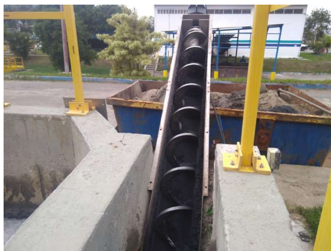
Foto 06 – Rosca Transportadora Retira a Areia do Desarenador e Direciona para a Caçamba.
