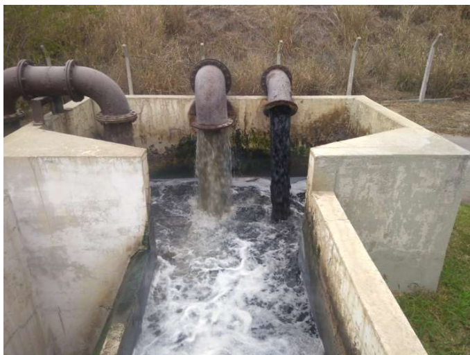
Foto 02 – Entrada do Esgoto Bruto In Natura das 03 (três) Elevatórias 120 l/s
