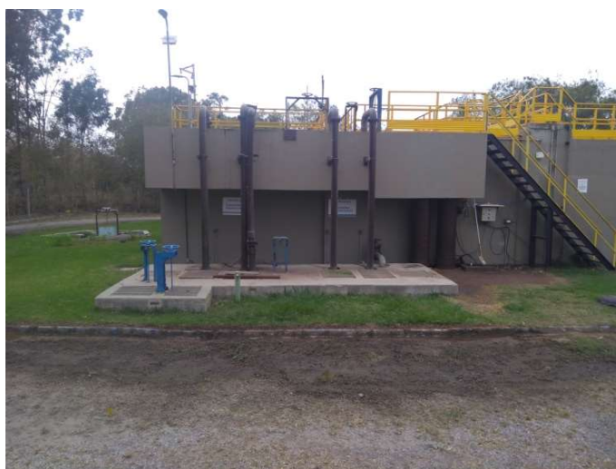
Foto 08 – Elevatória do Esgoto Bruto e Recirculado
