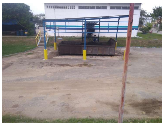
Foto 17 – Esteira de Retirada do Lodo e Lançamento na Caçamba
