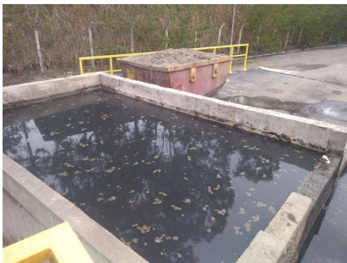
Foto 03 – Local de Recebimento do Caminhão Limpa Fossa
