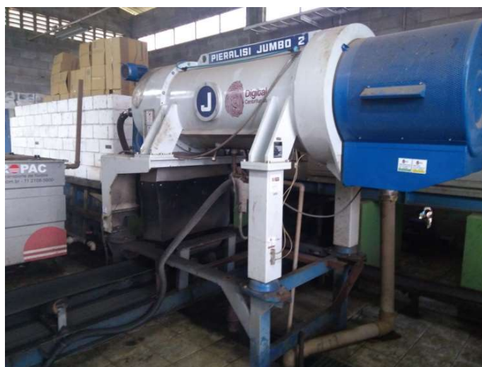
Foto 15 – Centrifuga de Desidratação do Lodo
