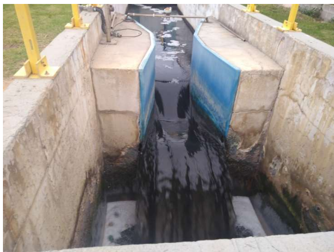
Foto 07 – Calha Parshall com Medidor de Vazão Ultrassônico
