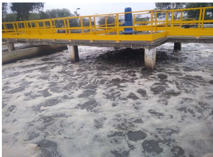
Foto 10 – Tanques com 04 (quatro) Aeradores
