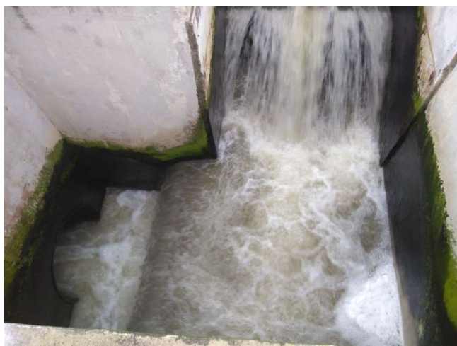
Foto 19 – Saída do Esgoto Tratado
