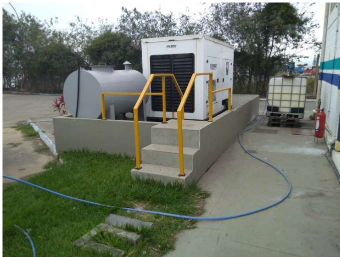
Foto 25 – Gerador e Tanque de Diesel
