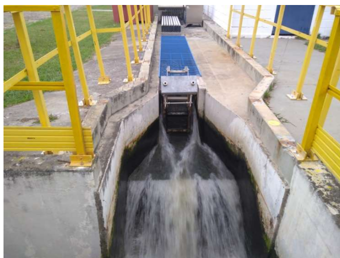
Foto 18 – Saída do Esgoto Tratado e Desinfecção com Ultravioleta
