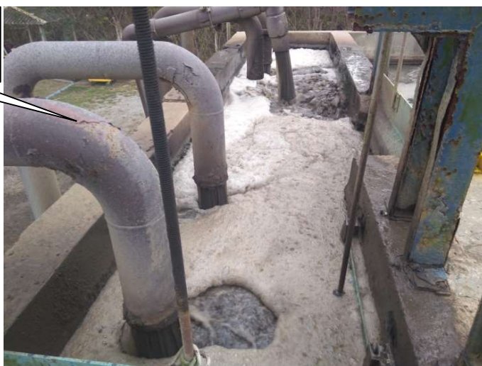
Foto 09 – Elevatória de Esgoto Bruto e Recirculado
