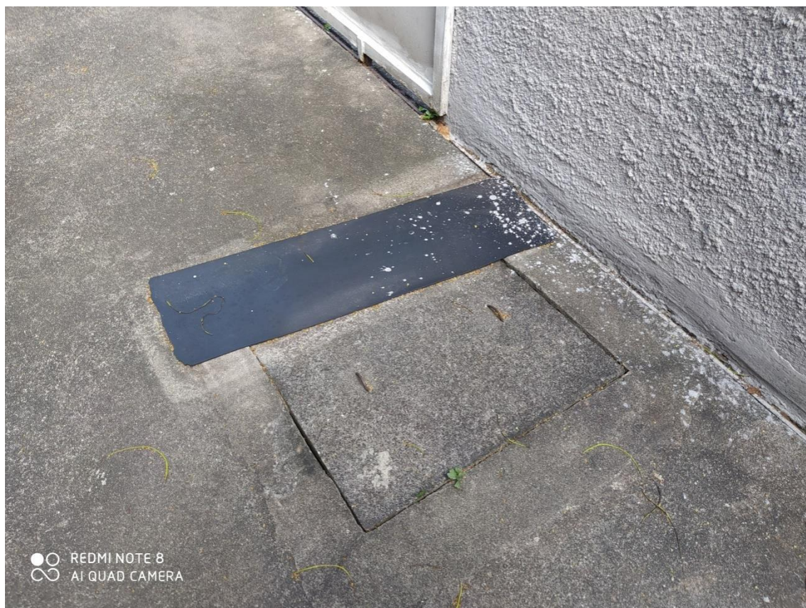
Cisterna na residência da usuária reclamante.
