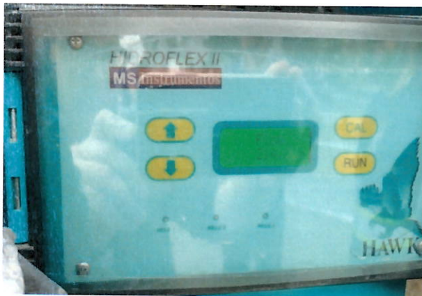
Vazão medida na saída da Estação
