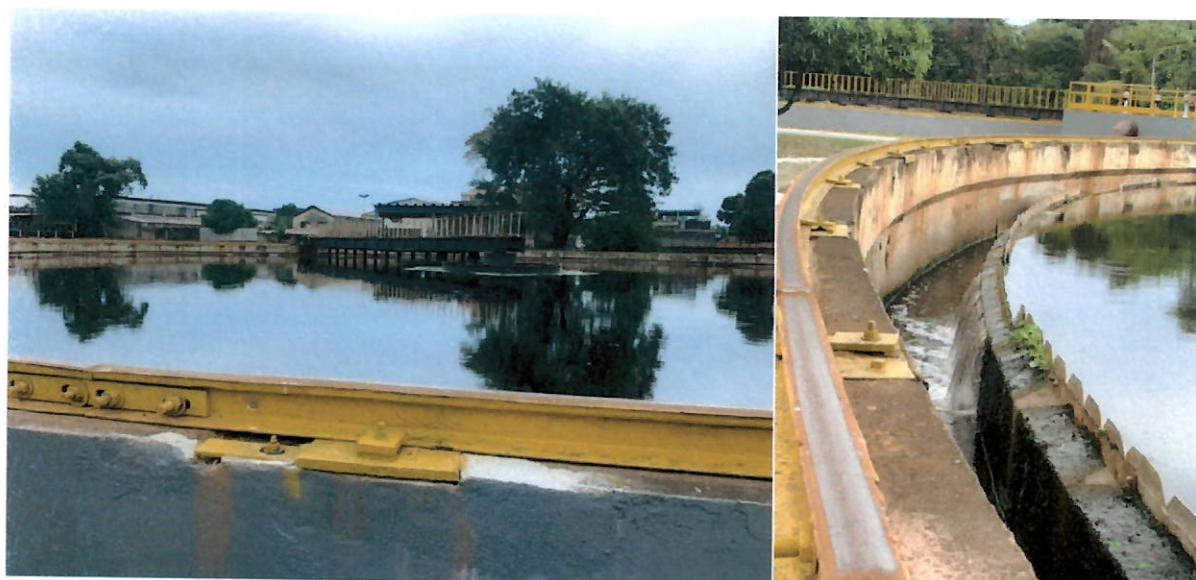
Decantadores secundários em operação
