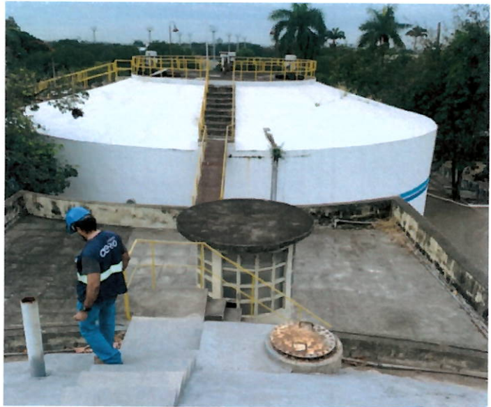
Biodigester possivelmente inoperante
