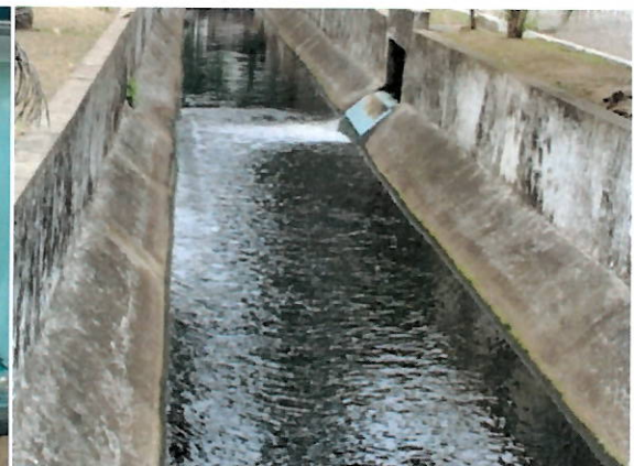
Retorno do esgoto tratado ao Canal
