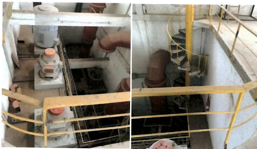
Bombas da EEEB
