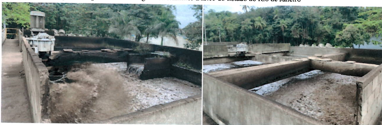
Tanque de aeração em operação
