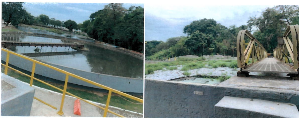
Decantadores inoperante com a presença de vegetação crescendo livremente
