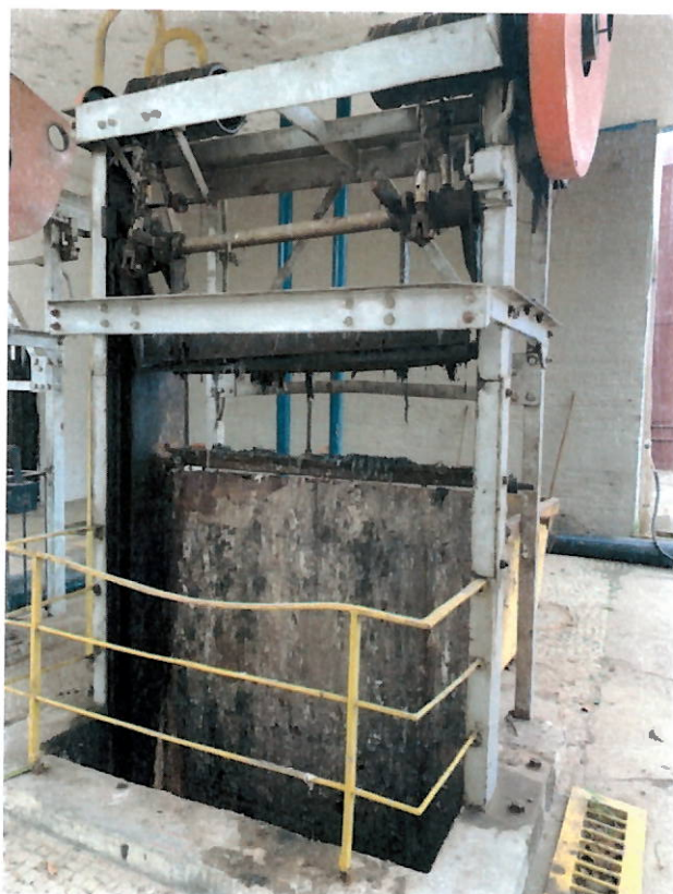
Conjunto de grades para retenção dos sólidos grosseiros
