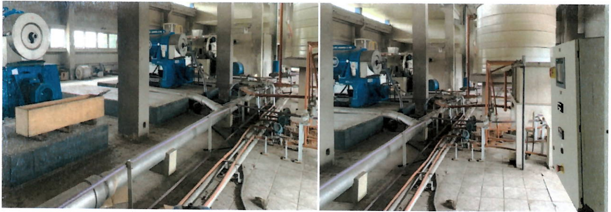
Local onde se encontram as centrífugas para secagem do lodo
