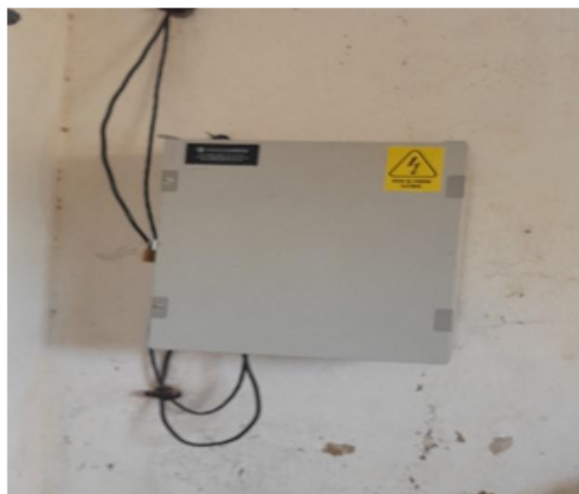
Painel do sistema controlador de nível
