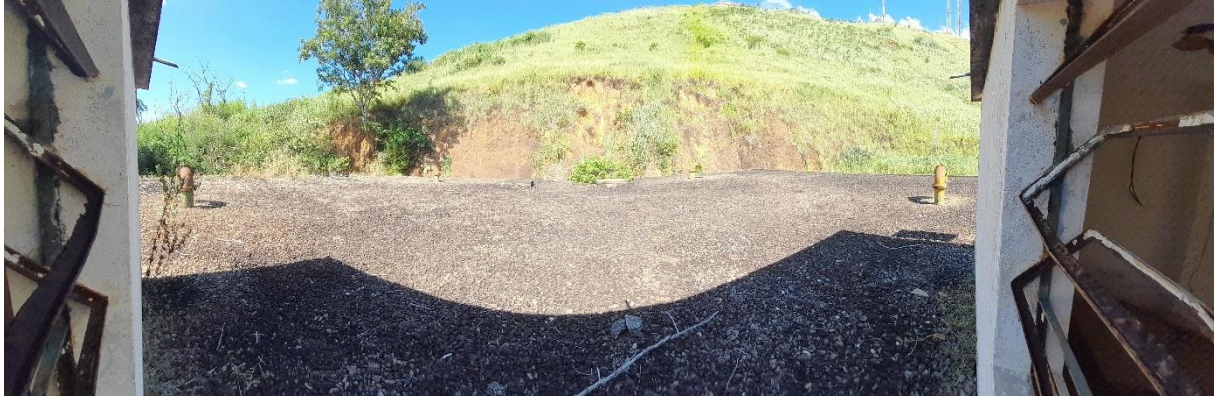
Vista superior do reservatório com dutos de ventilação
