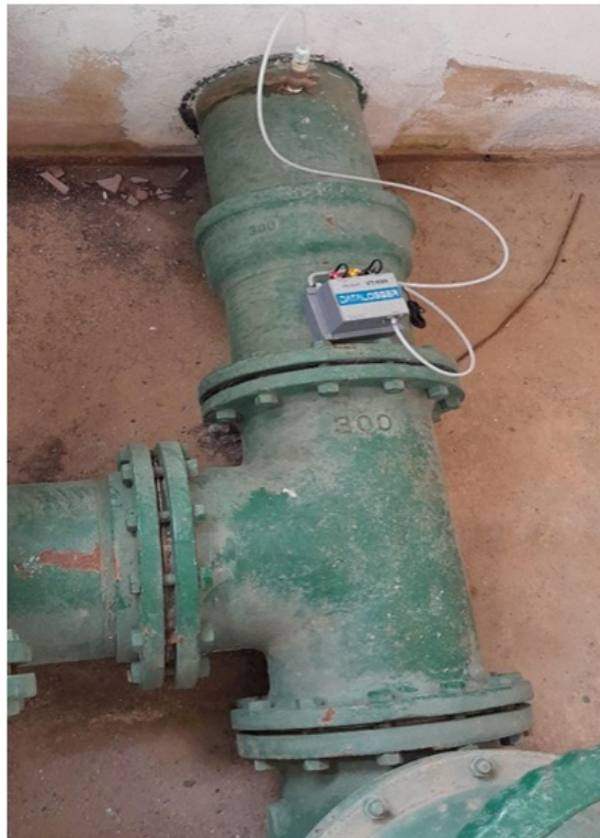
Datalogger: sistema de medição de nível
