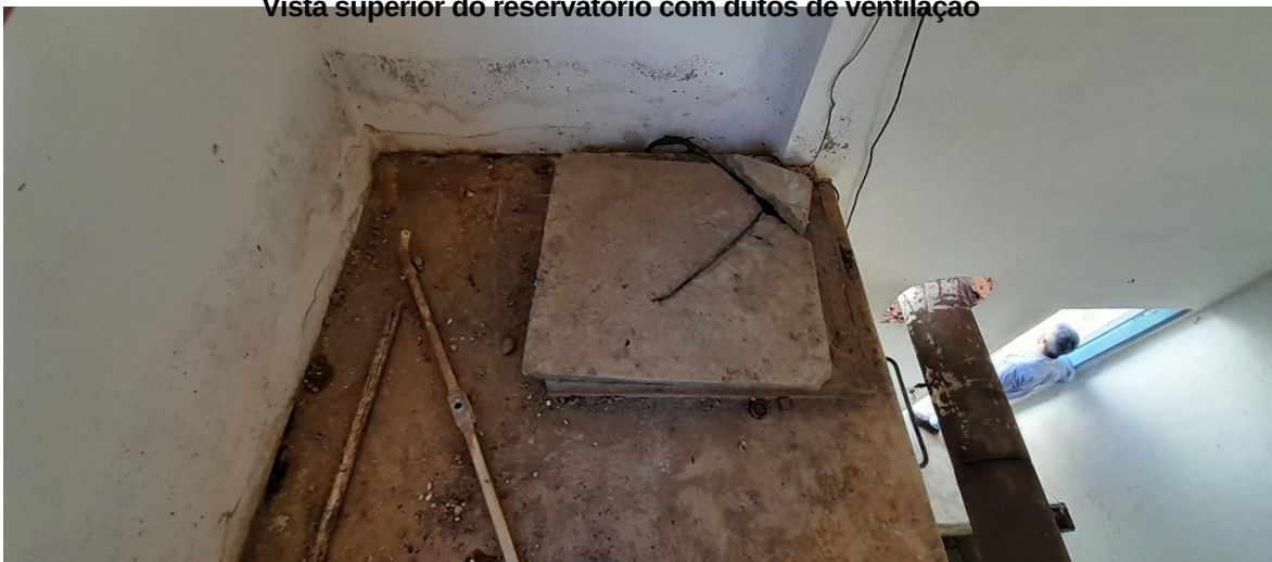
Tampa de Inspeção A
