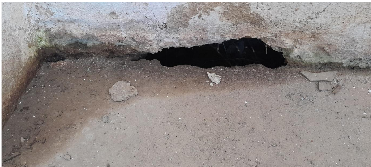
Ponto de erosão subterrânea
