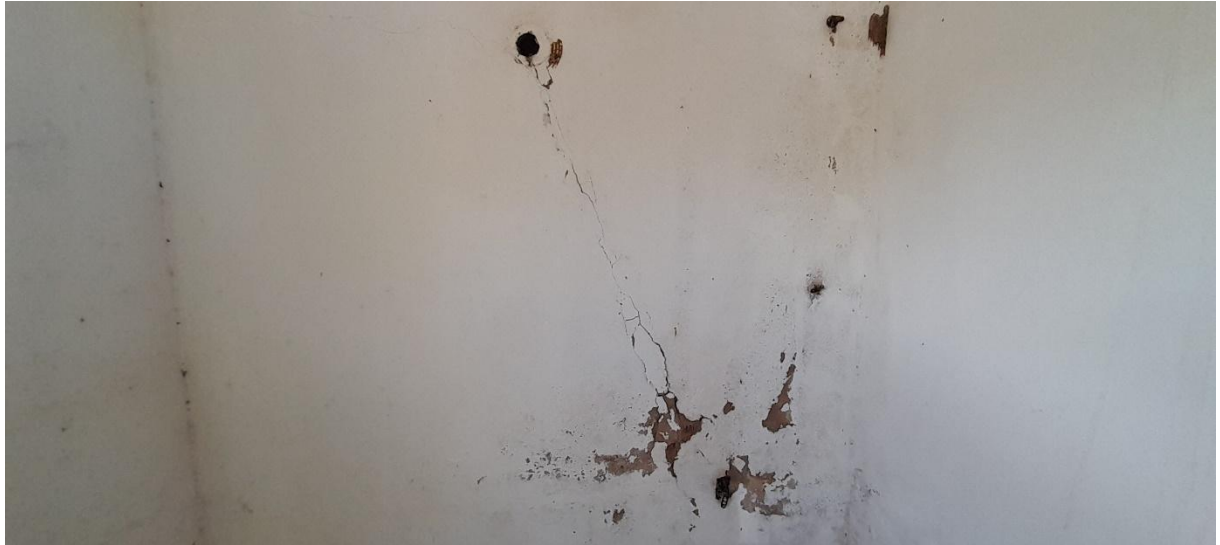
Má conservação das paredes, apresentando trincas e tintas descascando
