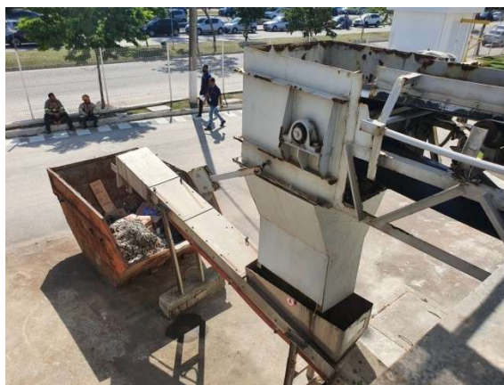
Foto 04 – Caçamba para remoção dos sólidos
