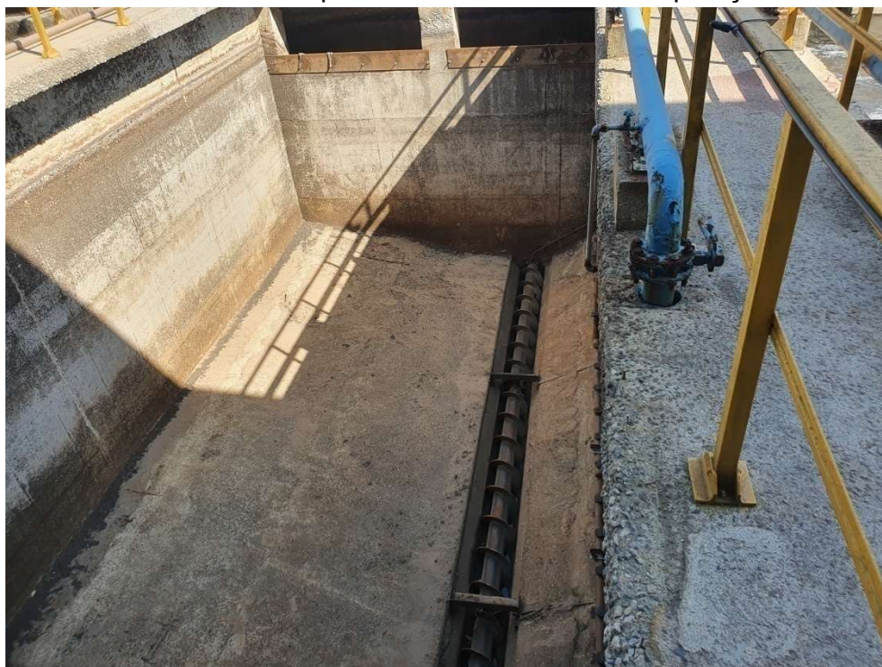
Foto 07 – Desarenador fora de operação
