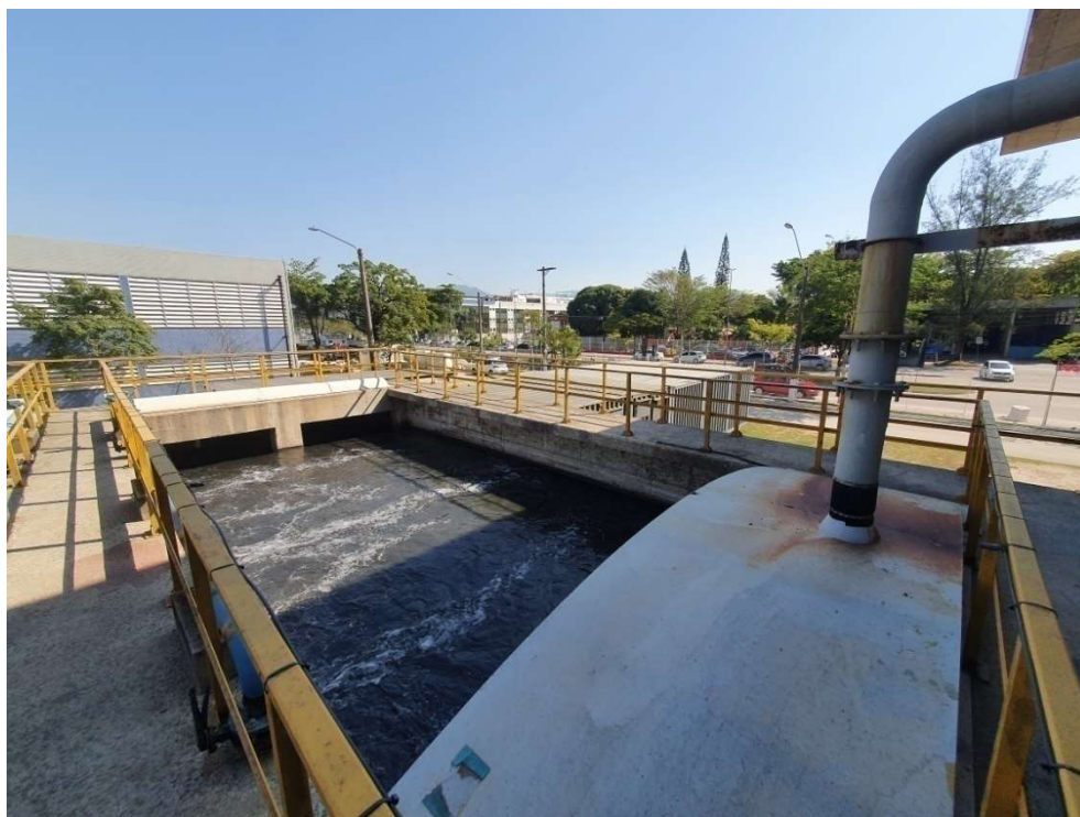
Foto 06 – Desarenador em operação
