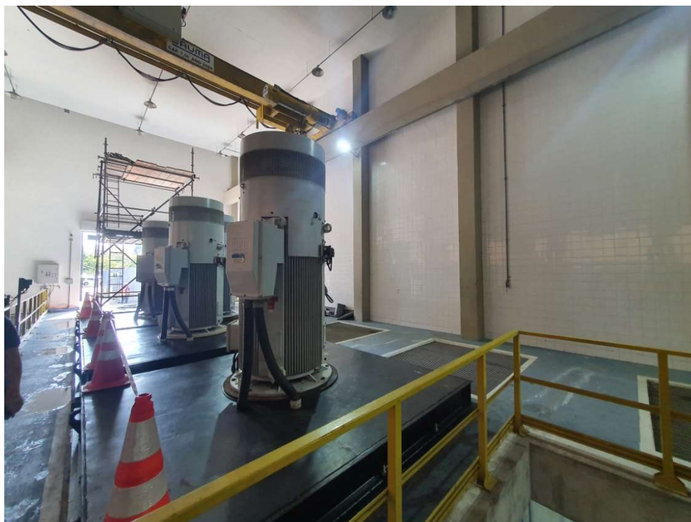
Foto 12 – Casa de bombas da elevatória final
