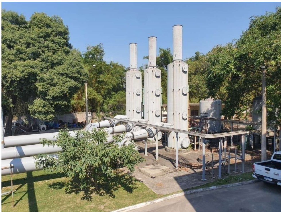
Foto 19 – Torre lavadora de gases
