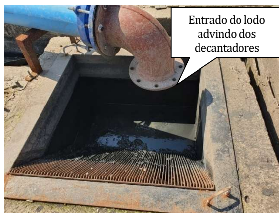
Foto 14 – Tanque de Lodo
