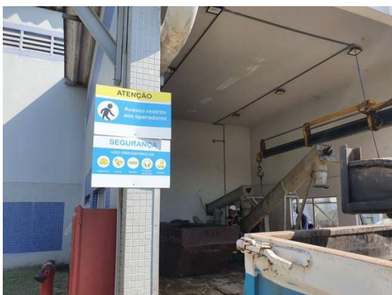
Foto 17 – Saída do lodo para caçamba
