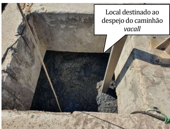
Foto 13 - Tanque de lodo
