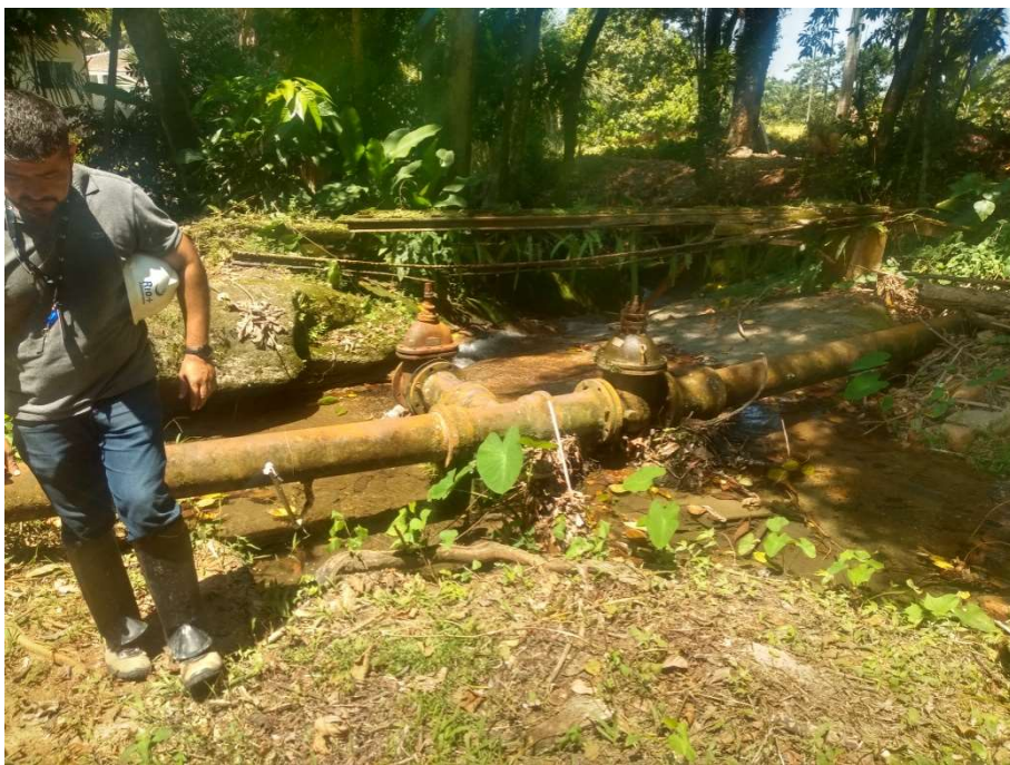
Tubulação de adução da captação Tachas
