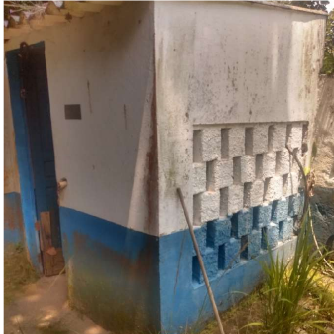
Depósito de produtos químicos situado na captação Andorinhas
