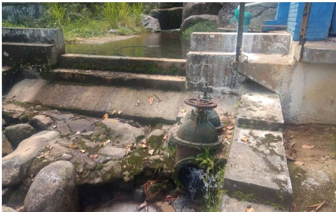
Barragem da captação Andorinhas e descarga de fundo
