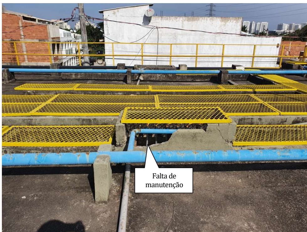
Foto 10 – Tanque de aeração
