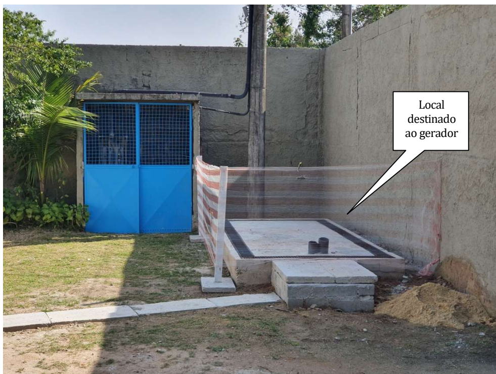
Foto 02 – Estação de Tratamento de Esgoto Vargem Grande
