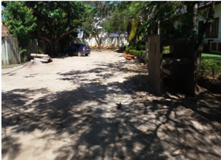
Foto 09 – Obras realizadas para implantação de Rede Separativa dentro do Condomínio Porto Belo
