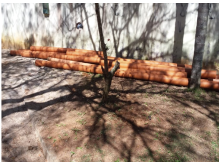
Foto 08 – Obras realizadas para implantação de Rede Separativa dentro do Condomínio Porto Belo
