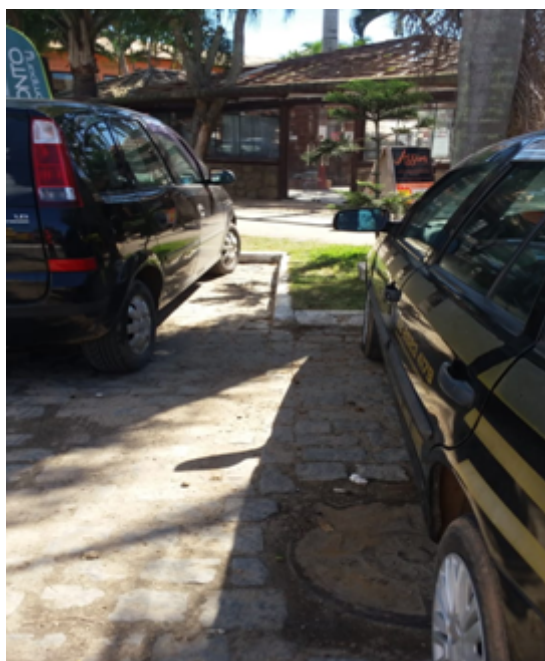
Foto 03 – Vista do PV de Águas Pluviais de outro ângulo
