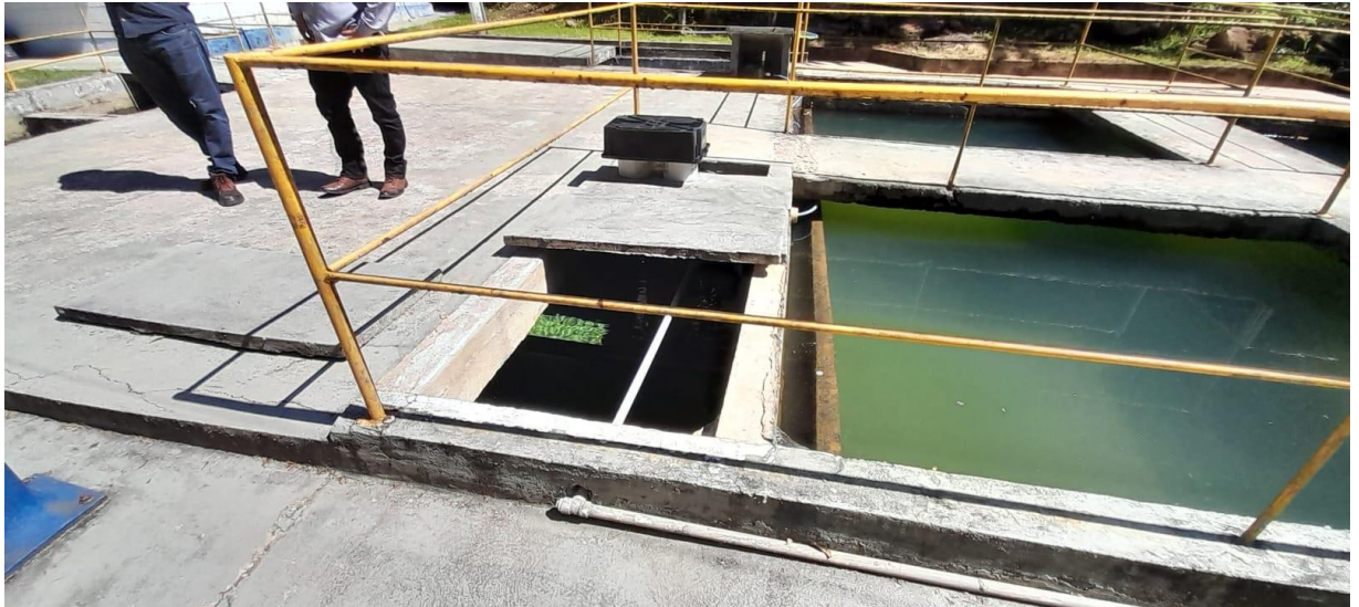
Tampas de Inspeção
