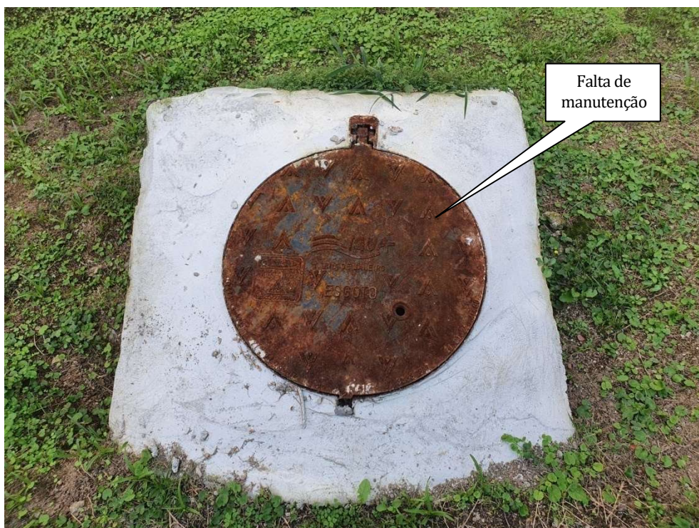
Foto 29 – PV de saída do efluente tratado
