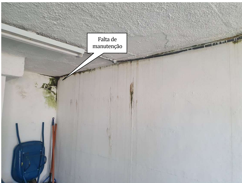
Foto 27 – Infiltração nas paredes da ETE
