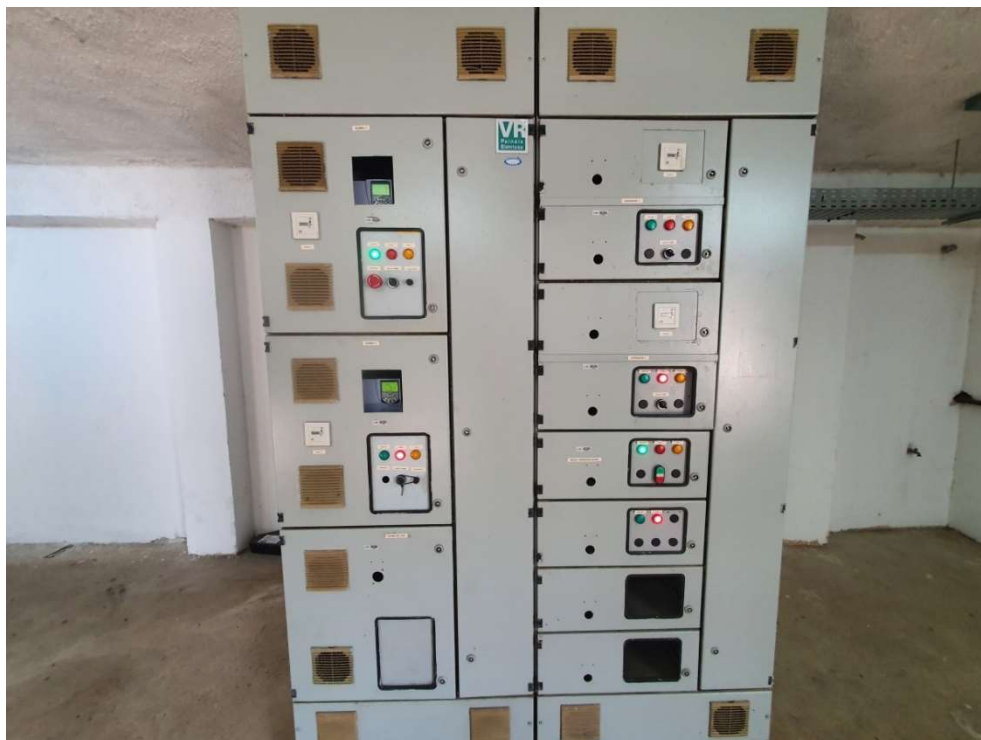
Foto 19 – Painel de comando
