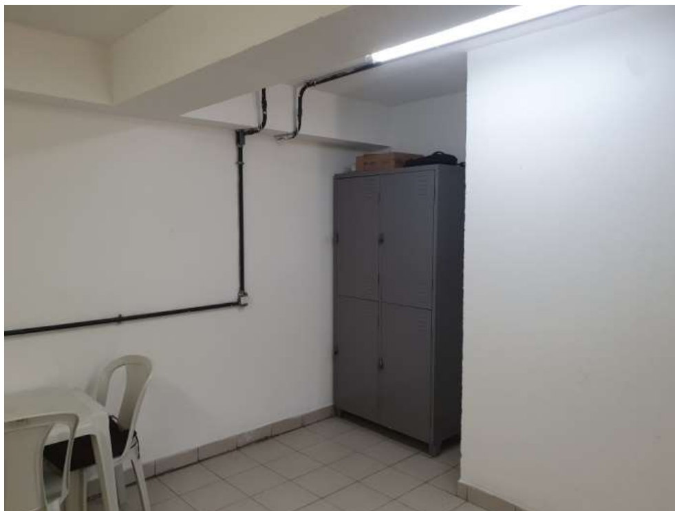
Foto 31 – Armário para operadores
