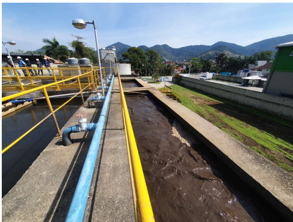
Foto 12 – Tanque de aeração
