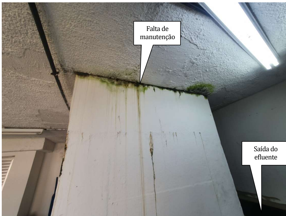
Foto 28 – Infiltração nas paredes da ETE
