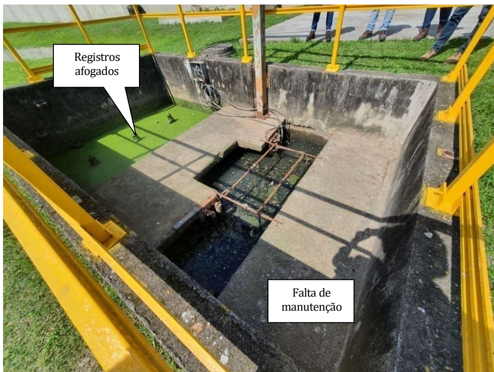
Foto 03 – Caixa de chegada
