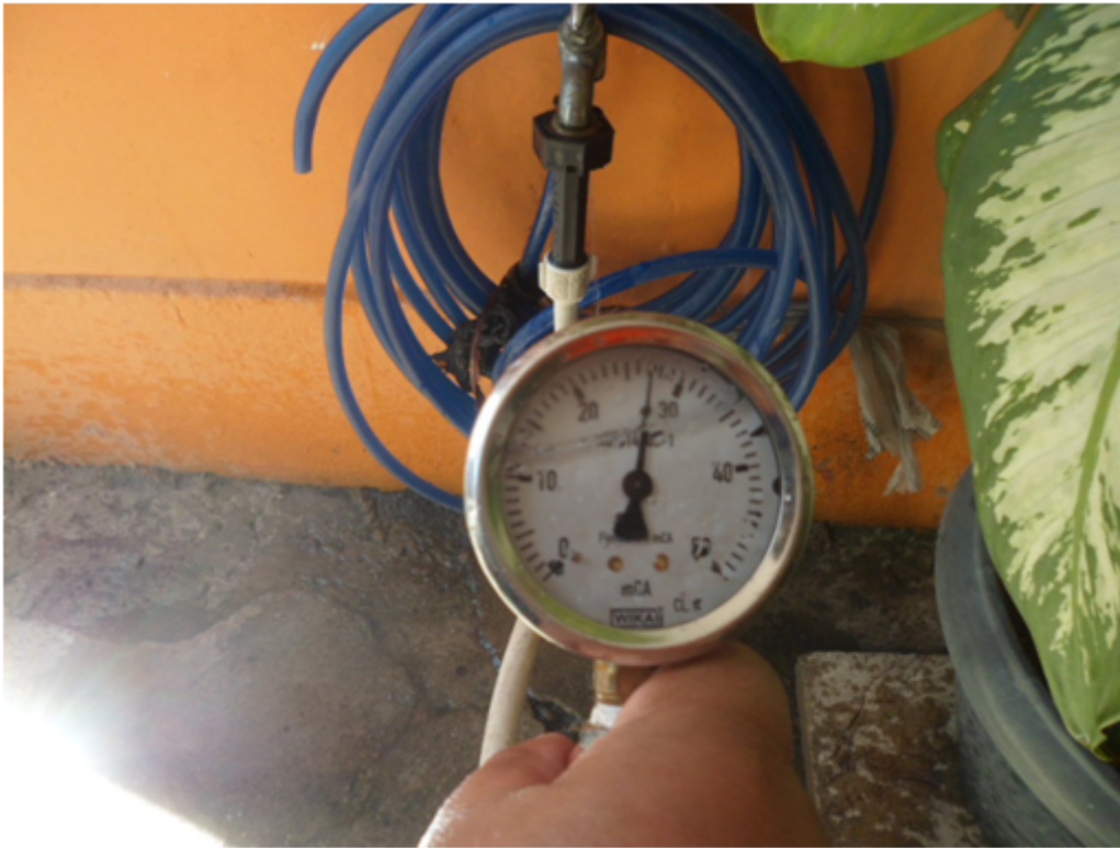
Foto 08 – Rua Tambaú – Manômetro com Pressão de 27 m.c.a.
