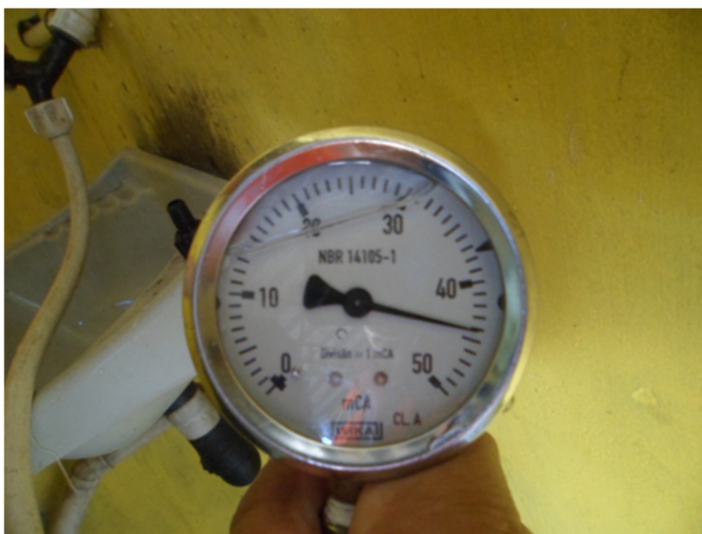
Foto 07 – Rua Marques de Oliveira – Manômetro com Pressão de 44 m.c.a.
