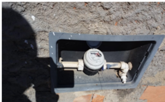
Foto 02 – Hidrômetro da residência
