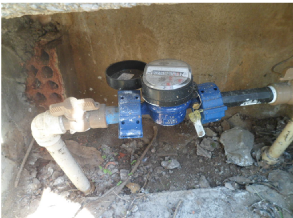
Foto 06 – Hidrômetro na Parte Interna do Terreno
