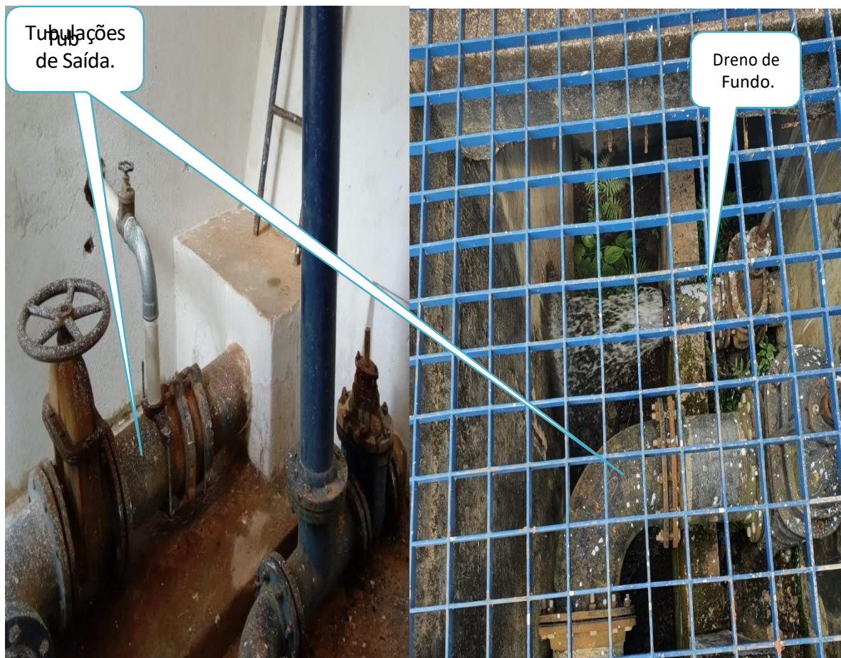
Tubulações de Saída 01 e 02.
