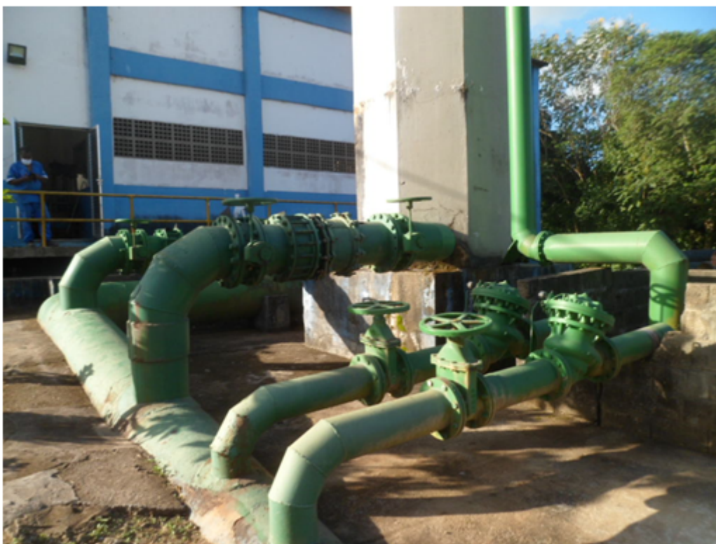
Foto 14 – Tubulações Interligadas a Adutora que Recalca para ETA Macaé
