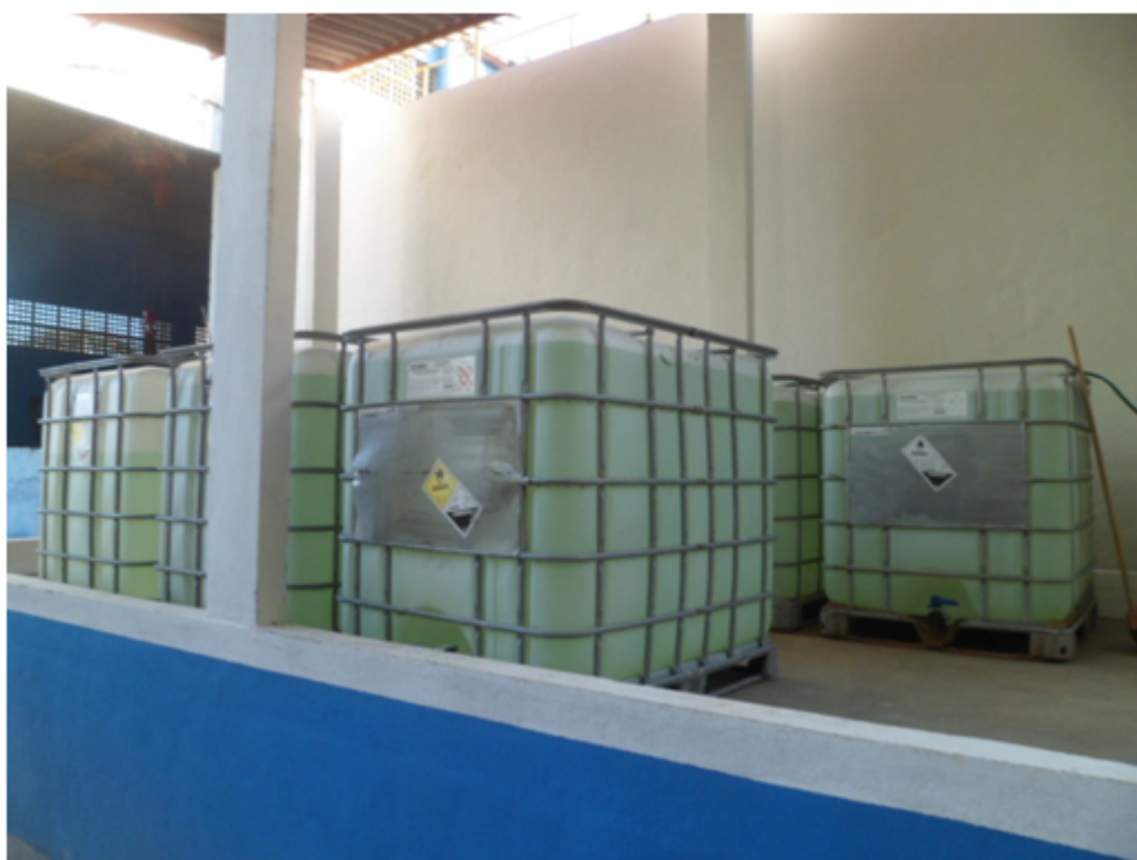
Foto 16 – Armazenamento de Material Químico (Peróxido de Hidrogênio)
