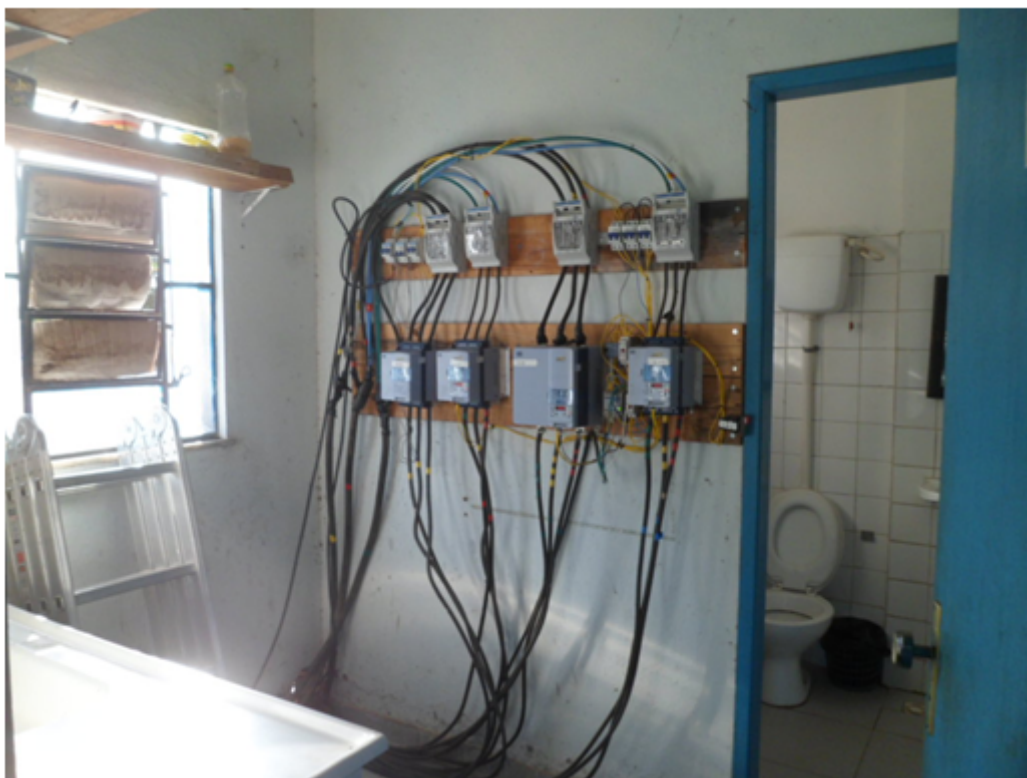
Foto 11 – Quadro Elétrico (Instalação Provisória)
