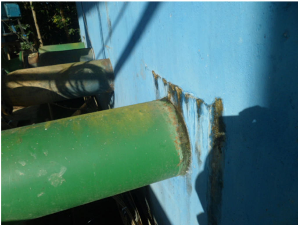
Foto 05 – Pontos de Infiltração no Tanque Desarenador
