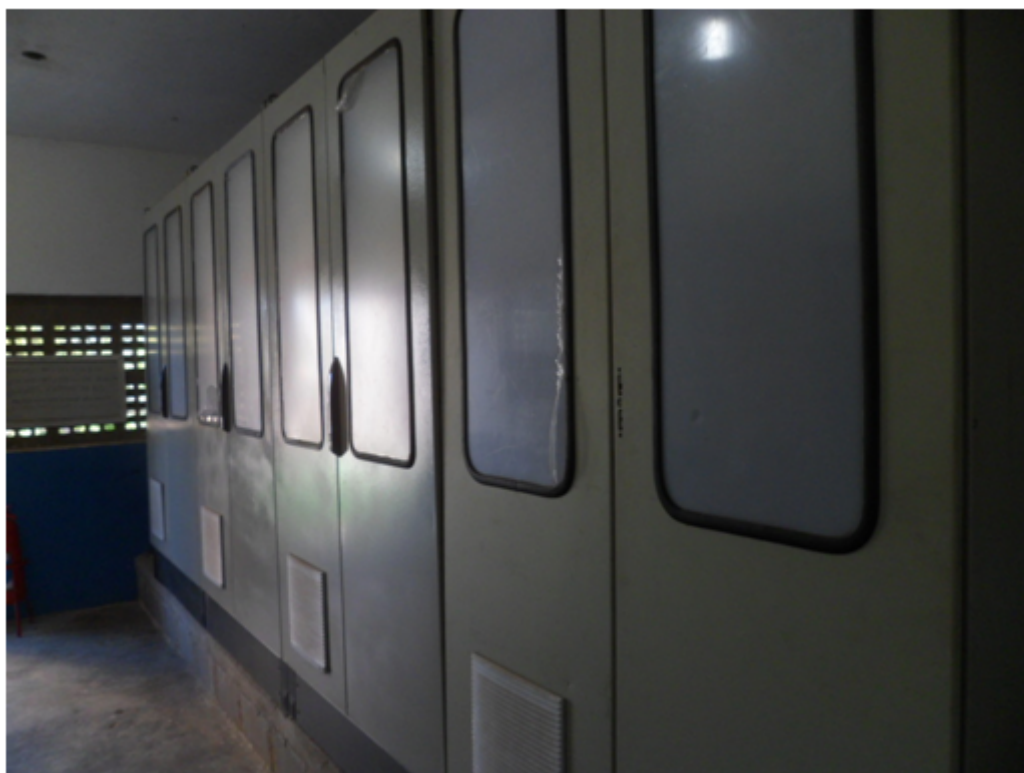
Foto 10 – Painel de Controle
