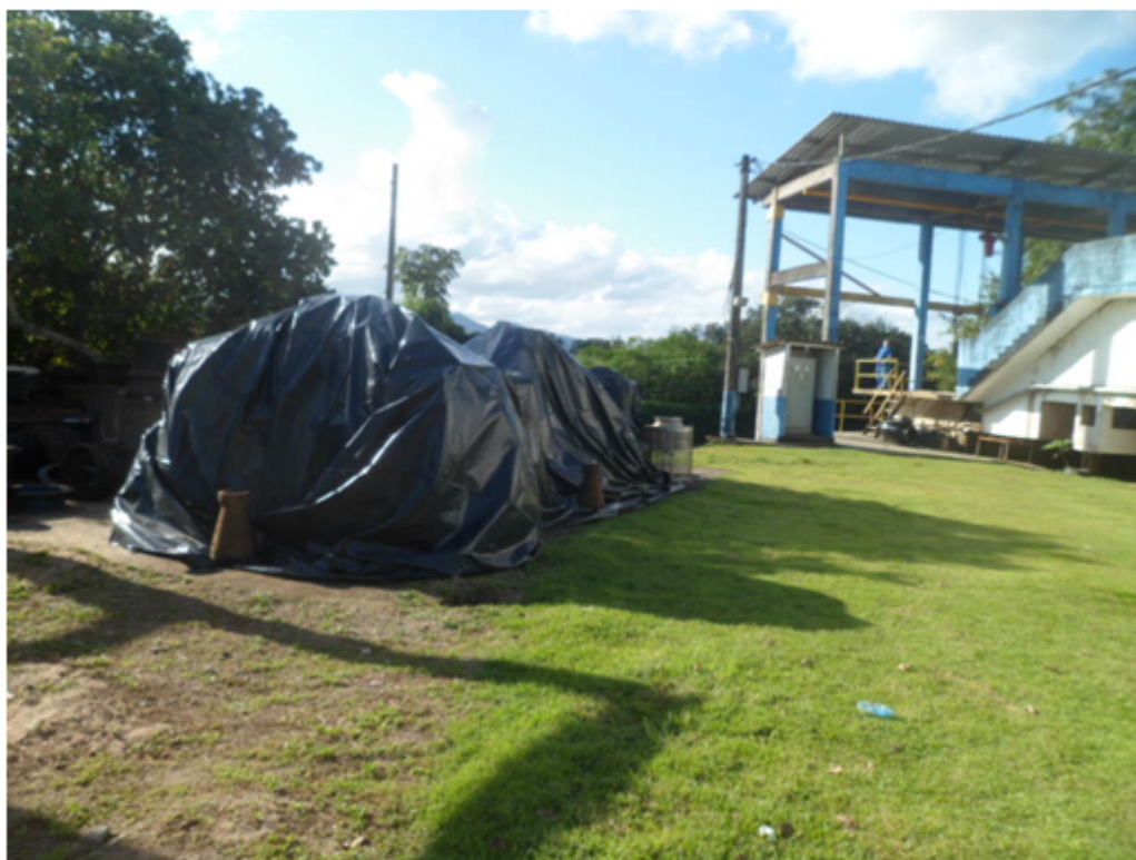
Foto 20 – 02 (dois) Transformadores de 1000 Kva, Reserva
