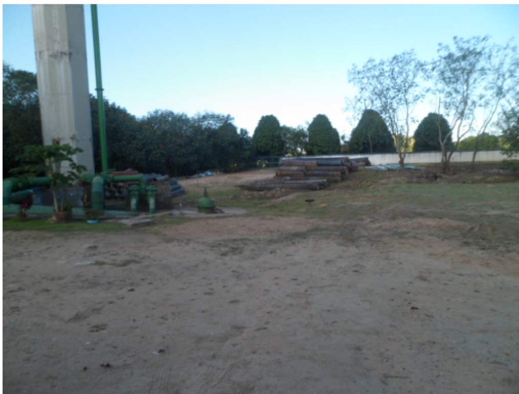
Foto 01 – Área Interna da Estação Elevatória de Água Bruta (EEAB) Macaé
