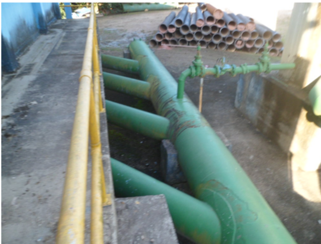
Foto 13 – Tubulações Advindas das Bombas do Alto Recalque para as Adutoras
