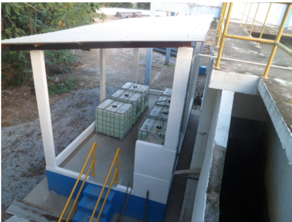
Foto 15 – Local de Armazenamento de Material Químico (Peroxido de Hidrogênio)
