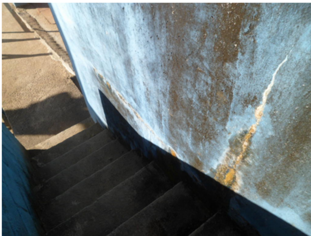
Foto 06 – Pontos de Infiltração na Escada de Acesso aos Desarenadores
