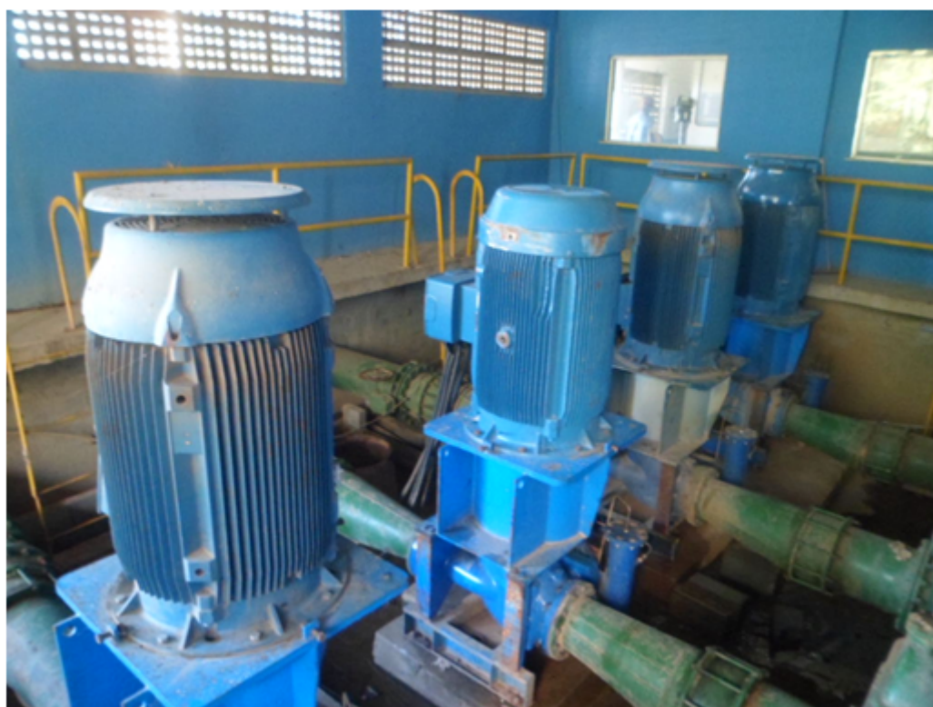
Foto 12 – 04 (quatro) Bombas do Alto Recalque
