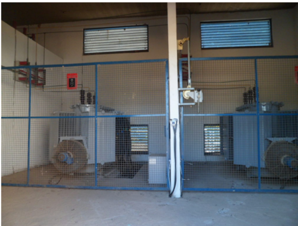
Foto 19– 02 (dois) Transformadores 900 Kva
