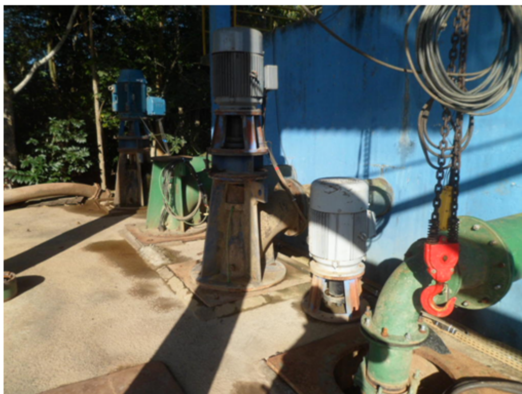
Foto 04 – Conjunto de 04 (quatro) Bombas, Baixo Recalque
