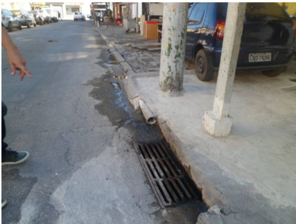
Foto 07 – Saída de Água das Casas para Rede Pluvial (lateral esquerda)
