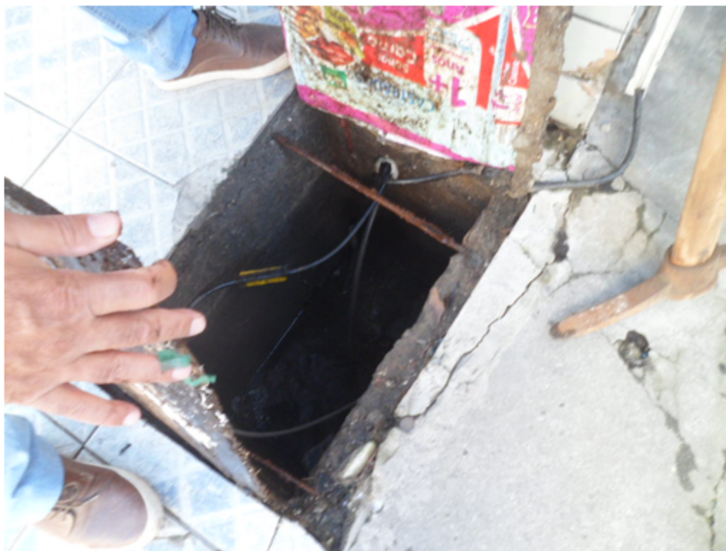
Foto 05 – Caixa de Passagem de Cabo de Energia
