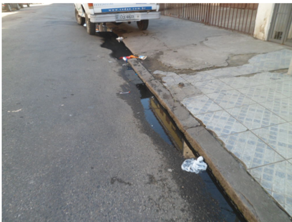
Foto 04 – Água Empoçada Próximo ao nº 888
