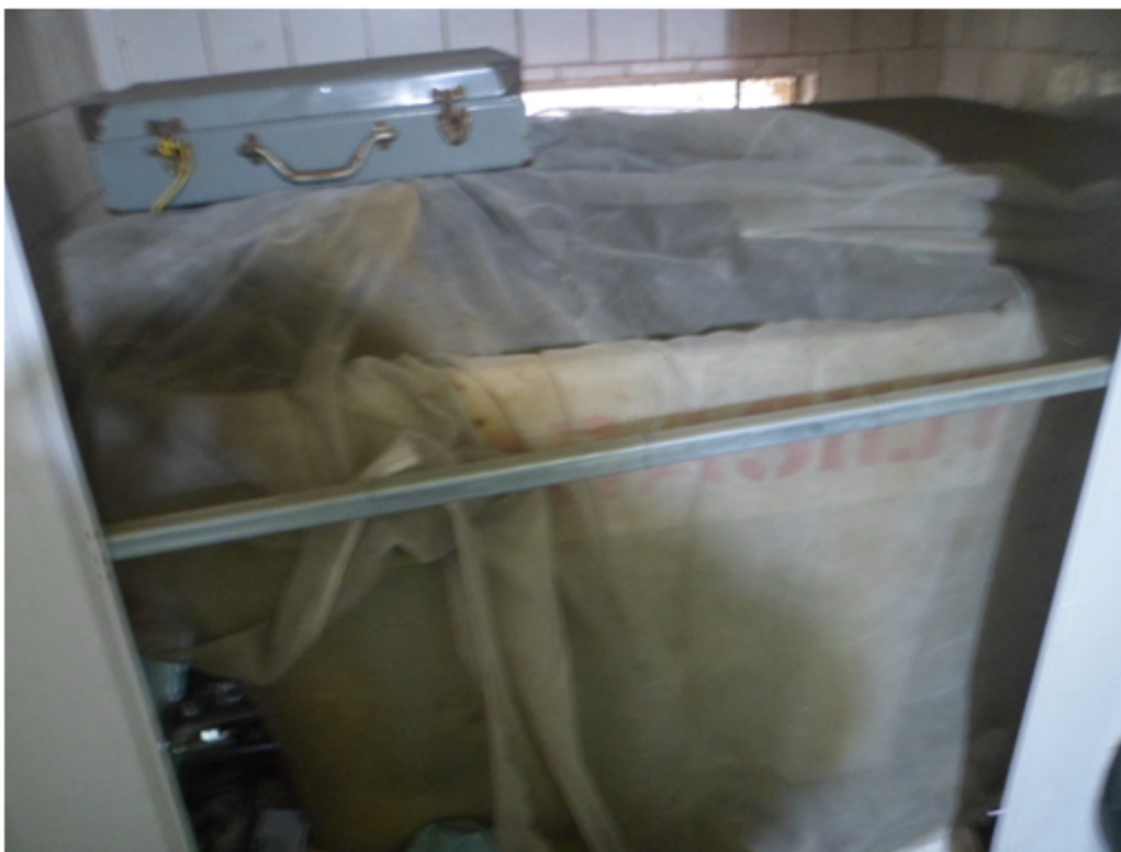
Foto 05 – Caixa D'Água de 1000 litros que Abastece as Lojas
