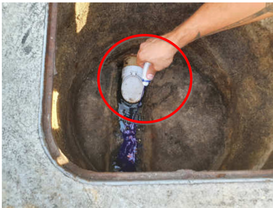
Foto 8 - Teste de corante na caixa de inspeção do morador
