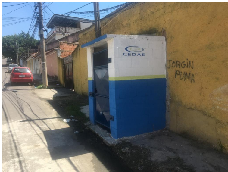
BOOSTER - VISTA GERAL
