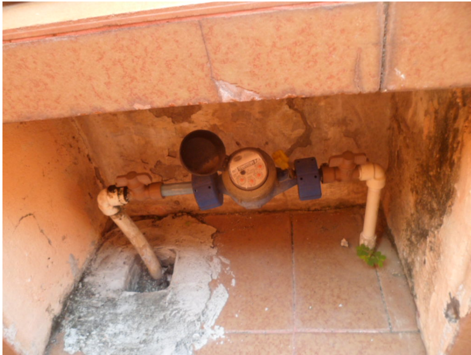
Foto 04 – Caixa do Hidrômetro
