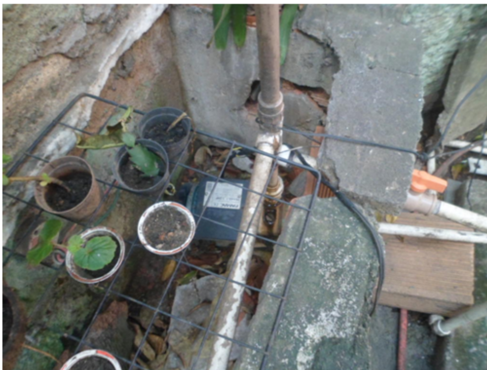
Foto 07 – Bomba D'Água da Residência do Sr. Isac
