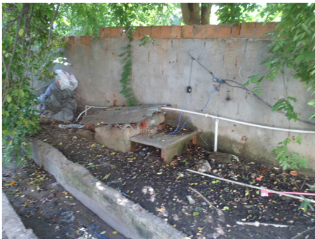
Foto 10 – Bomba D'Água Instalada pelos Meliantes - 03
