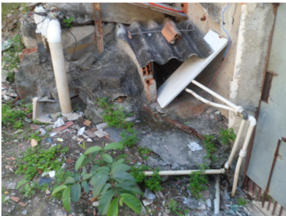
Foto 08 – Bomba D'Água Instalada pelos Meliantes - 01
