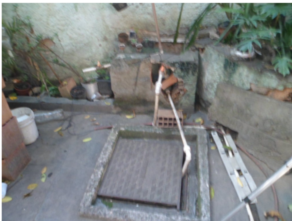
Foto 06 – Cisterna da Residência e Casa de Bomba
