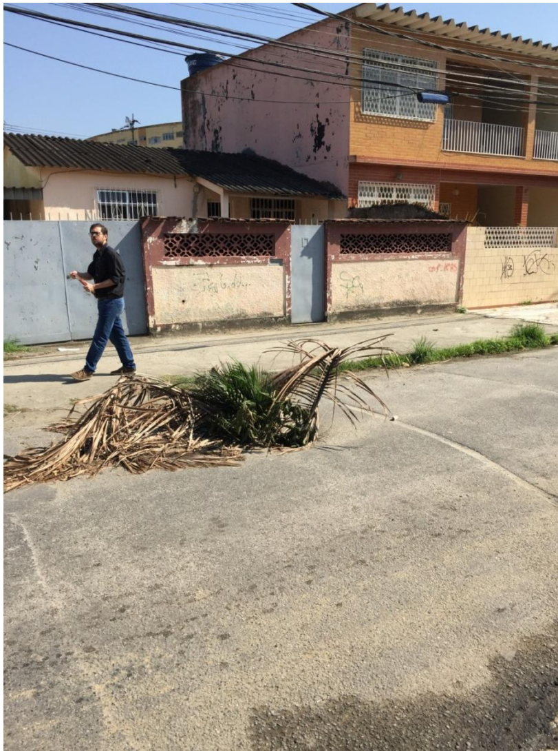
Afundamento da pista - Galeria de águas pluviais
