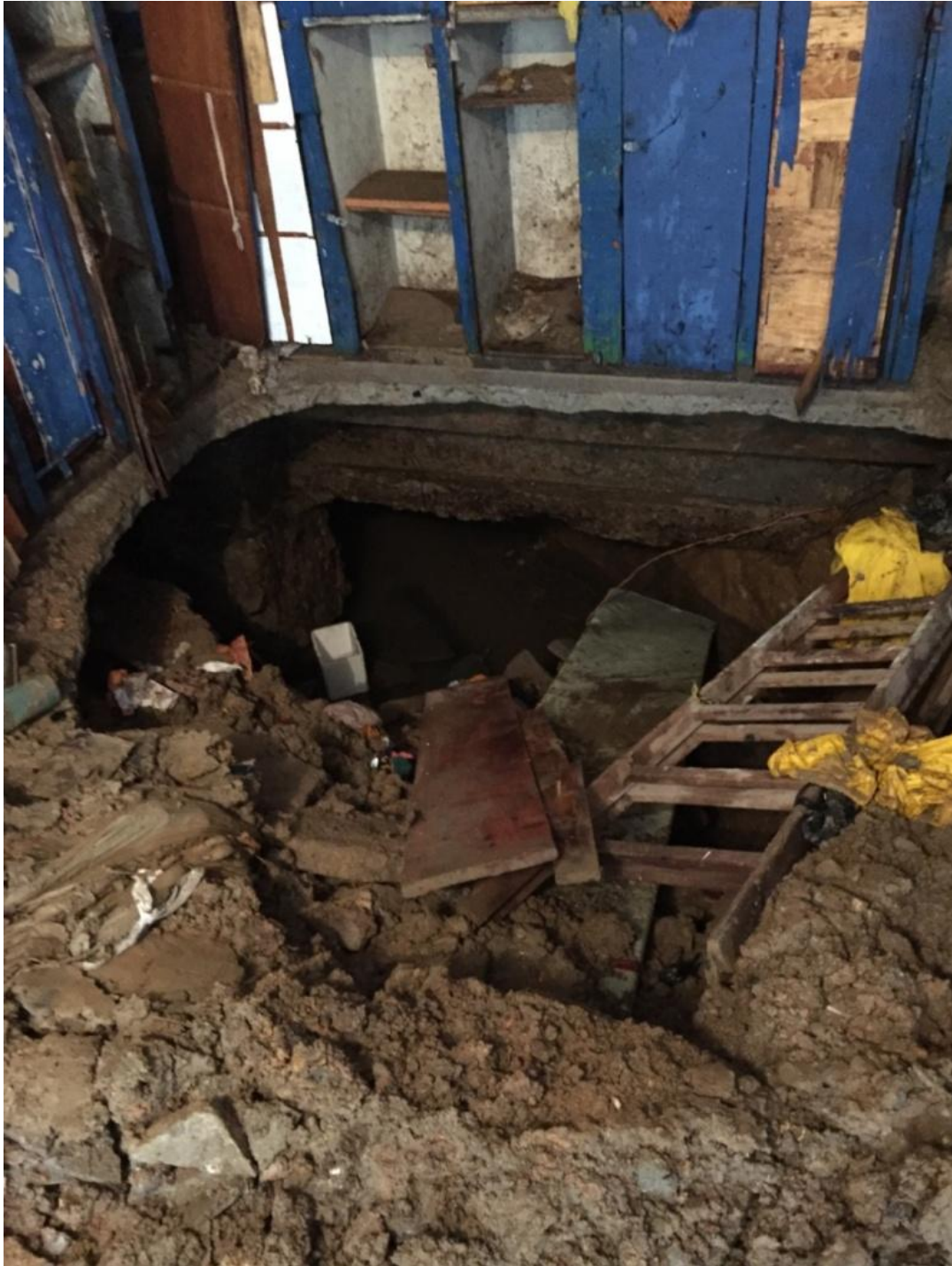
LOCAL DO ROMPIMENTO DA ADUTORA - VESTIÁRIO DOS FUNCIONÁRIOS DA 3ª GERENCIA DE CONSERVAÇÃO
