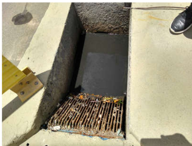
Foto 02 – Entrada do Esgoto Bruto e Gradeamento Grosso
