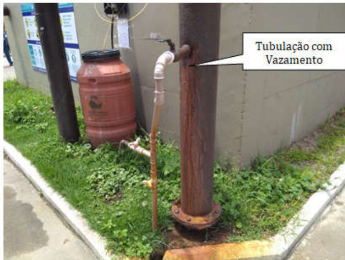
Foto 16 – Tubulação do Tanque de Contato com Vazamento
