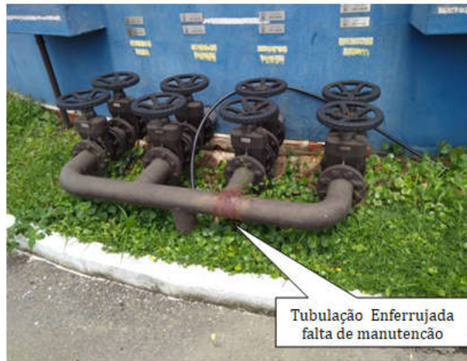
Foto 18 – Tubulação de Descarga do Lodo
