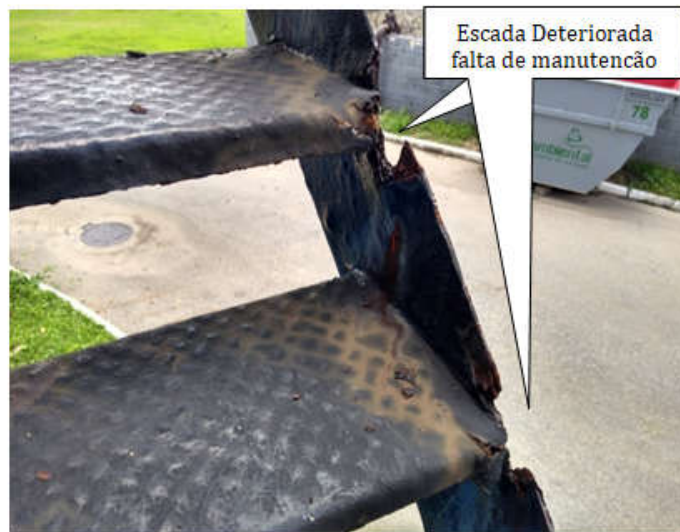
Foto 19 – Escada de Acesso ao Reator com degraus deteriorados
