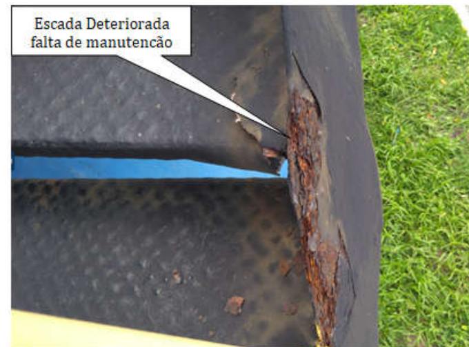
Foto 20 – Escada de Acesso ao Reator com degraus deteriorados
