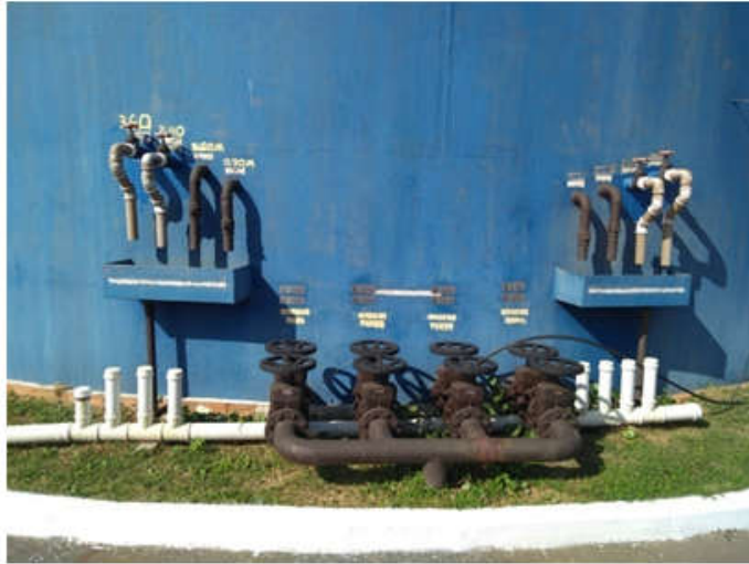
Foto 12 – Tubulações de Saída do Lodo
