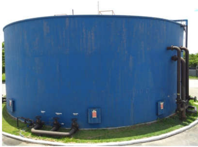
Foto 06 – Reator de Tratamento Biológico
