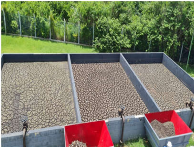
Foto 13 – Leito de Secagem do Lodo
