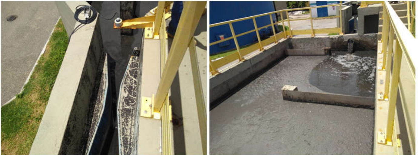
Foto 04 – Calha Parshall com Medidor de Vazão Ultrassônico e Caixa de Gordura
