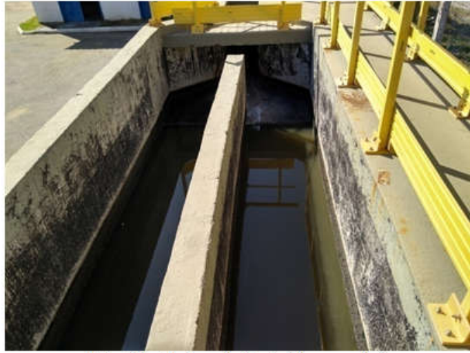
Foto 03 – Caixas de Areia (desarenador)
