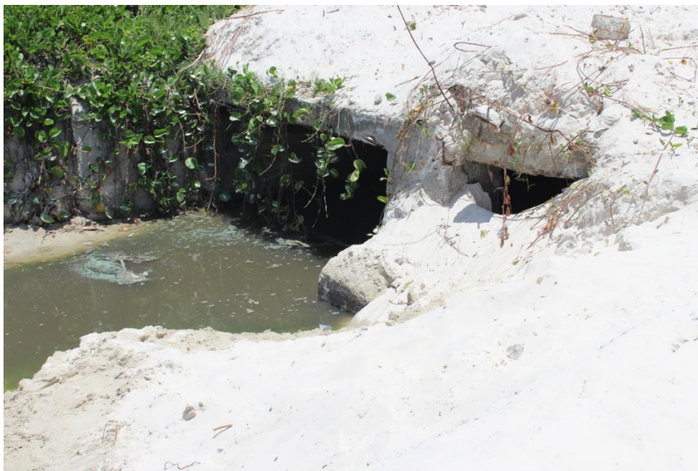
Foto 04 – Saída de água na praia dos Anjos sem fluxo de água
