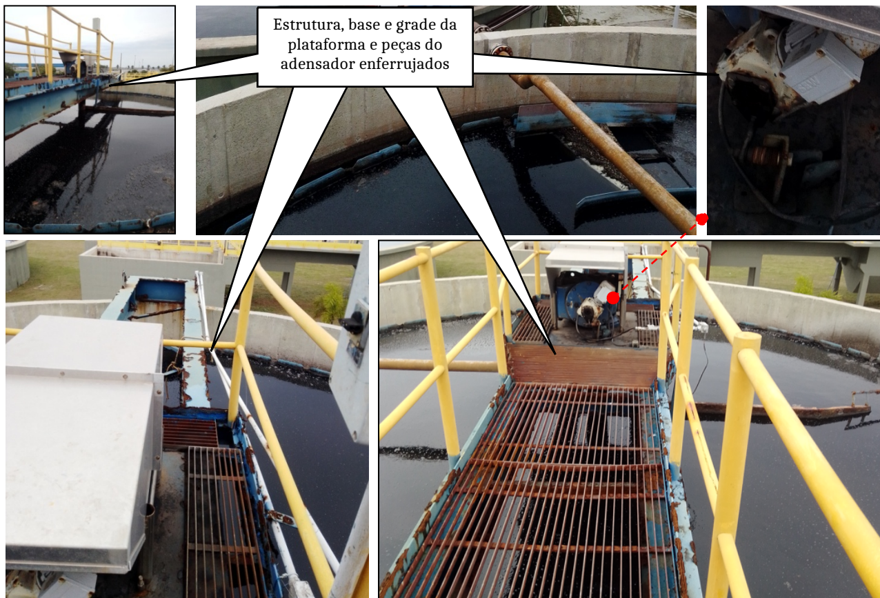
Figura 14 – Tanque adensador de lodo (vistas superiores). Destaque para corrosão estrutural
