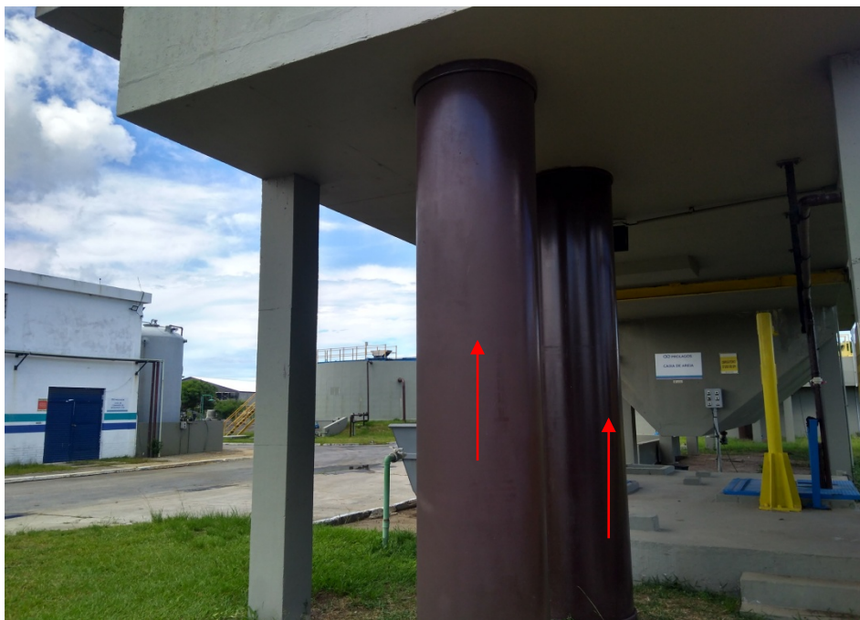
Figura 1 – Tubulações de entrada do esgoto bruto
