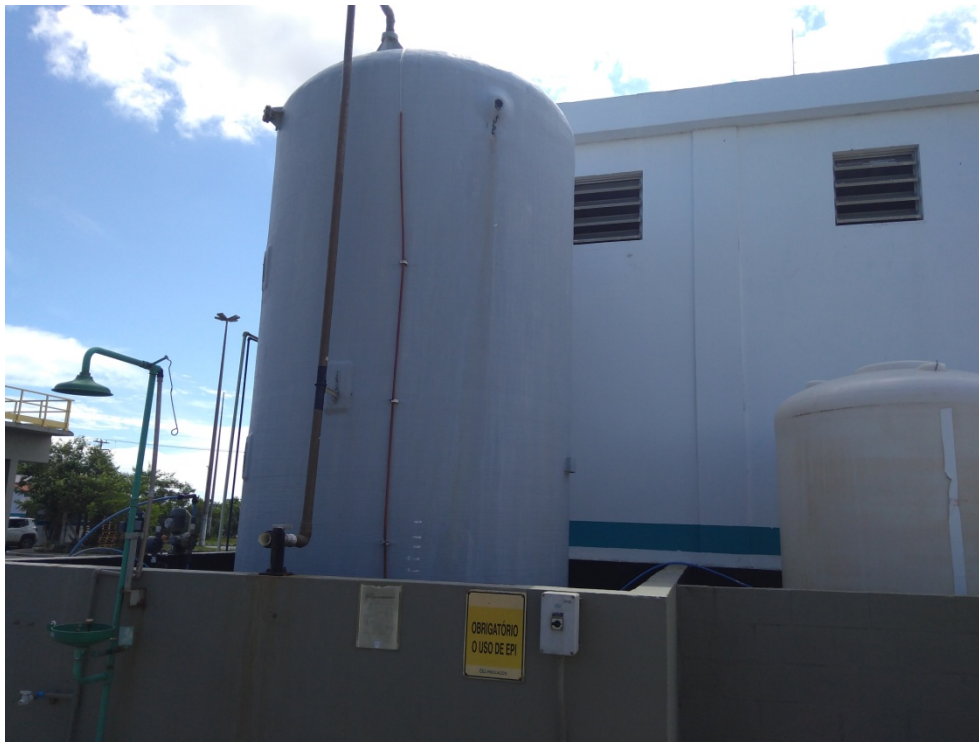
Figura 19 – Baías de contenção e armazenamento dos produtos químicos utilizados na ETE (Policloreto de Alumínio)
