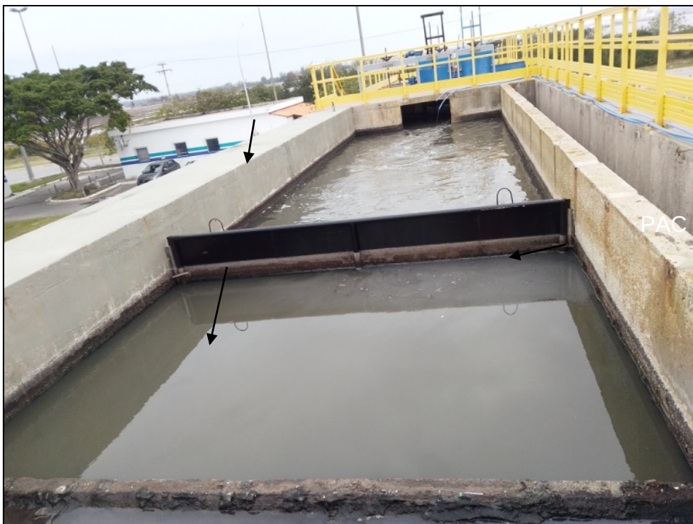
Figura 7 – Desarenador (Caixa de Areia)
