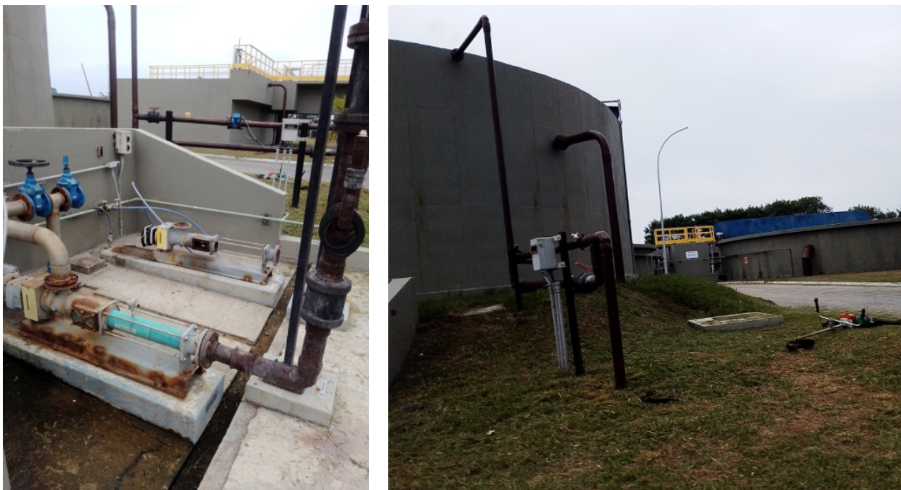
Figura 15 – Elevatória de lodo adensado e adensador (vista lateral). Observa-se a falta de uma bomba de lodo e que as bases, carcaças, tubos, conexões e válvulas estão enferrujados
