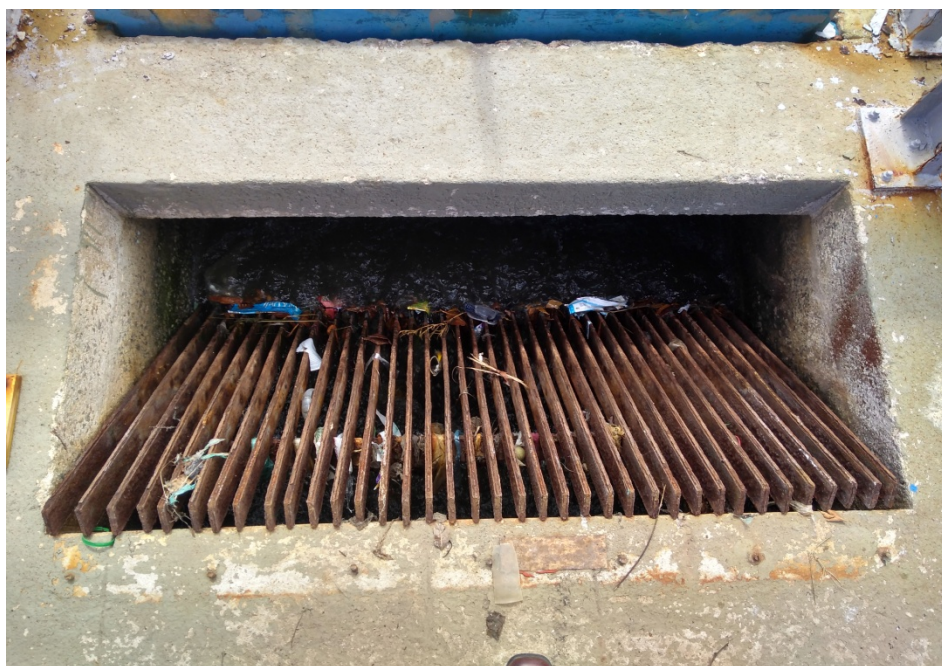
Figura 2 – Gradeamento de limpeza manual para retenção e retirada de resíduos sólidos
