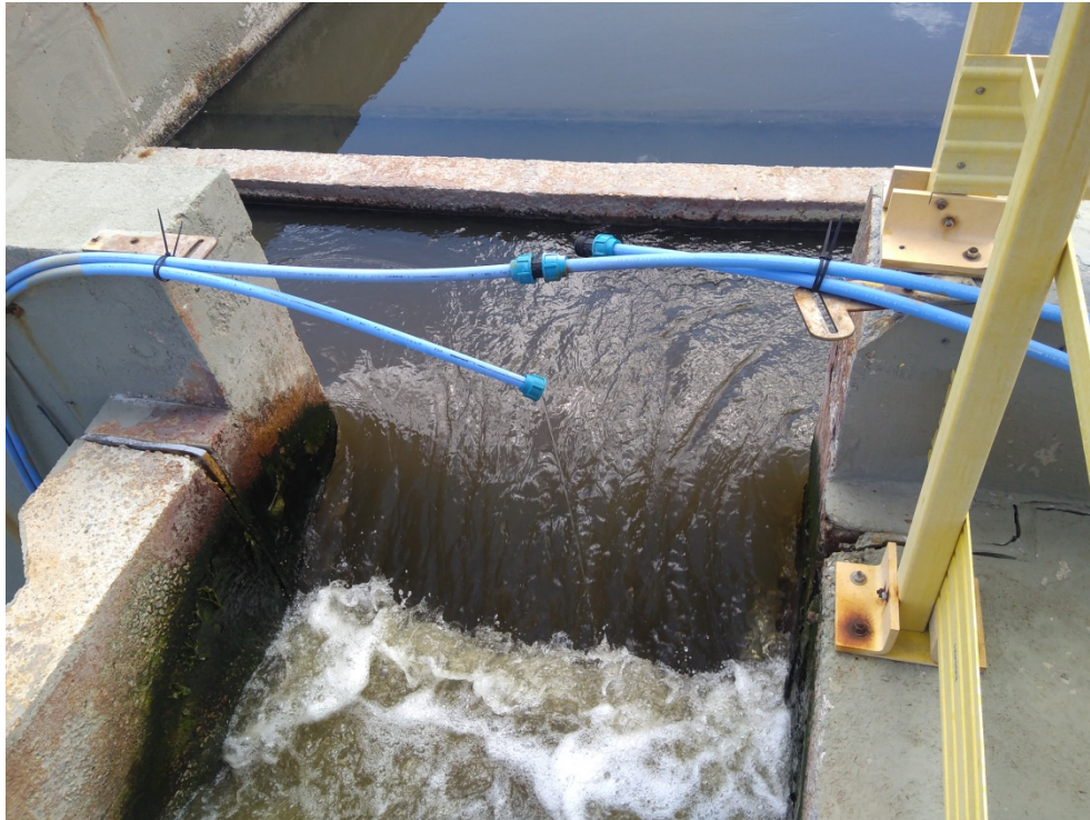
Figura 8 – Saída do desarenador (Caixa de Areia) e aplicação de PAC
