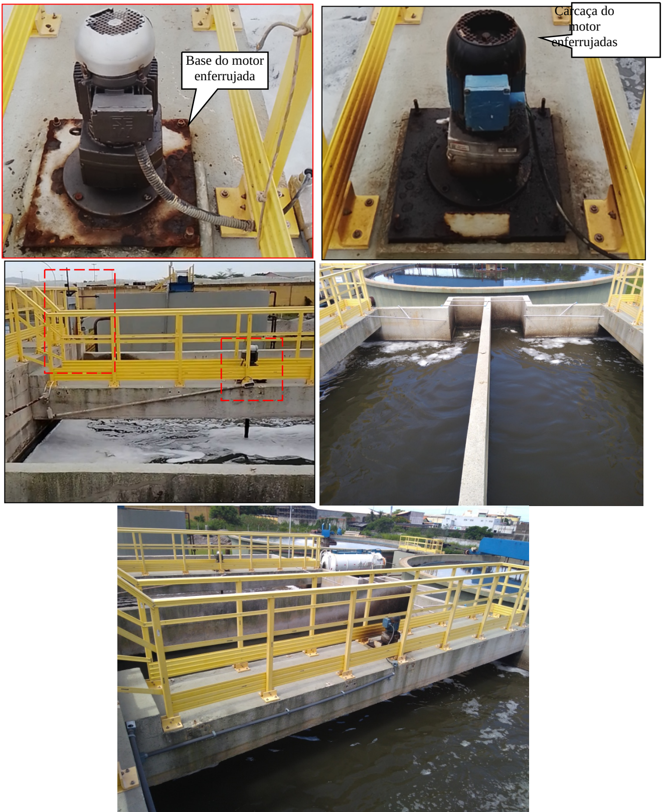
Figura 10 – Dois tanques de floculação (Floculadores) com um agitador mecânico cada. Destaque para as estruturas e peças com corrosão ( enferrujadas )
