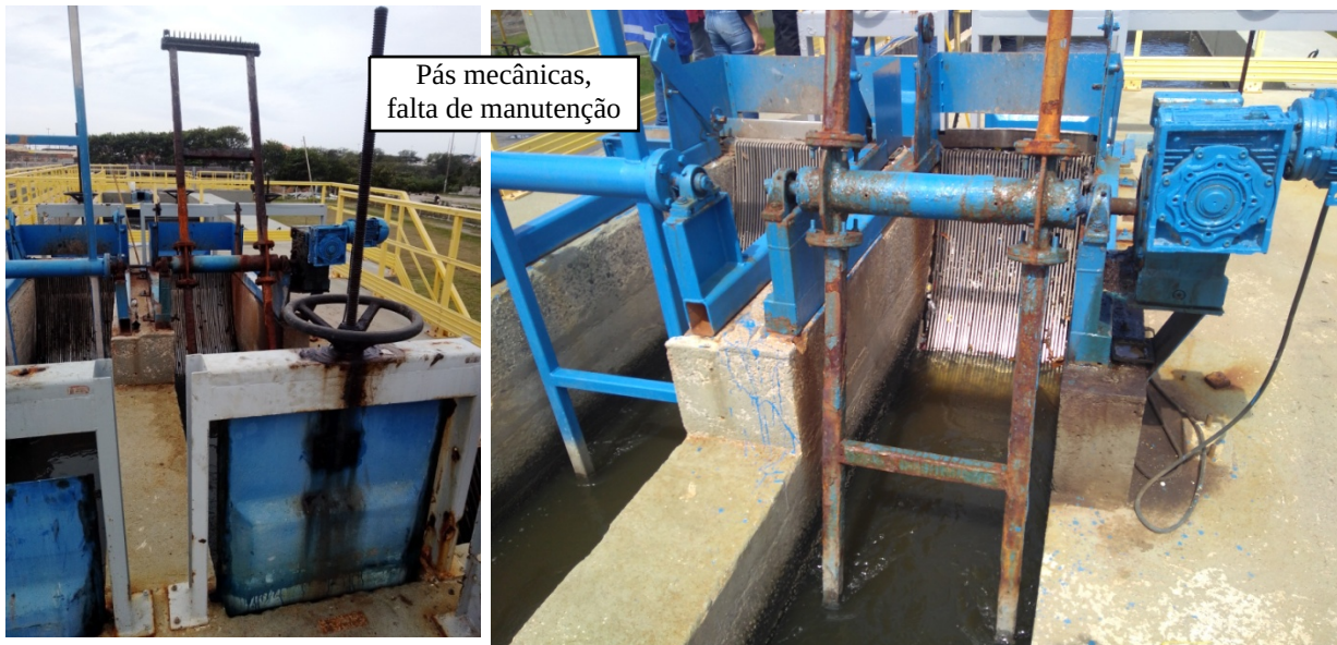
Figura 3 – Dois gradeamentos para retenção e retirada de resíduos, limpeza por pás mecânicas
