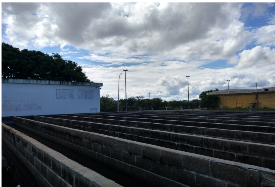
Figura 18 – Tanque de contato
