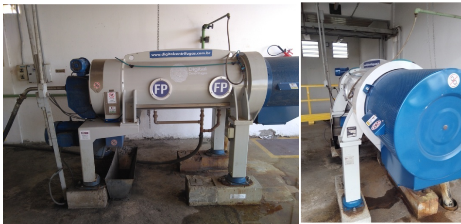
Figura 21 – Centrífuga para Desidratação de Lodo
