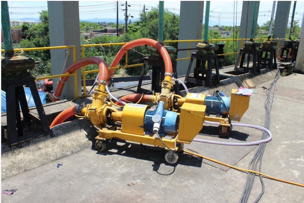
Bombas para o lançamento do Carvão Ativado
