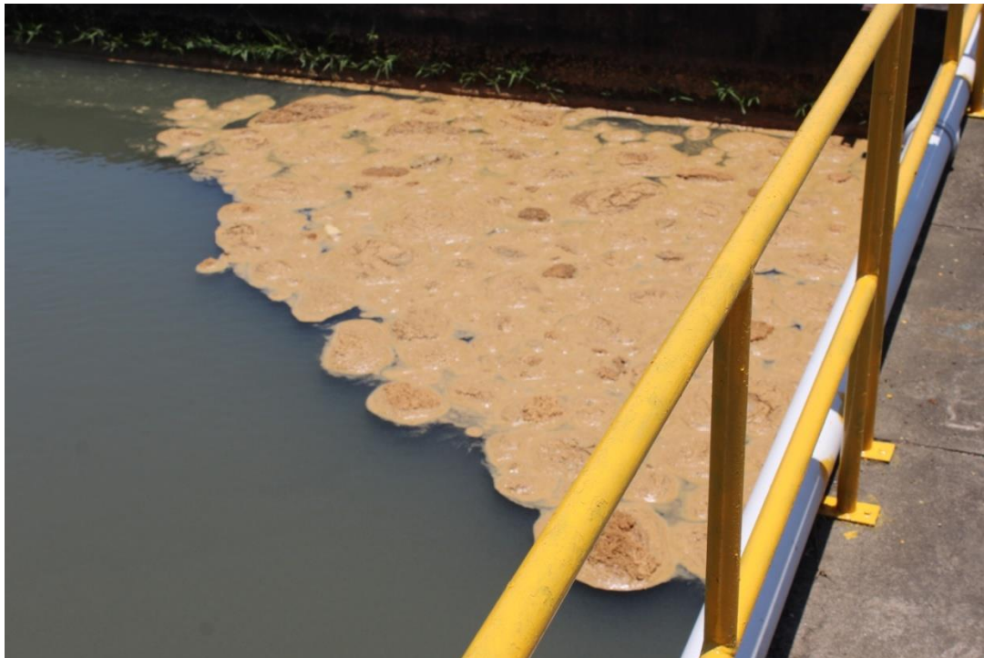
Tanque de Floculação
