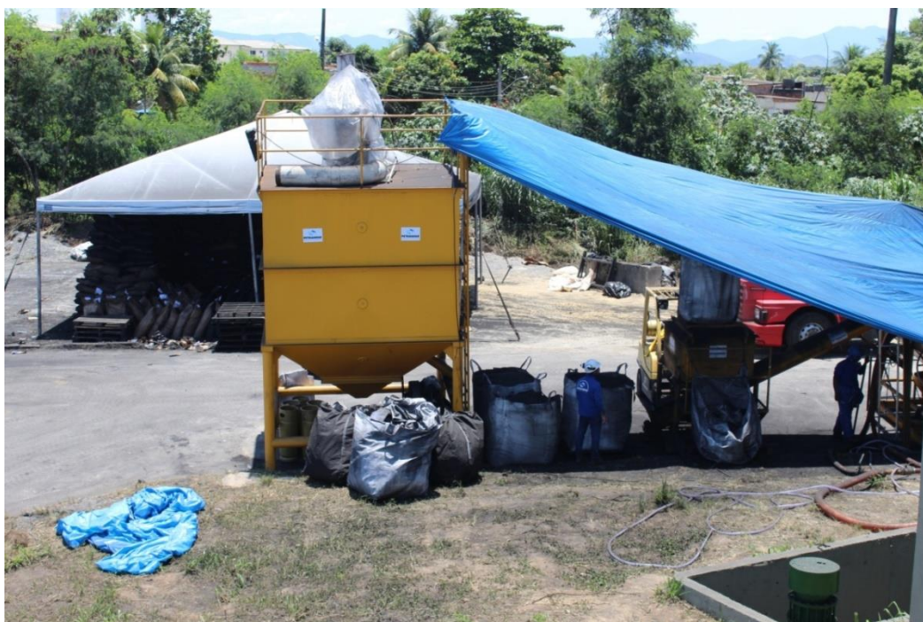
Equipamento de lançamento do Carvão Ativado (Funcionário sem Máscara)
