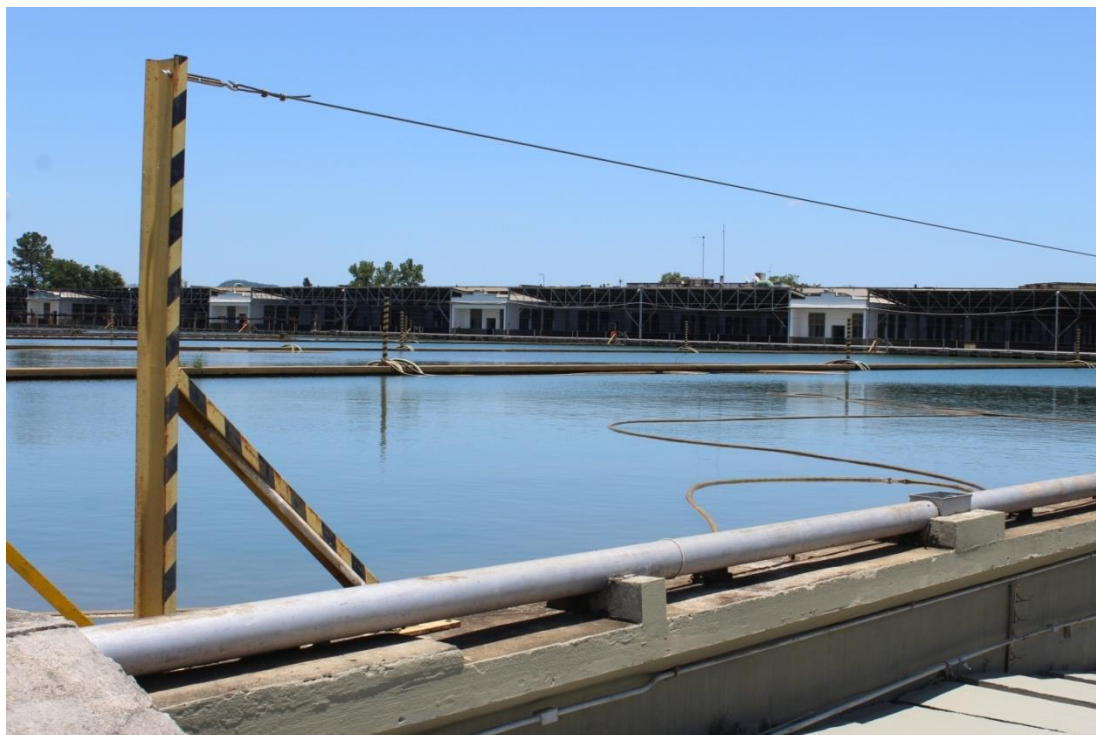
Tanque de Decantação
