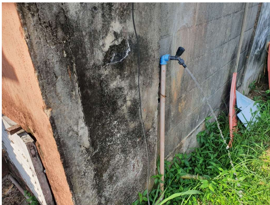
Foto 2 - Torneira na entrada do Condomínio
