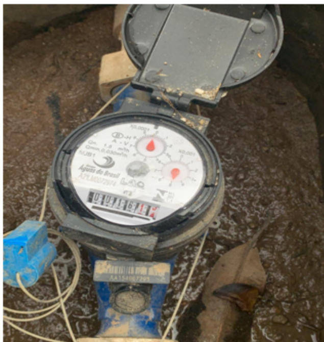
Hidrômetro indicando chegada de água na residência.
