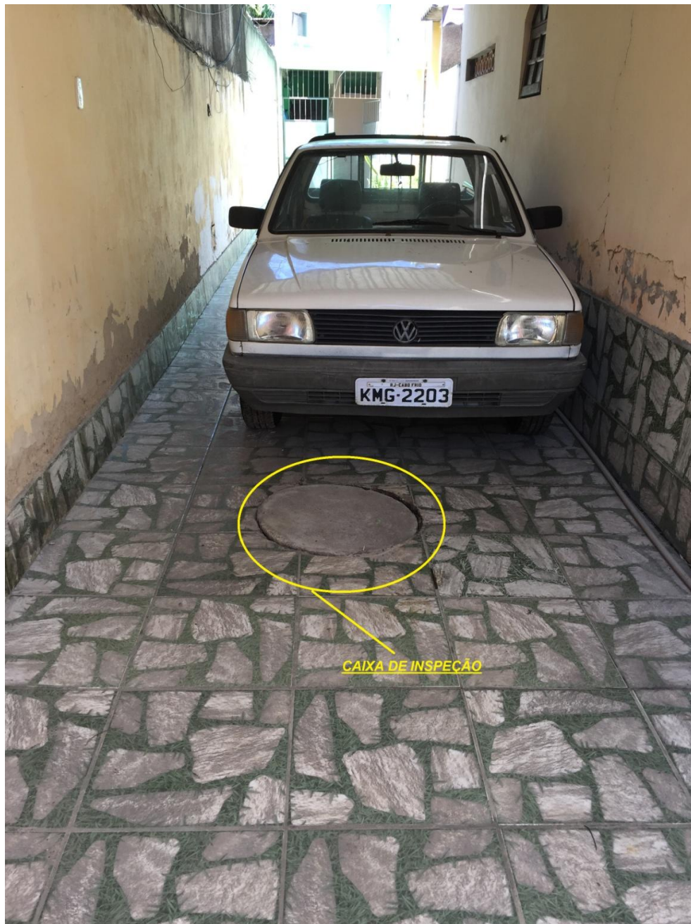
Caixa de Inspeção situada na garagem do Sr. Yvens de Freitas
