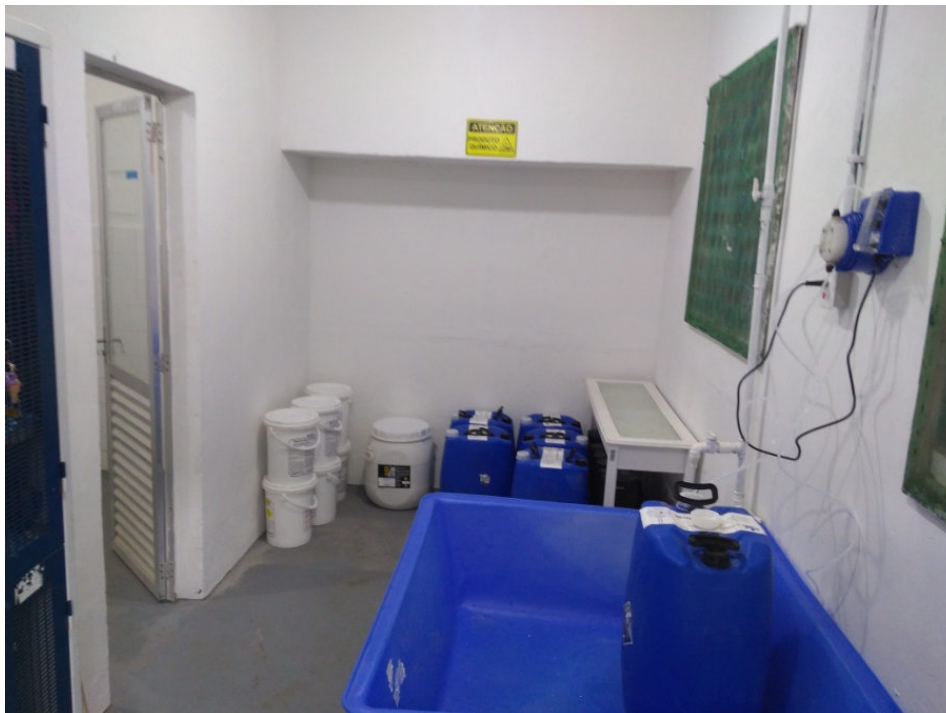
Depósito de produtos Químicos (Hipoclorito de Cálcio e Flúor)
