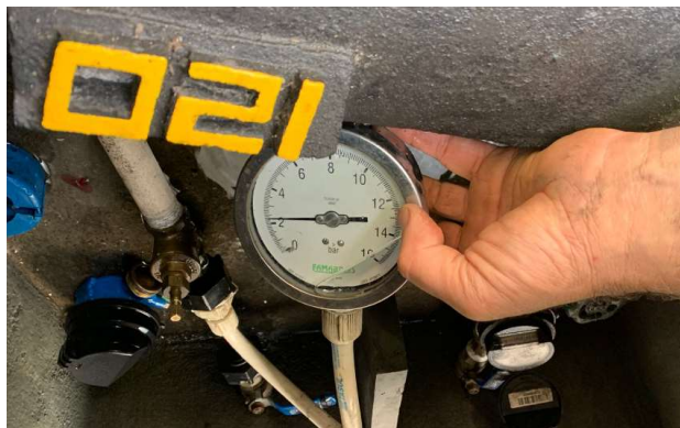
Manômetro instalado na residência nº 120 mostrando pressão de 24 m.c.a.
