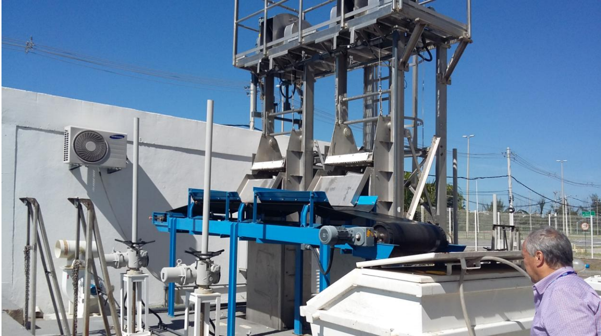
ESTRUTURA DE ENTRADA - GRADES MECANIZADAS
