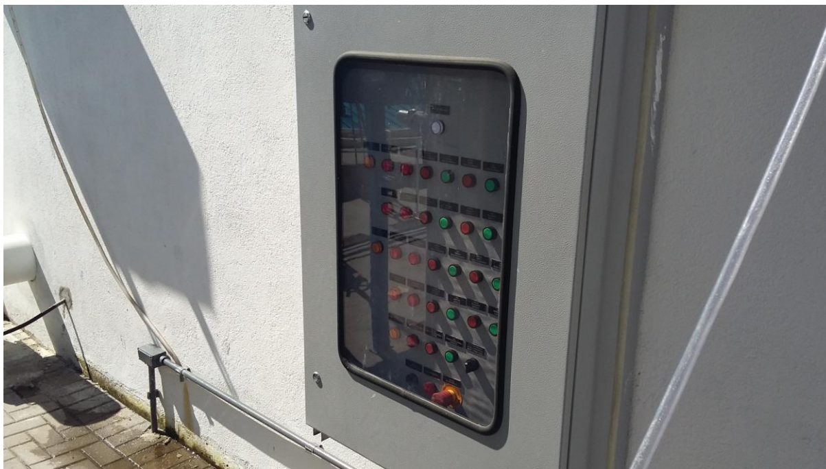
GRADE MECANIZADA - QUADRO DE COMANDO
