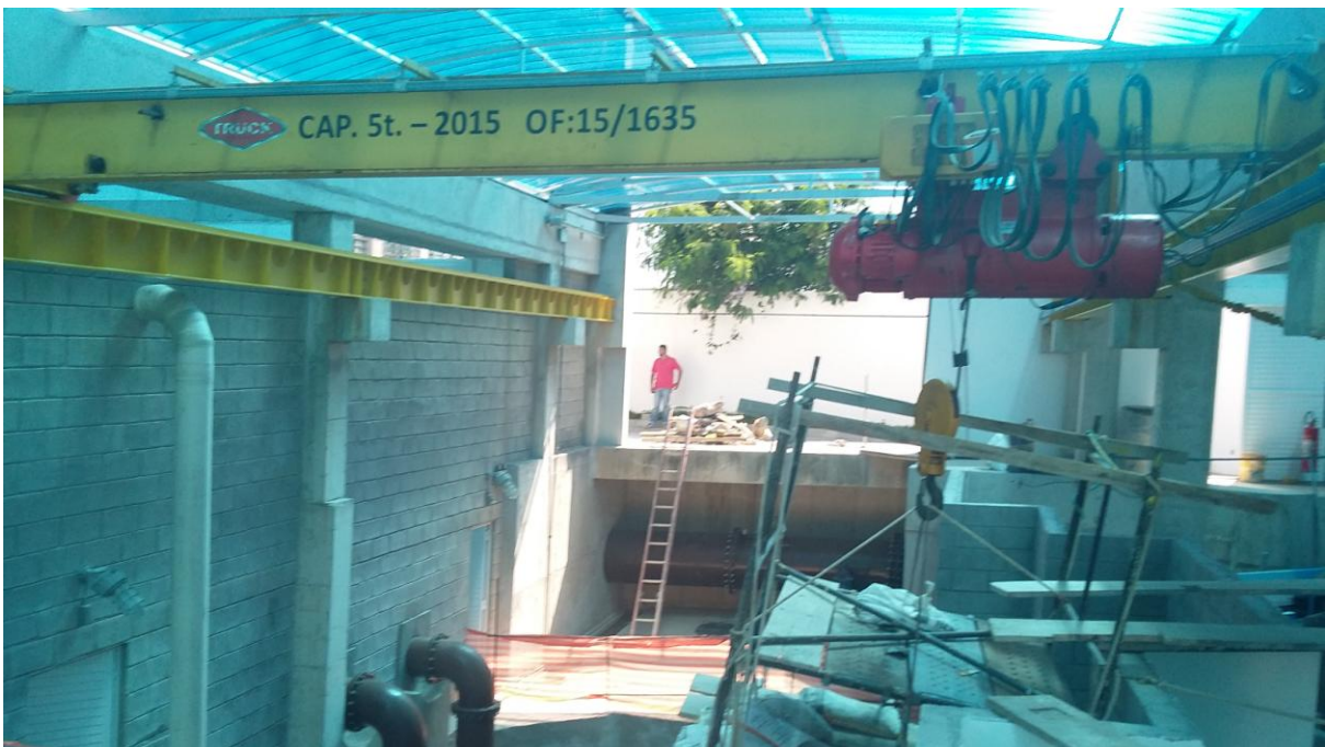
PONTE ROLANTE COM TROLLEY
