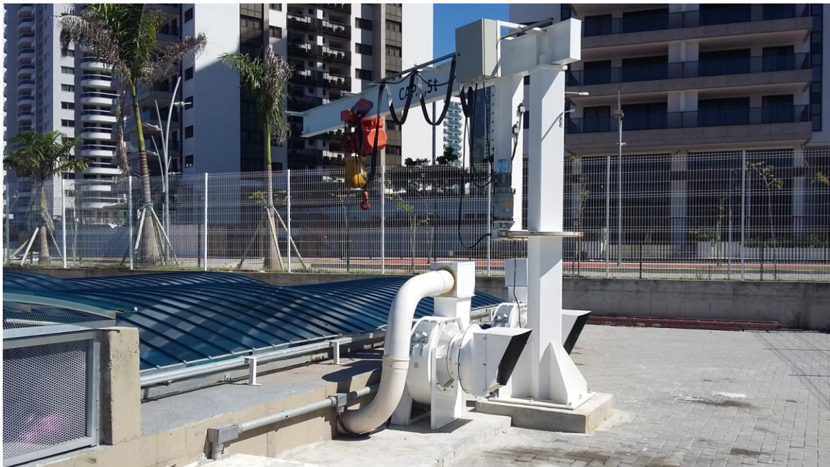
PÓRTICO COM TALHA ELÉTRICA
