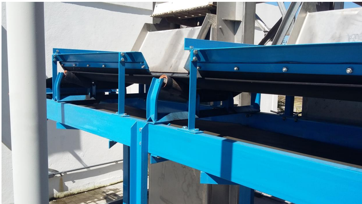
GRADE MECANIZADA - SISTEMA COLETOR DE RESÍDUOS (ESTEIRA)
