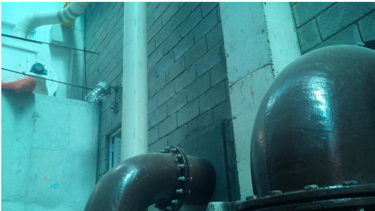
SISTEMA DE EXAUSTÃO DE GASES
