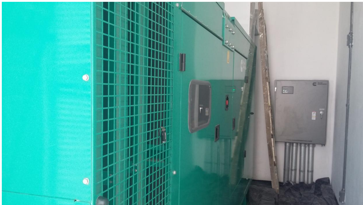
GRUPO GERADOR (EMERGÊNCIA)
