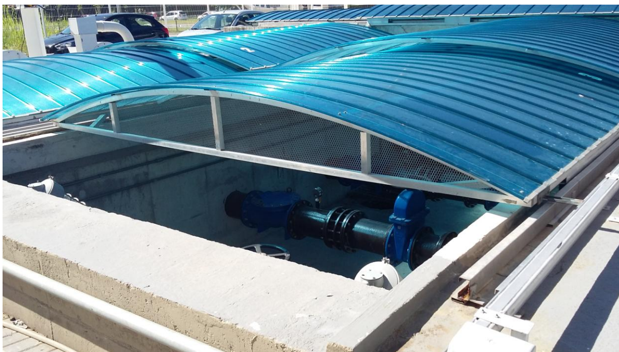
COBERTURA RETRÁTIL DO BARRILETE DE SUCCÃO- SISTEMA ACIONADO POR CONTROLE
