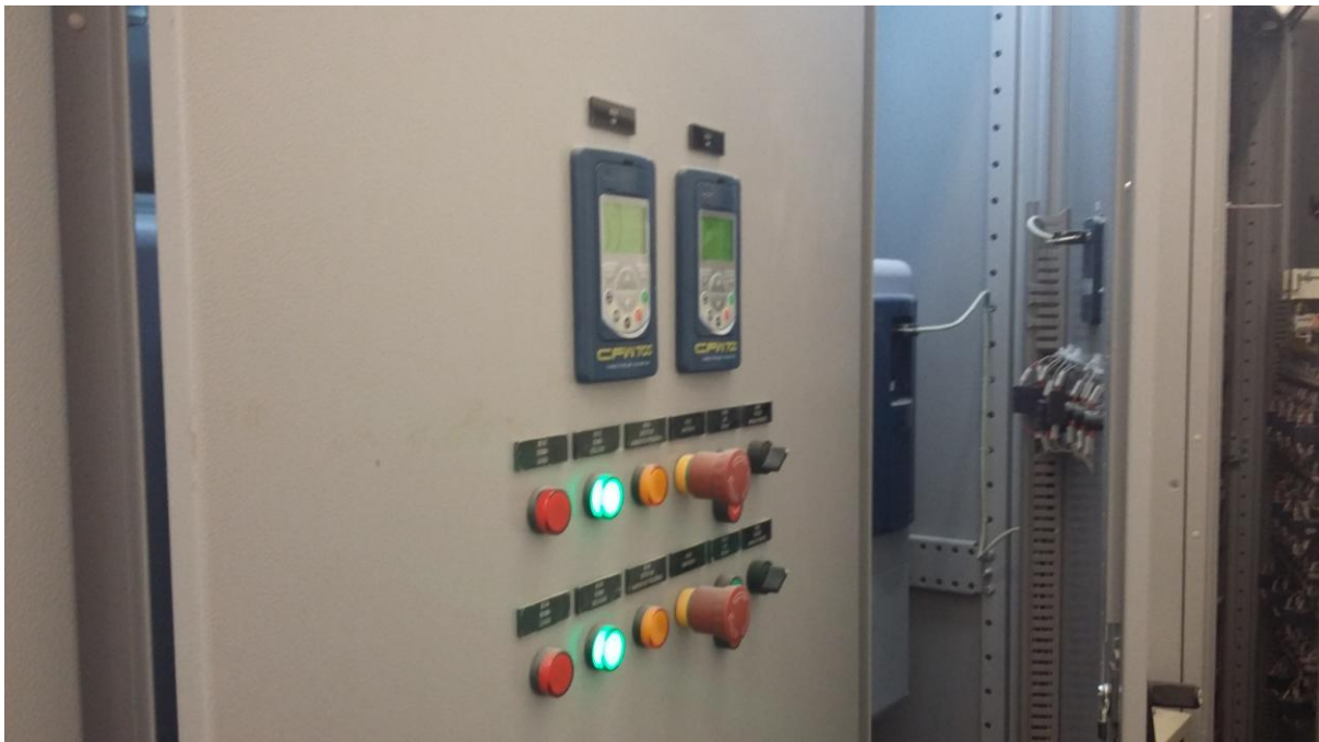
QUADRO DE COMANDO
