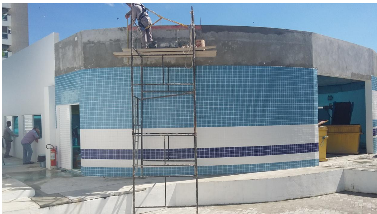
ESTAÇÃO ELEVATÓRIA OLÍMPICA - VISTA GERAL
