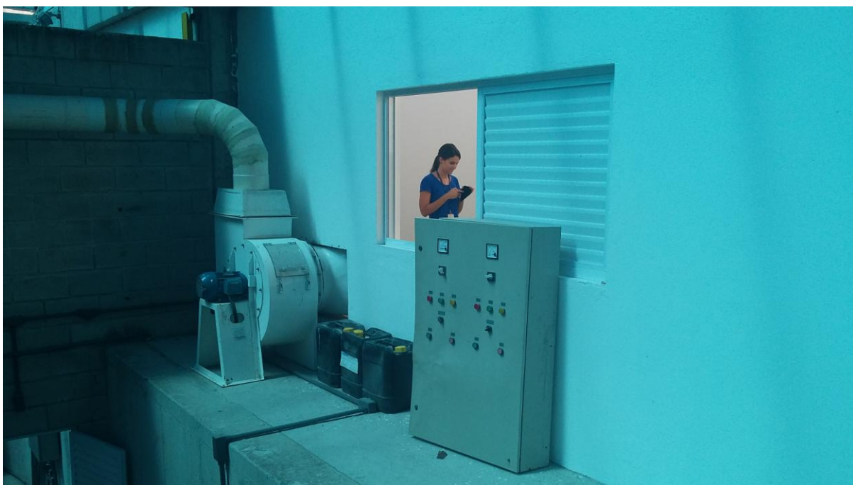
SISTEMA DE EXAUSTÃO DE GASES
