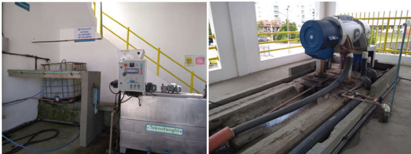
Foto 14 – Preparador de Polímero (esquerda) e Centrifuga Desidratação do Lodo (direita)
