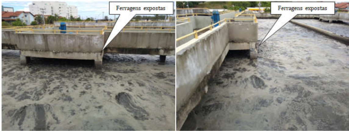
Foto 08 – Tanques de Aeração com 04 (quatro) Aeradores
