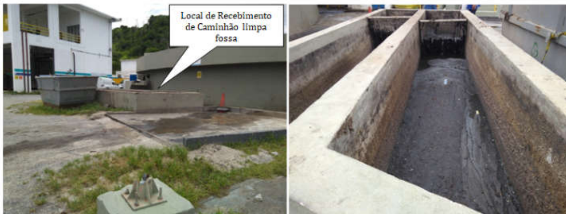
Foto 02 – Recebimento de Caminhão Limpa Fossa (primeiro gradeamento)
