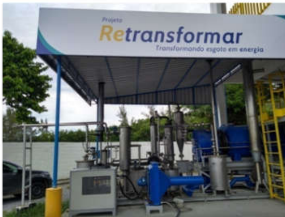
Foto 23 - Projeto Retransformar (O esgoto entra no reator de Pirólise)
