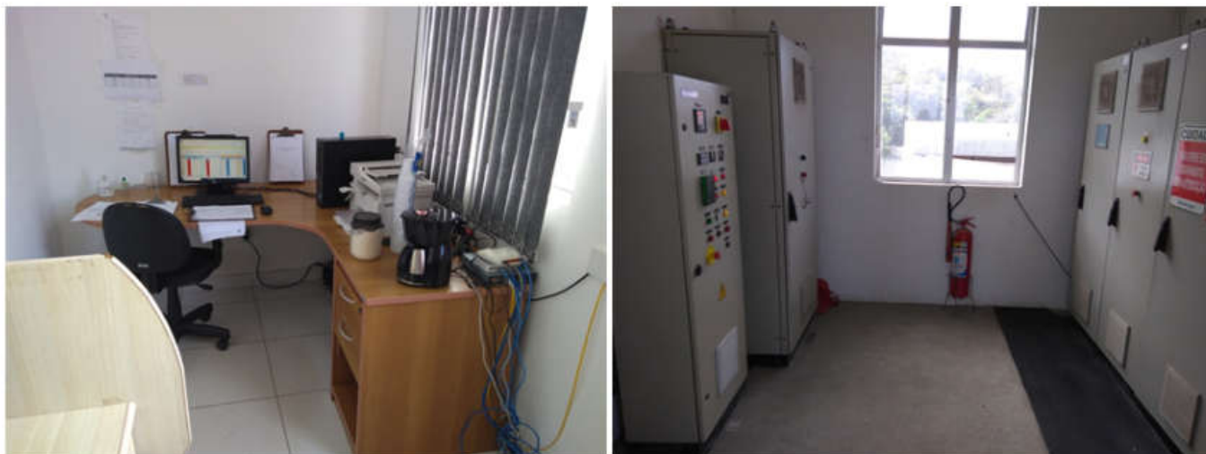
Foto 16 – Escritório da Estação de Tratamento de Esgoto (esquerda) e Painel de Controle (direita)
