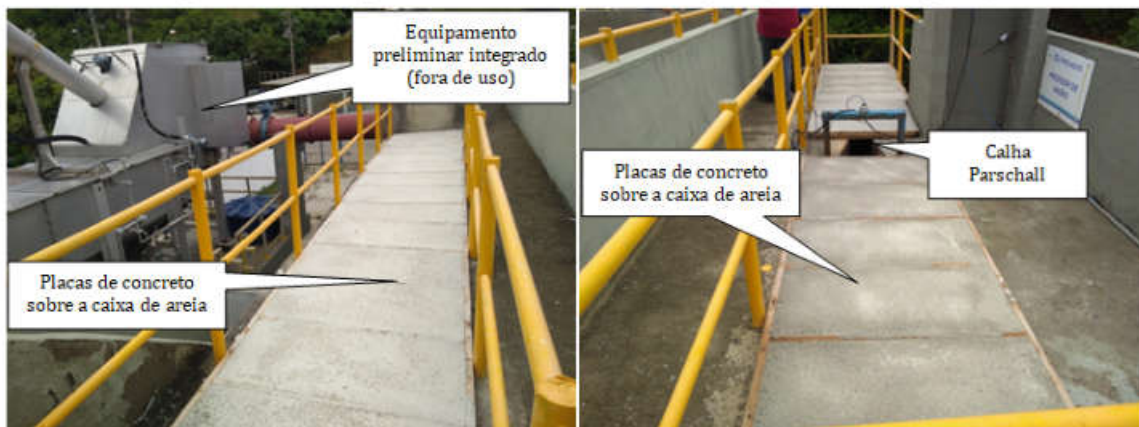
Foto 06 – Caixa de Areia e Calha Parschall com medidor de vão (coberto com placas de concreto)
