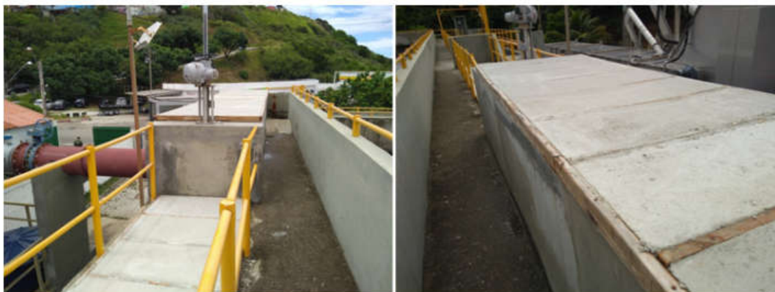
Foto 04 – Entrada do Esgoto In Natura Segundo Gradeamento Antes do Tanque de Aeração (coberto com placas de concreto)
