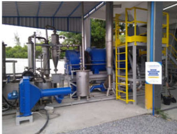
Foto 24 - Projeto Retransformar (O esgoto entra no reator de Pirólise)
