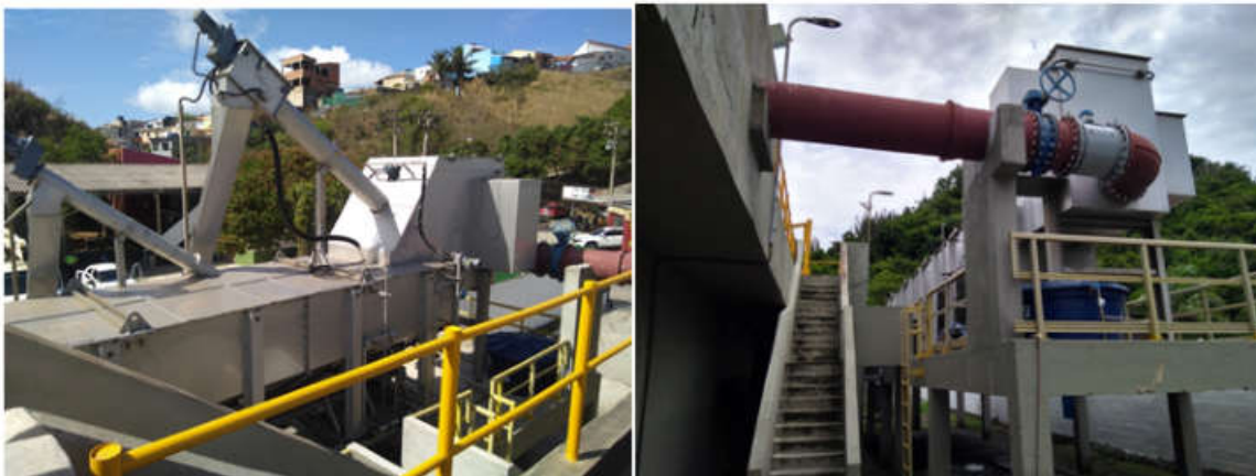
Foto 05 – Tratamento preliminar (fora de carga): sistema compacto mecanizado com limpeza mecanizada (gradeamento, desarenadores e remoção de gordura, óleos e graxas)
