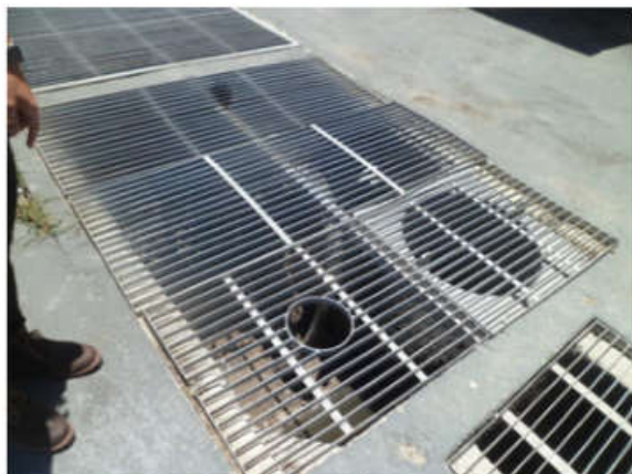
Foto 03 – Quinta Elevatória Dentro da ETE
