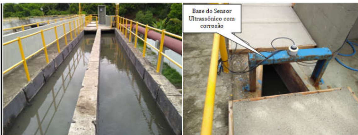
Foto 07 – Tanque de Areia antes da Calha Parschall
