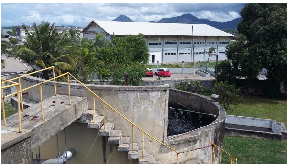
VISTA GERAL DO FILTRO BIOLÓGICO
