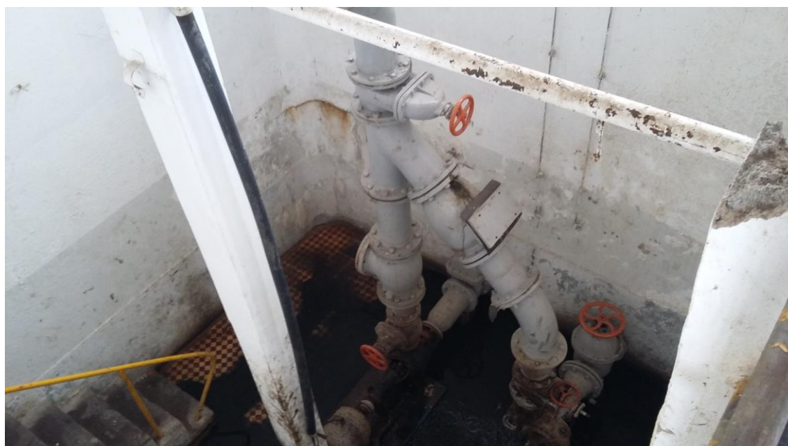
ESTAÇÃO ELEVATÓRIA - CONJUNTOS MOTOR-BOMBA
