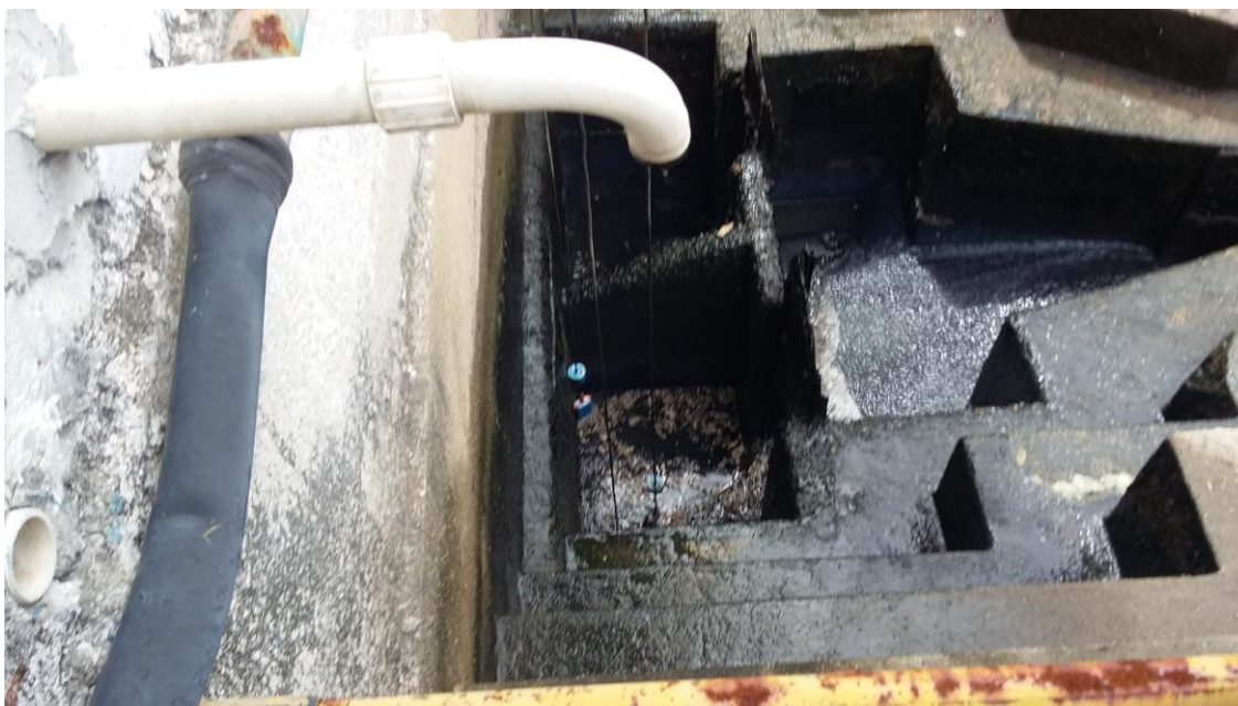
POÇO DE SUÇÃO COM AS BÓIAS DE NÍVEL (LIGA/DESLIGA DOS CONJUNTOS MOTOR-BOMBA)
