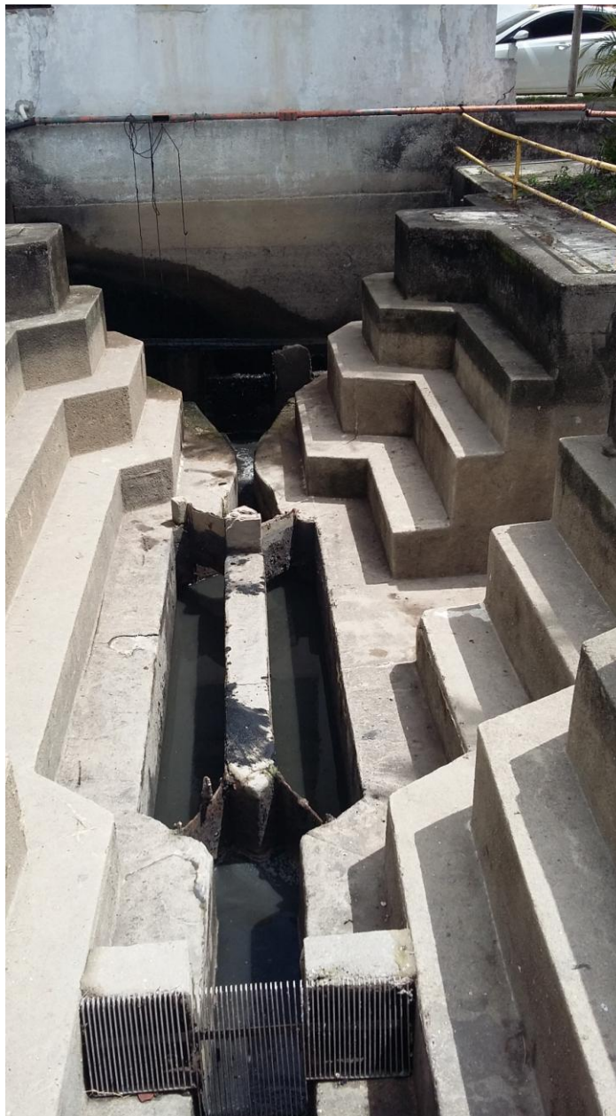
ESTRUTURA DE ENTRADA - GRADEAMENTO, CAIXA DE AREIA, CALHA PARSHALL E POÇO DE SUCÇÃO, AO FUNDO
