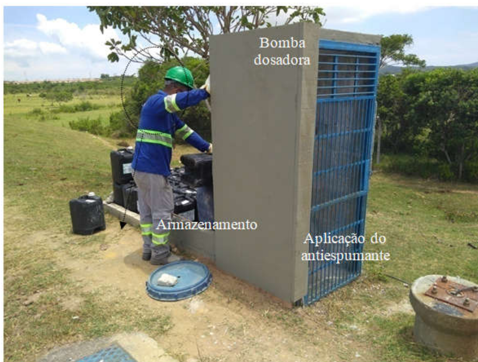
Figura 9 – Armazenamento e dosagem de antiespumante na saída das Lagoas de Maturação
