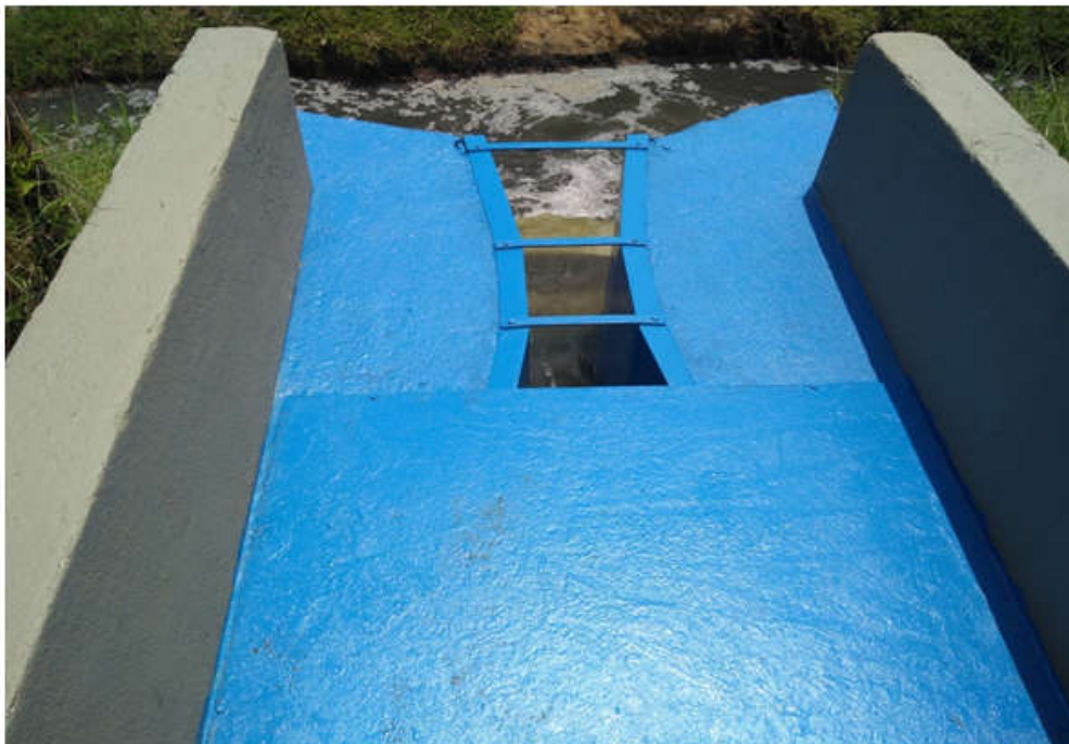
Figura 10 – Medidor de vazão do efluente final tipo Calha Parshall sem sensor ultrassônico e com régua ilegível e a saída do esgoto tratado para o canal Malhado. Chapa metálica sobre o medidor reformada e sem corrosão
