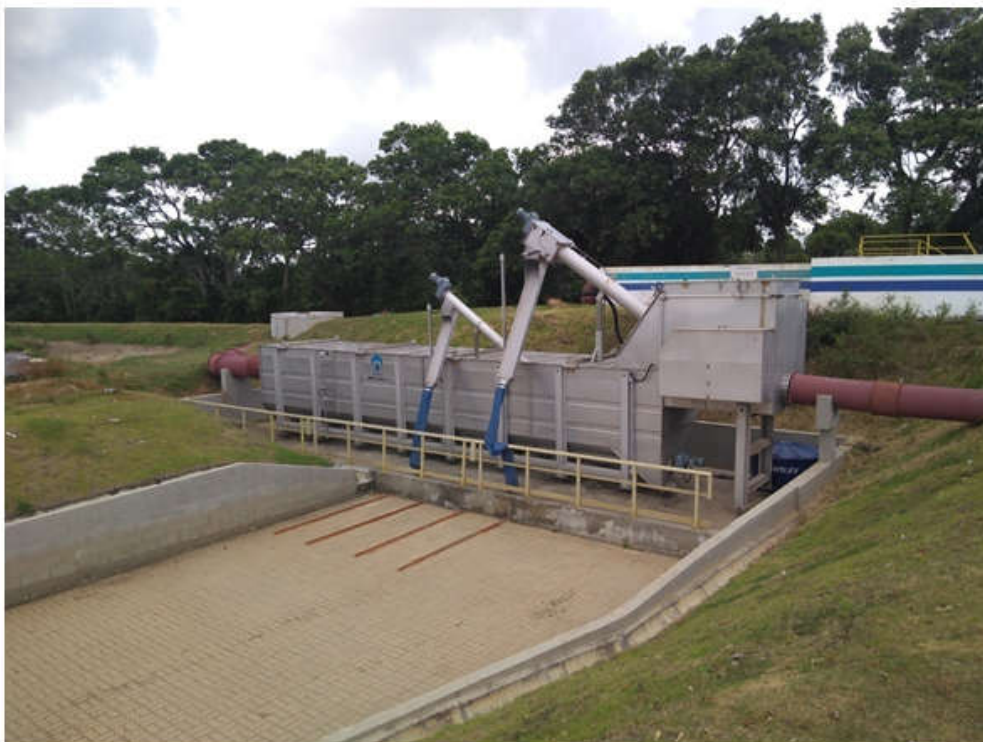
Figura 4 – Tratamento preliminar ( fora de carga ): sistema compacto mecanizado com limpeza mecanizada (gradeamento, desarenadores e remoção de gordura, óleos e graxas)
