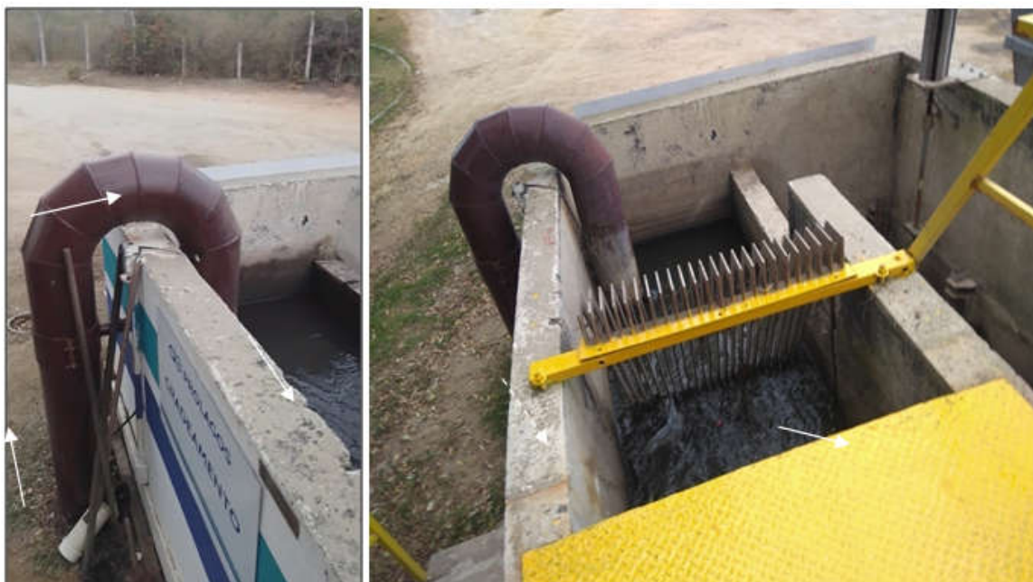
Figura 1 – Tratamento preliminar (trecho inicial): entrada afogada do recalque de esgoto bruto; gradeamento em barras a 45° com espaçamento (abertura) tipo grosseiro e fino com limpeza manual;
