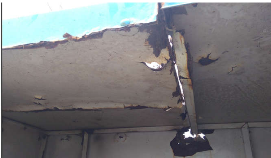
Figura 7 – Estrutura do Gerador com vários pontos de Ferrugens
