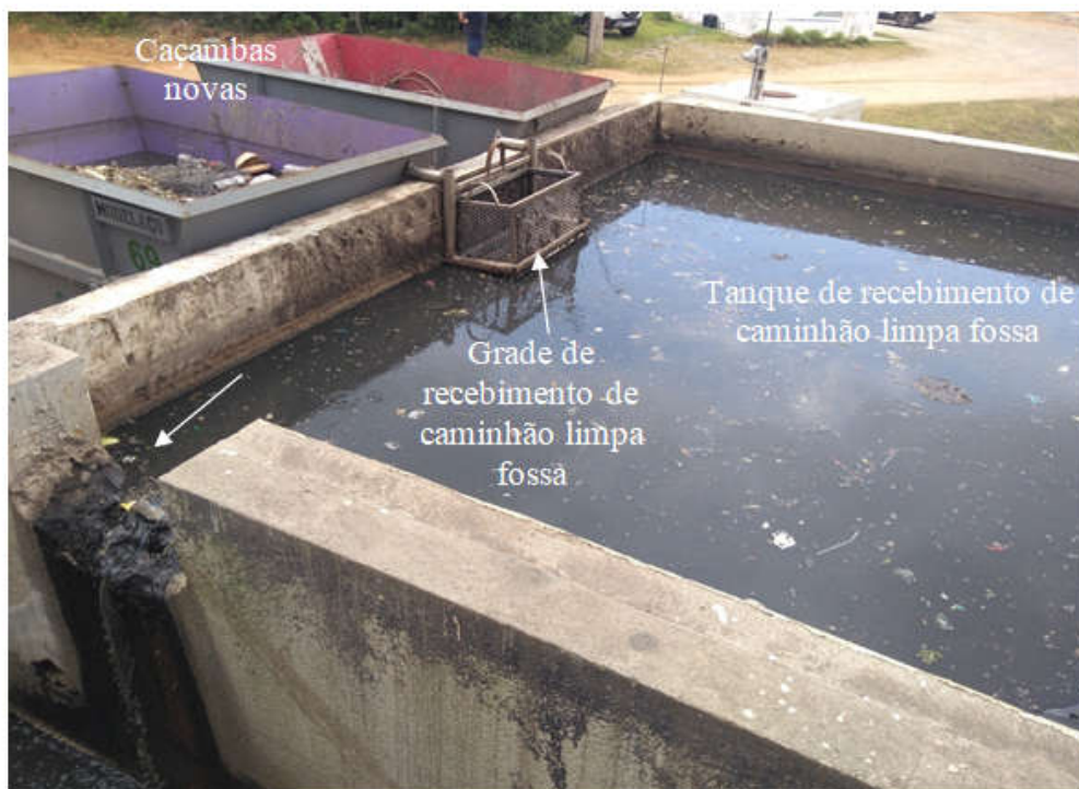
Figura 3 – Duas caçambas para armazenamento de resíduos sólidos e areia da entrada da ETE. Tanque de recebimento dos caminhões limpa fossa (melhoria realizada pela concessionária)
