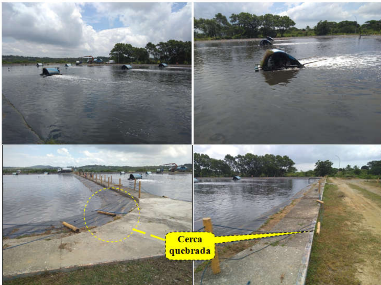
Figura 6 – Duas Lagoas de Decantação com Polimento (Maturação) para remoção de fósforo (coagulação com PAC). Cerca de proteção quebrada em alguns pontos
