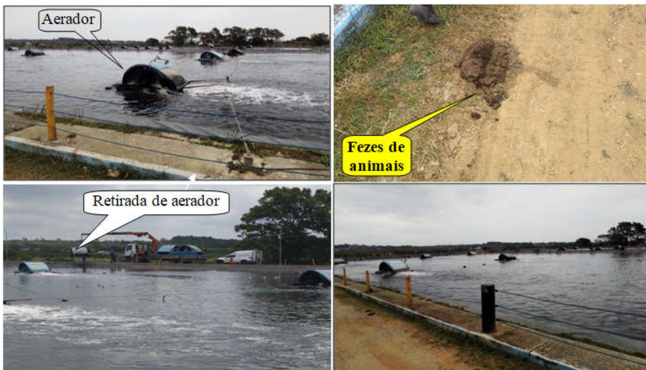
Figura 5 – Duas Lagoas Aeradas com 8 aeradores tipo cachoeira cada ( no dia da vistoria, um aerador estava sendo retirado para manutenção ). Presença de animais terrestres na ETE ( fezes )
