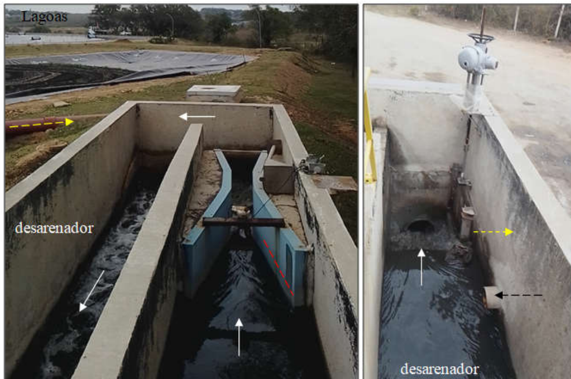
Figura 2 – Tratamento preliminar: trecho médio com medidor de vazão tipo calha Parshall com sensor ultrassônico ( inoperante: visto no CCO ) e régua ilegível ; trecho final com saída do esgoto pré-tratado para as lagoas (saída canal desarenador), comporta de desvio para tratamento preliminar compacto mecanizado ( fora de uso ), e entrada do efluente líquido dos caminhões limpa-fossa.
