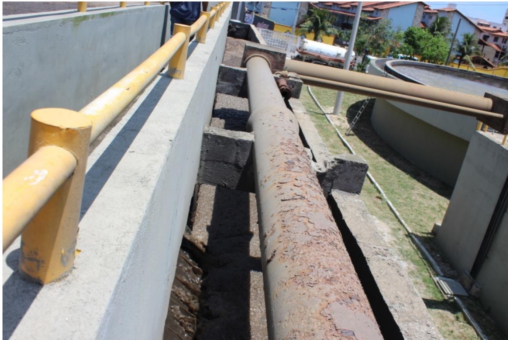
Foto 16 – Saída do aerador para o decantador
