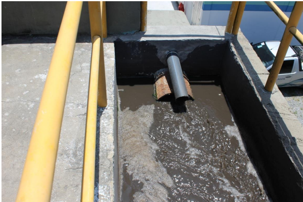
Foto 15 – Saída do tanque de aeração para o medidor de vazão
