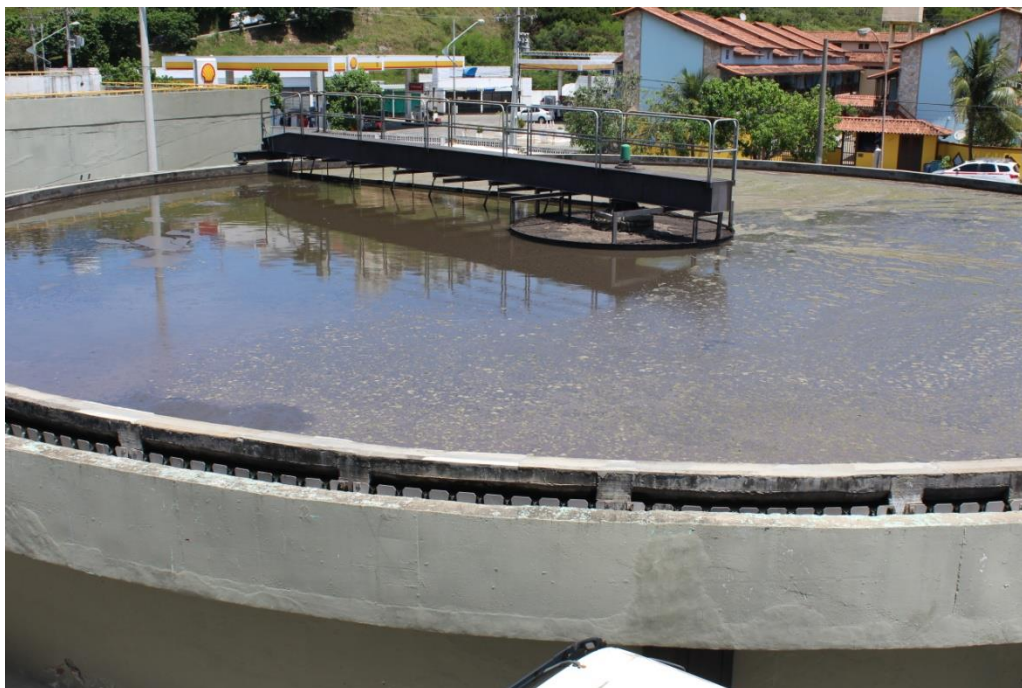
Foto 18 –Decantador (vista superior)
