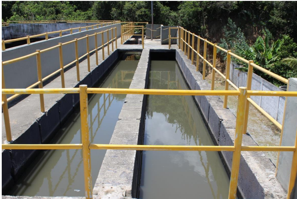
Foto 10 – Caixas de Areia – Entrada de esgoto In Natura
