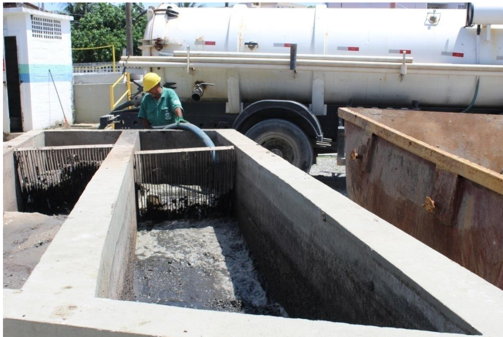
Foto 04 – Caminhão despejando esgoto In Natura na caixa de entrada
