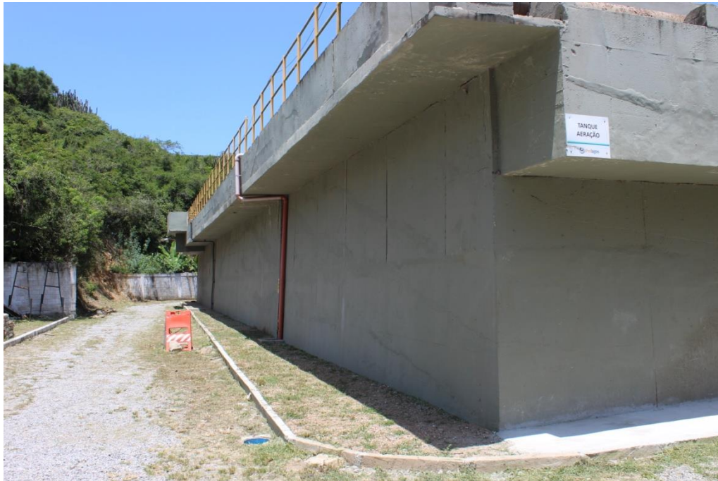
Foto 06 – Vista lateral esquerda do tanque de aeração
