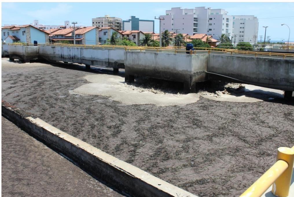
Foto 13 – Tanque de aeração com 4 motores
