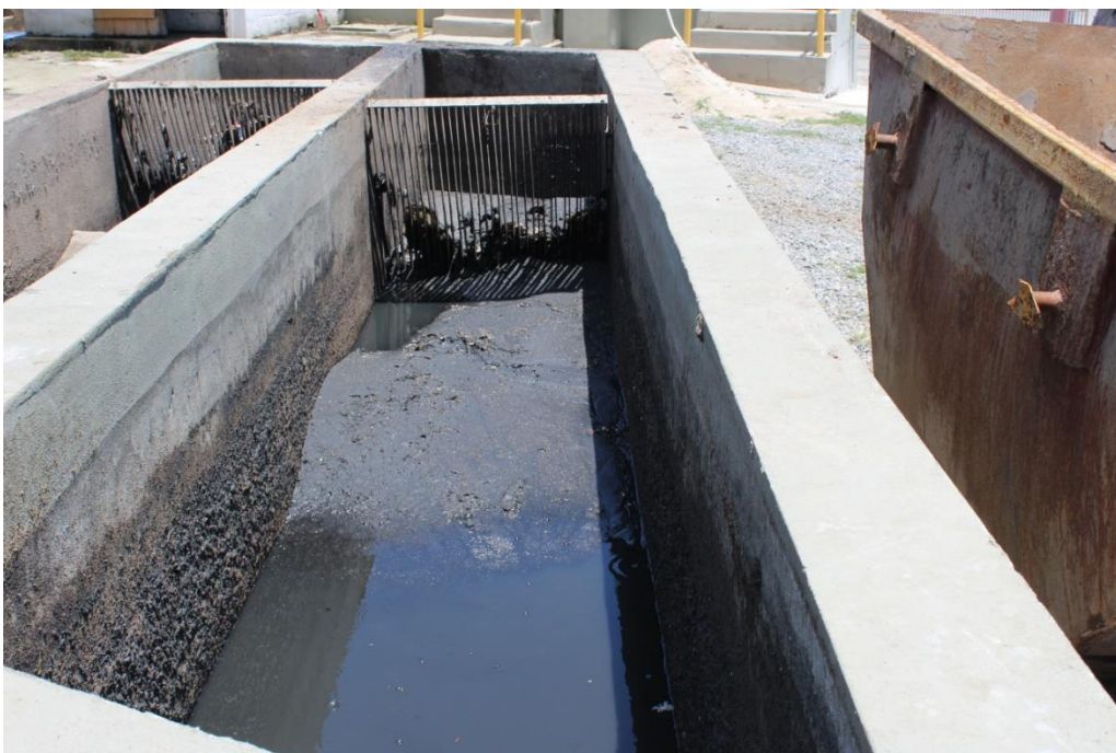
Foto 03 – Duas caixas de areia e recebimento de caminhão fossa
