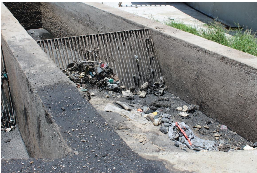
Foto 02 – Caixa de Recebimento de Caminhão Fossa
