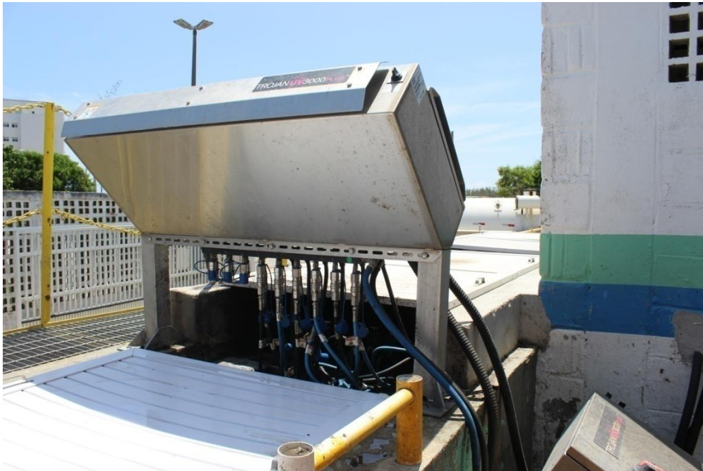
Foto 30 – Sistema Ultravioletas para Desinfecção
