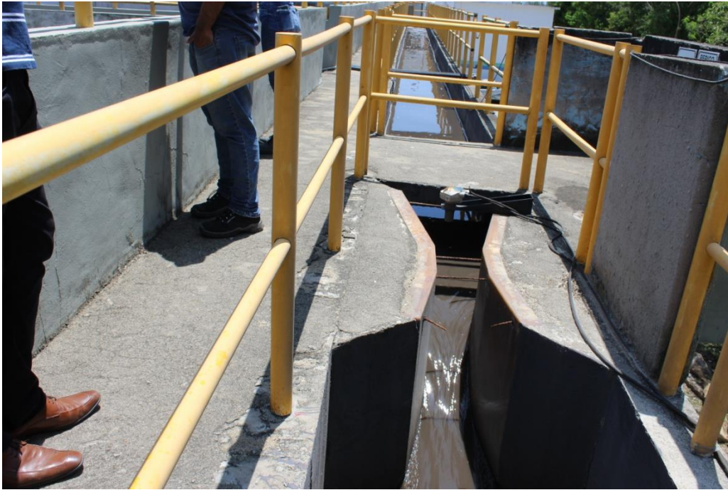
Foto 14 – Medidor de vazão
