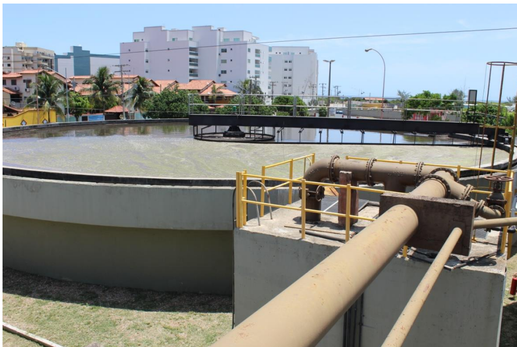
Foto 17 – Tubulação de saída do aerador para decantador
