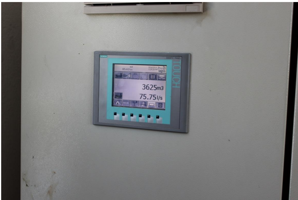
Foto 22 – Painel de Comando
