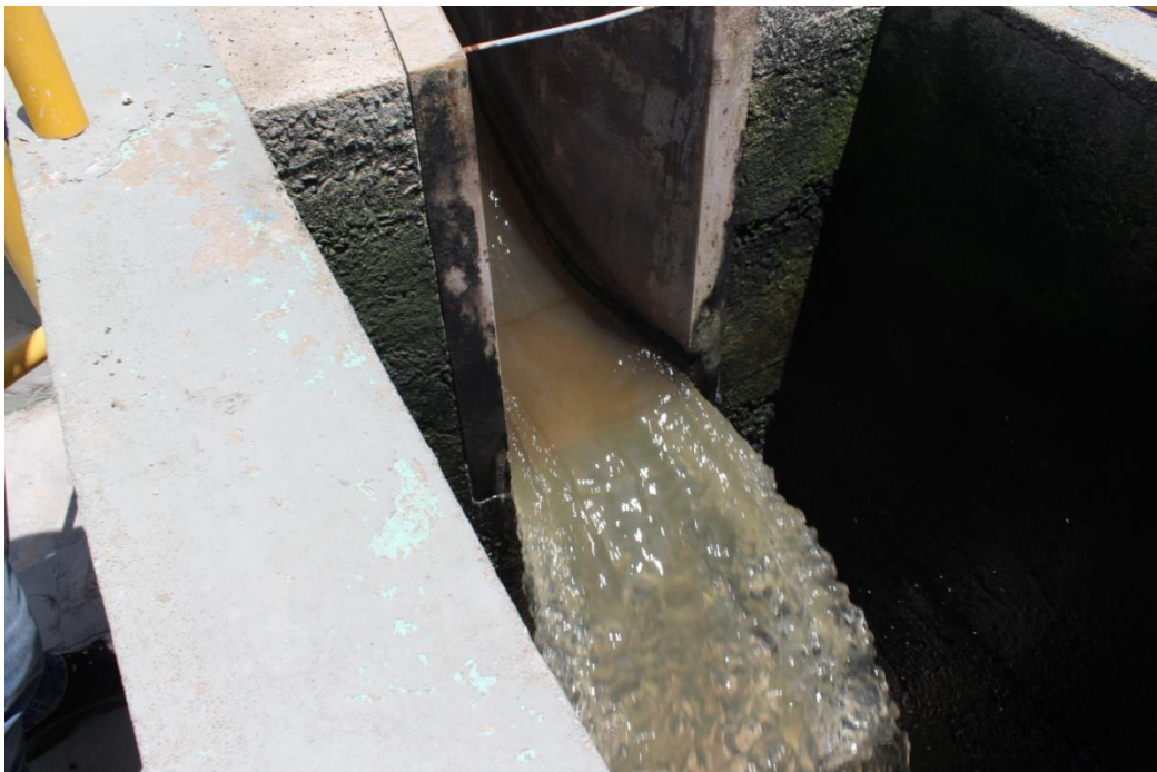
Foto 31 – Saída do esgoto tratado
