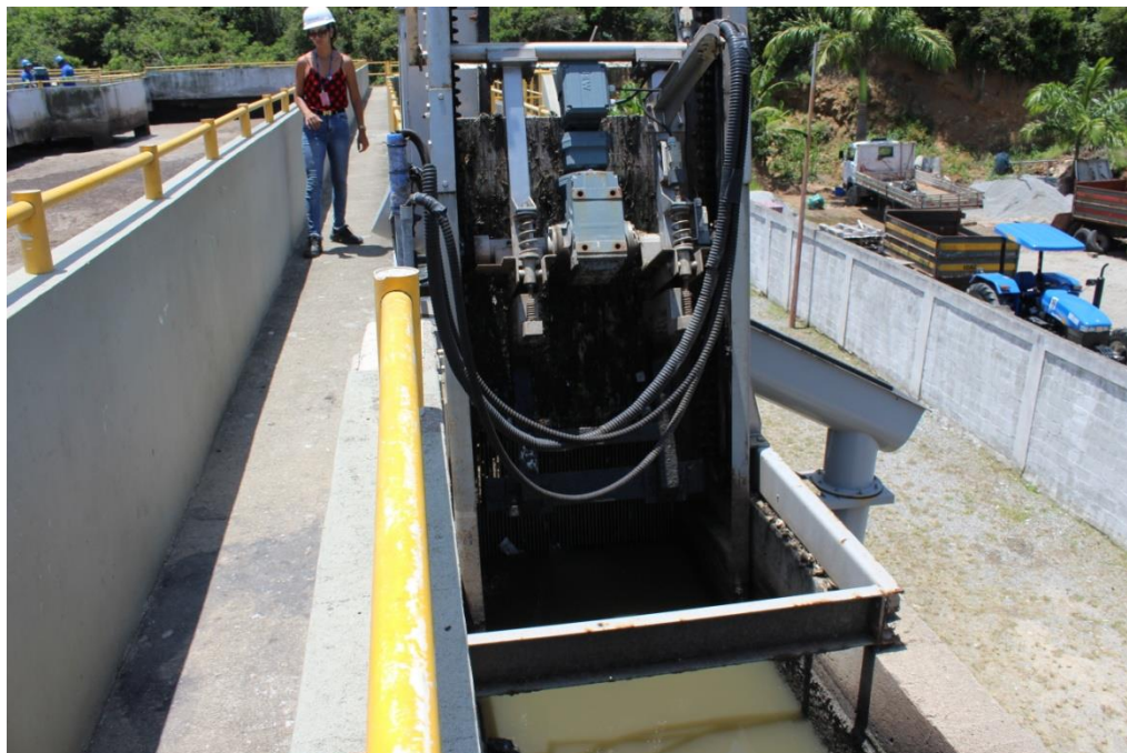
Foto 07 – Gradeamento mecanizado cremalheira entrada de esgoto
