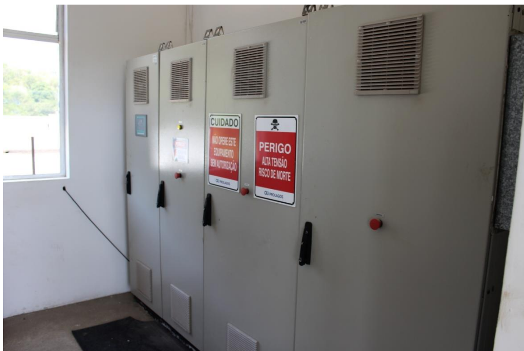
Foto 23 – Sala do Painel de Comando
