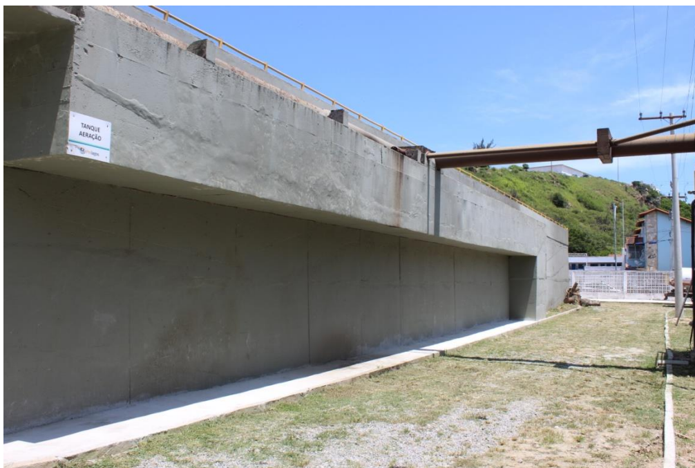
Foto 05 – Vista lateral direita do tanque de aerção
