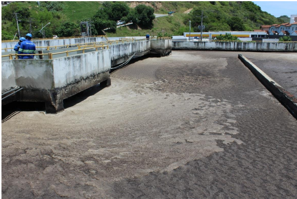
Foto 12 – Tanque de aeração
