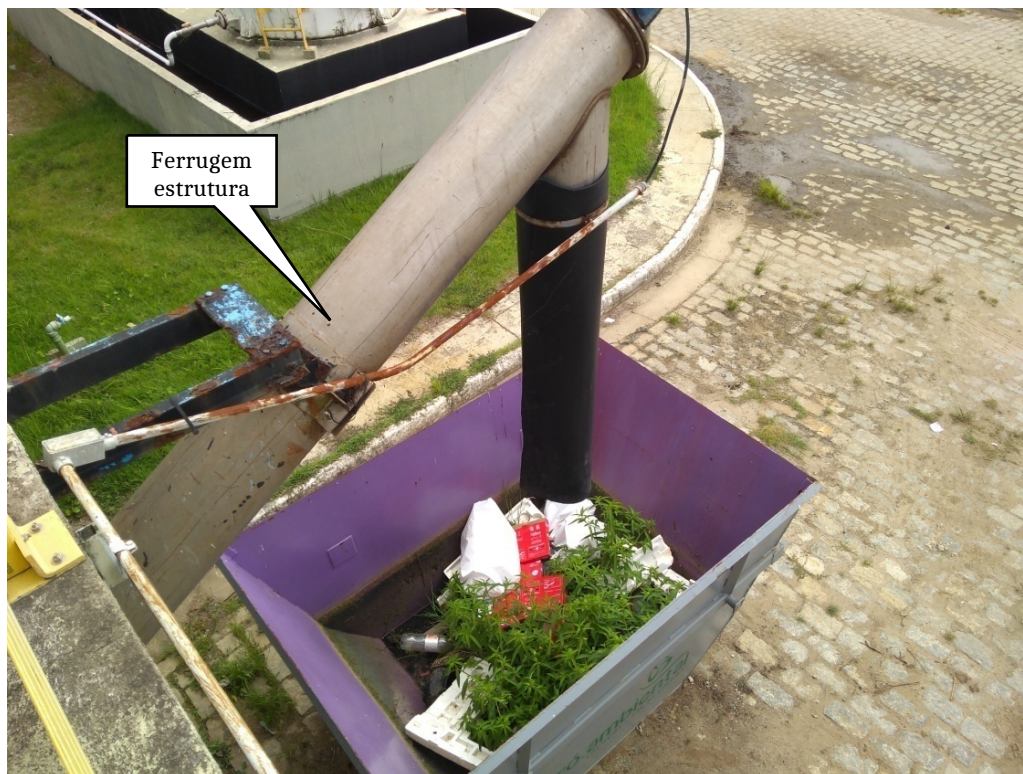
Foto 7 – Roscas transportadoras para resíduos sólidos fora de carga, sem vestígio de areia na caçamba coletora
