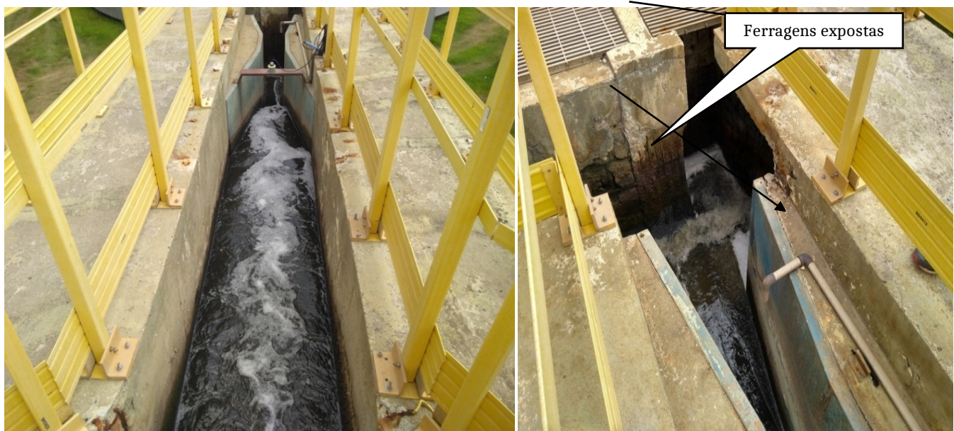
Foto 8 – Calha parshall com medidor de vazão ultrassônico e régua ilegível . Destaque para o ponto de aplicação do PAC (tratamento químico) e parede com armadura exposta
