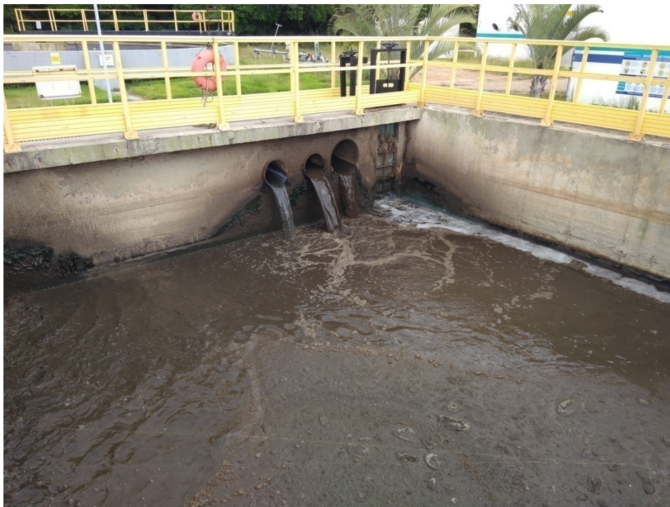
Foto 14 – Tanque anóxico: entrada do esgoto bruto e do lodo recirculado
