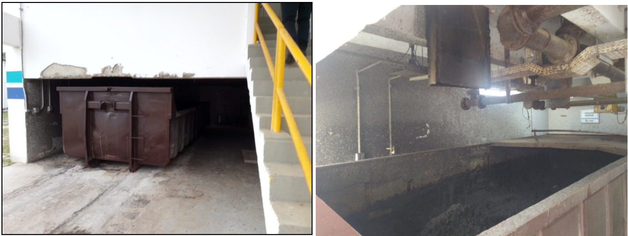
Foto 22 – Armazenamento de Lodo na Caçamba (vistas frontal e interna)
