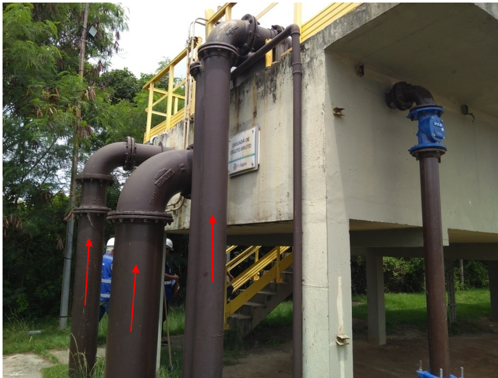
Figura 3 – Entrada do Esgoto Bruto no tratamento preliminar
