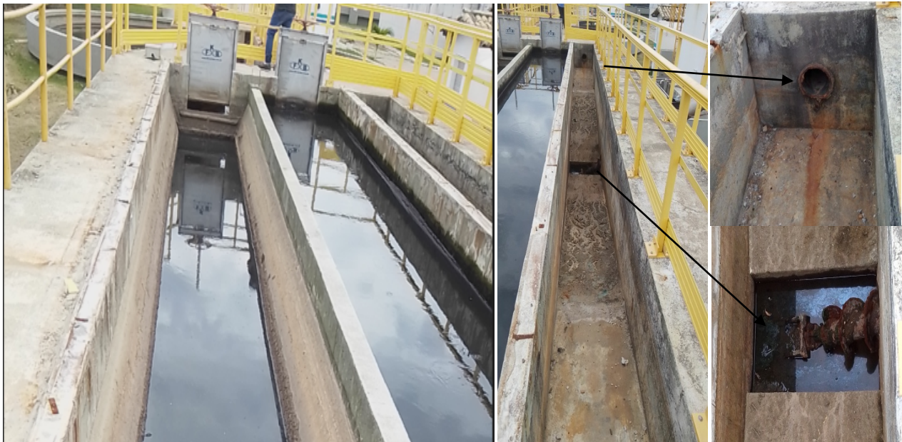
Foto 6 – Três desarenadores (caixas de areia), sendo um fora de carga (canal mais a direita)
