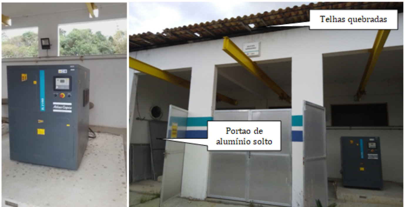
Foto 13 – Sala dos sopradores de ar para os tanques de aeração (vistas interna e externa), telhas quebras e portão de alumínio quebrado.
