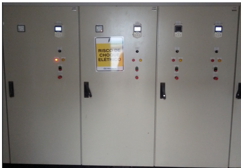
Foto 23 – Painéis de Comando dos motores da ETE
