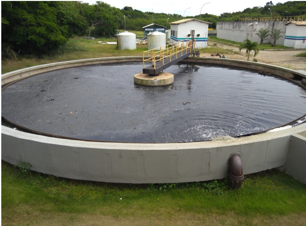
Foto 9 – Decantador Primário (bypassando)
