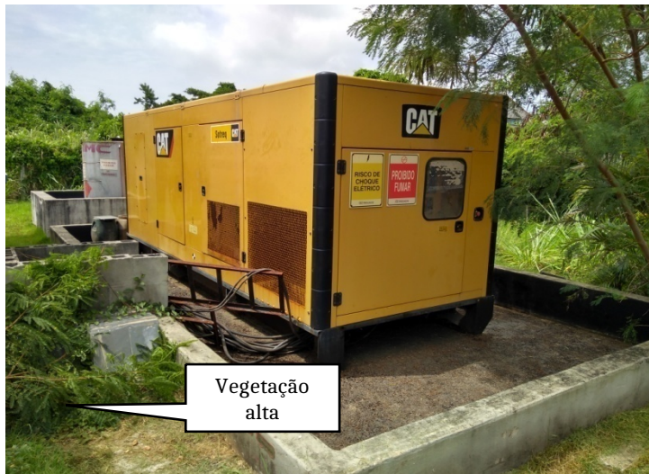
Foto 27 – Gerador a diesel, com tanque combustível em baía de contenção ao fundo
