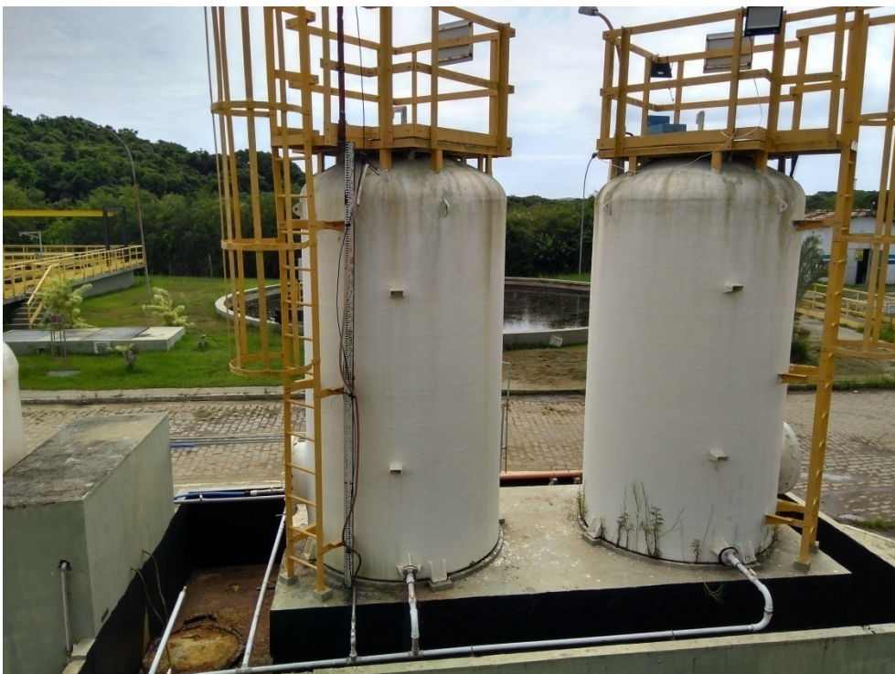
Foto 10 – Tratamento físico-químico: tanques de produtos químicos com PAC para remoção de fósforo
