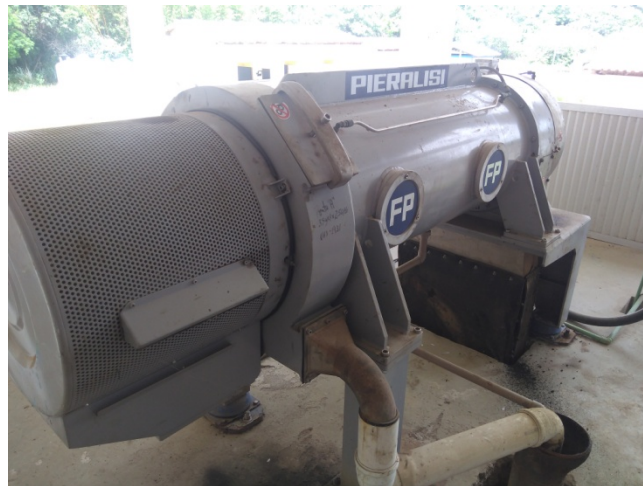
Foto 21 - Tratamento do lodo: desidratação com duas centrífugas
