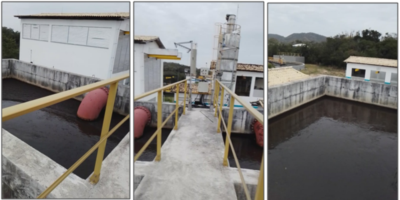
Foto 12 – Câmaras anóxicas anexas aos tanques de aeração
