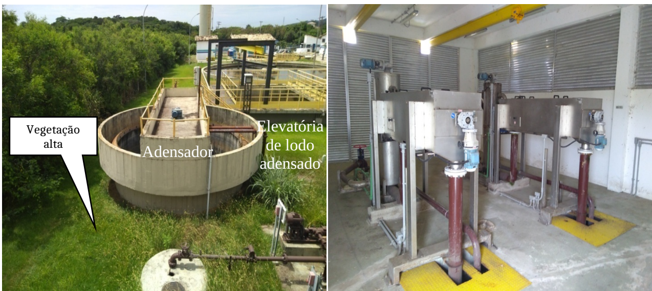
Foto 20 – Tratamento do lodo: adensador gravimétrico desativado e elevatória de lodo adensado (imagem da esquerda) e dois adensadores mecânicos em funcionamento (imagem da direita)
