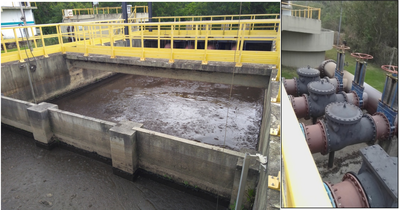
Foto 15 – Tanque anóxico: saída do esgoto para o tratamento secundário
