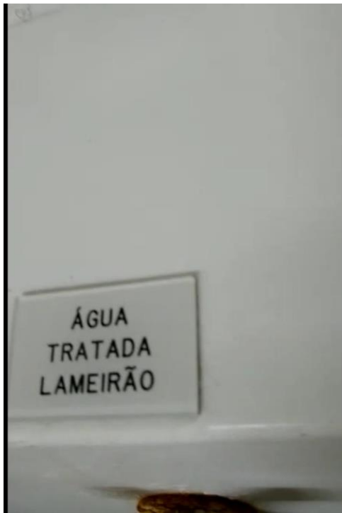
Foto 12- Água Tratada de Lameirão
