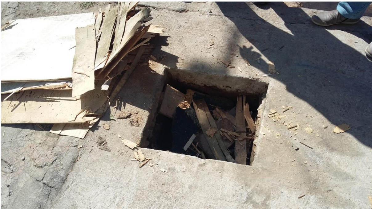
DETALHE DA CAIXA DE INSPEÇÃO TOTALMENTE OBSTRUÍDA - EM 29-06-2016
