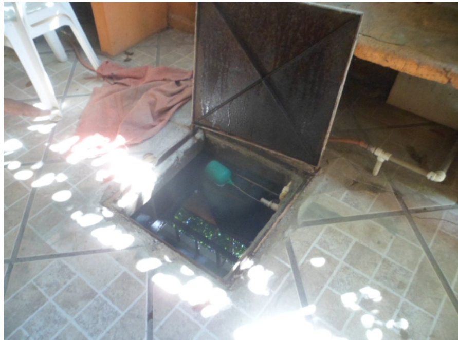
Foto 10 – Rua Córrego Danta, Lote 32 – Quadra 22, Sr. Jorge Silva (cisterna totalmente cheia)
