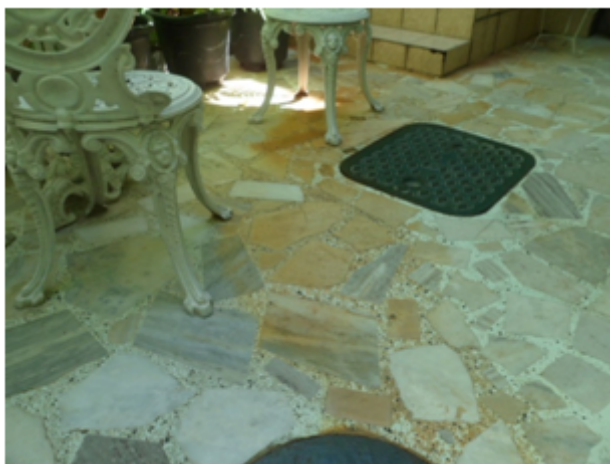
Foto 05 – Marcas da infiltração no chão
