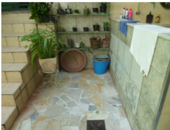
Foto 07 – Marcas da infiltração no chão
