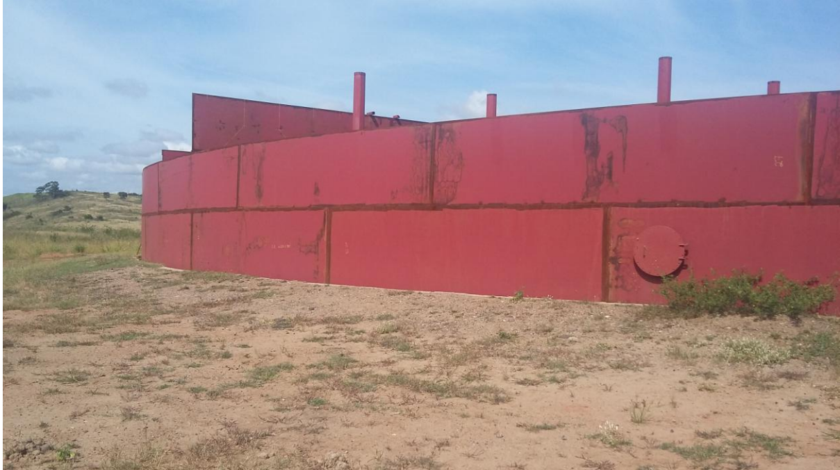
ETE ITAPERUNA - DETALHE - OBRAS PARALISADAS
