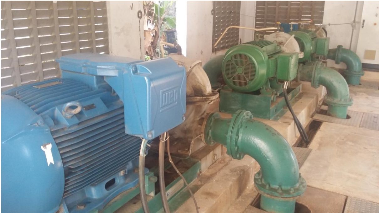
ESTAÇÃO ELEVATÓRIA - CONJUNTOS MOTOR-BOMBA
