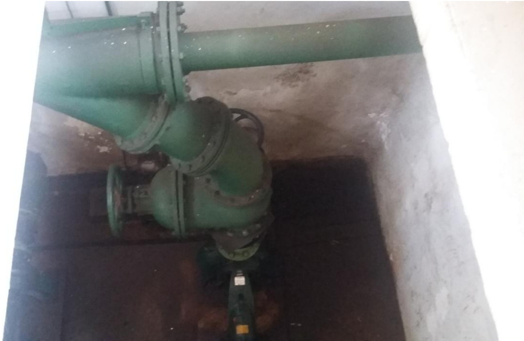
DETALHE DO CONJUNTO MOTOR-BOMBA
