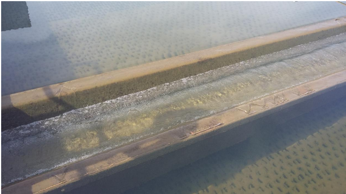
DETALHE DA CALHA DE ÁGUA DECANTADA - NO FUNDO, OS MÓDULOS LAMELARES
