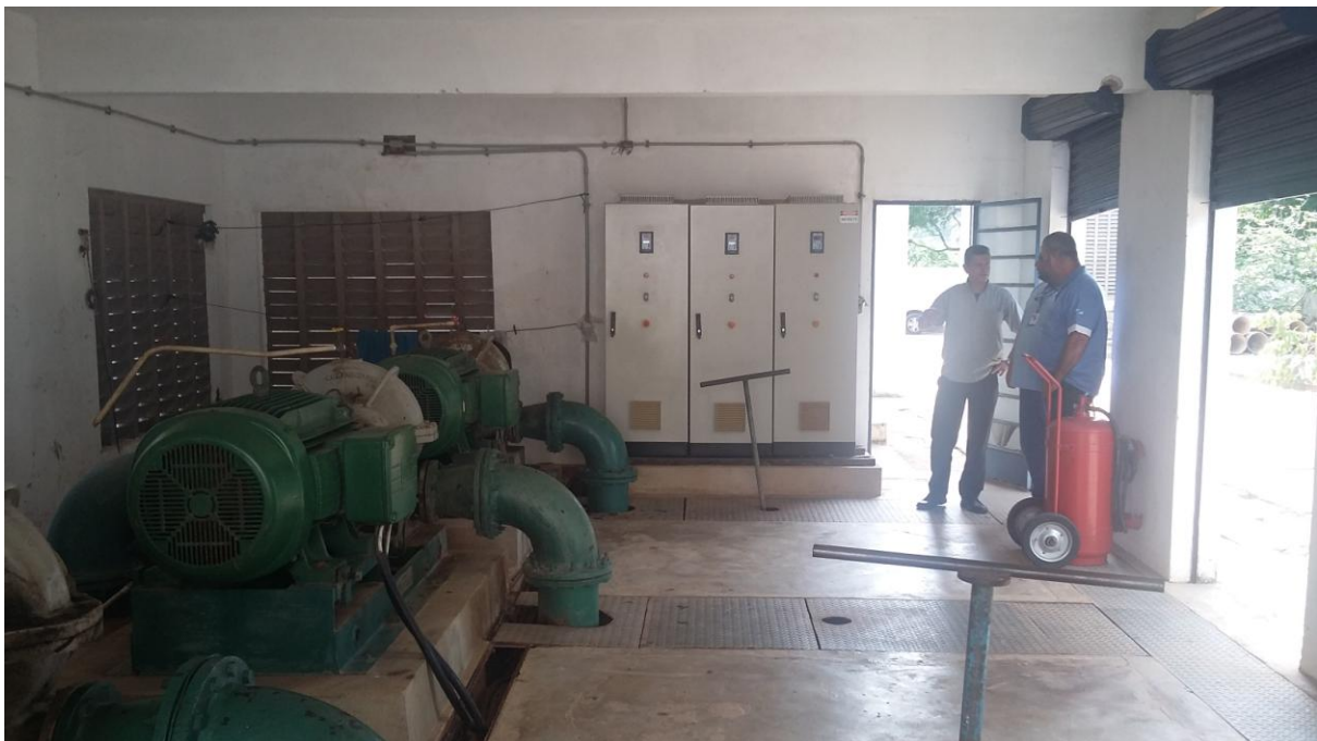
ESTAÇÃO ELEVATÓRIA - VISTA GERAL
