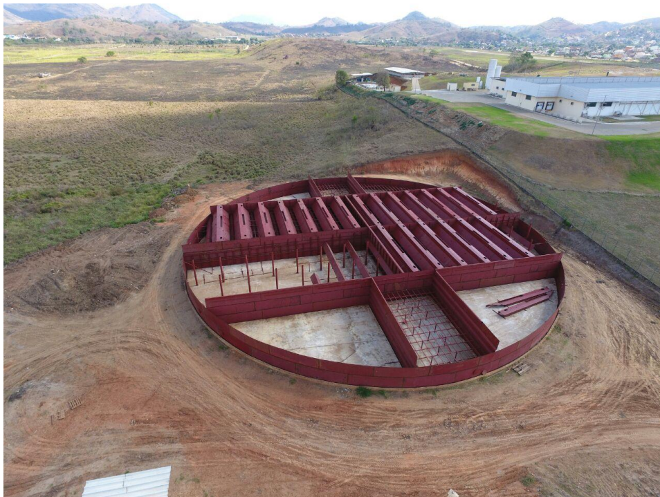
ETE ITAPERUNA - VISTA AÉREA - OBRAS PARALISADAS
