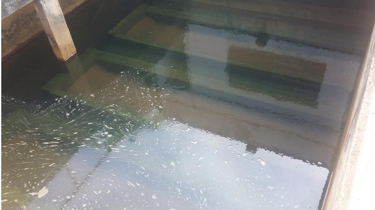
DETALHE - UM DOS FILTROS
