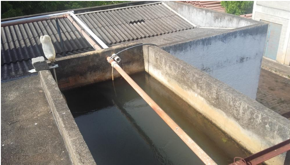
CAIXA DE ENTRADA - PONTO DE APLICAÇÃO DE PRODUTOS QUÍMICOS
