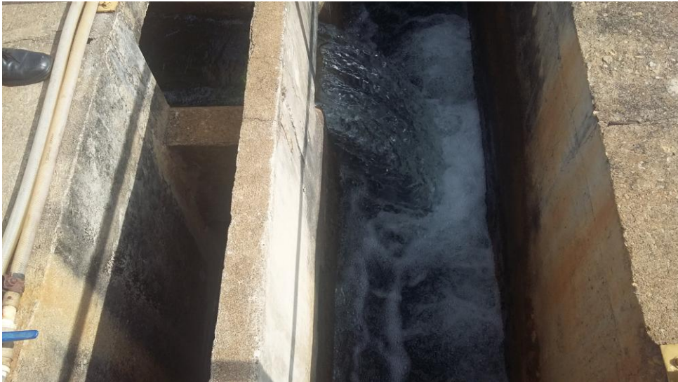
PASSAGEM DA ÁGUA DECANTADA PARA O CANAL DE LIGAÇÃO COM OS FILTROS
