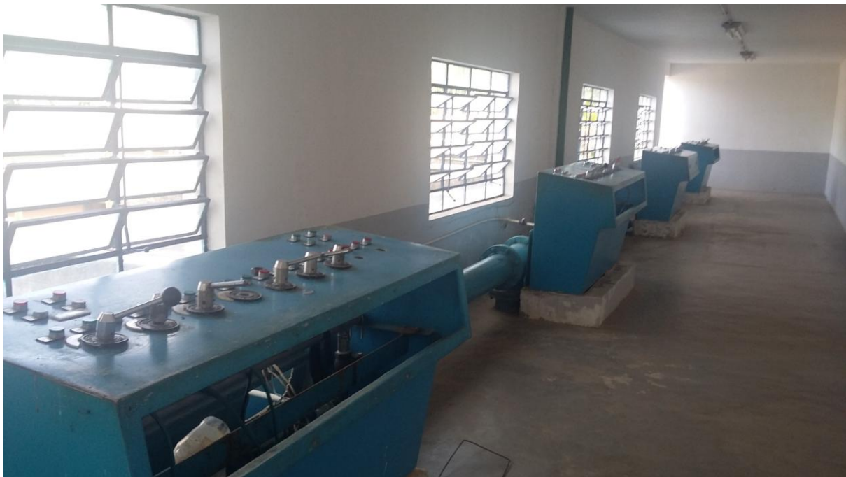
MESAS DE COMANDO PARA OPERAÇÃO DOS FILTROS
