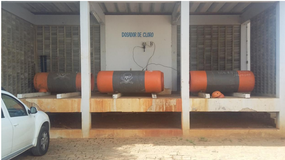
CILINDROS DE CLORO GASOSO - DESINFECÇÃO
