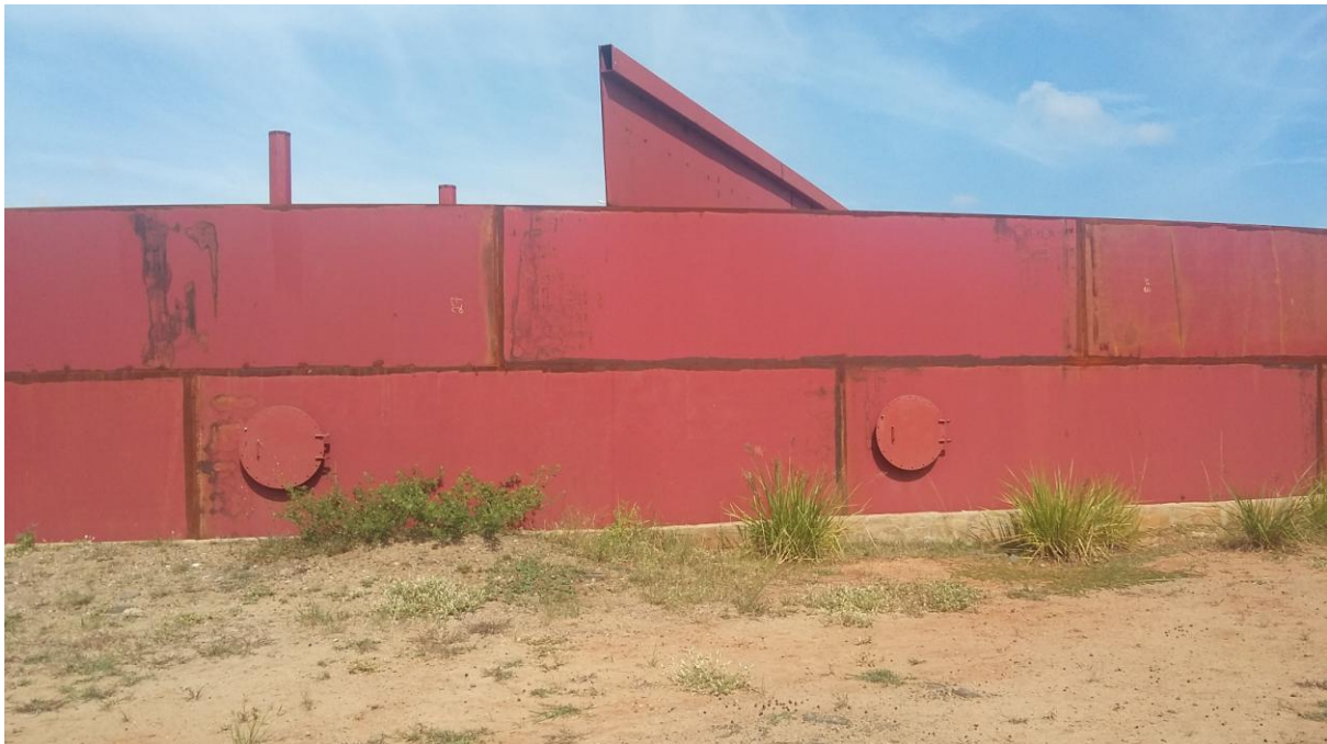
ETE ITAPERUNA - DETALHE - OBRAS PARALISADAS
