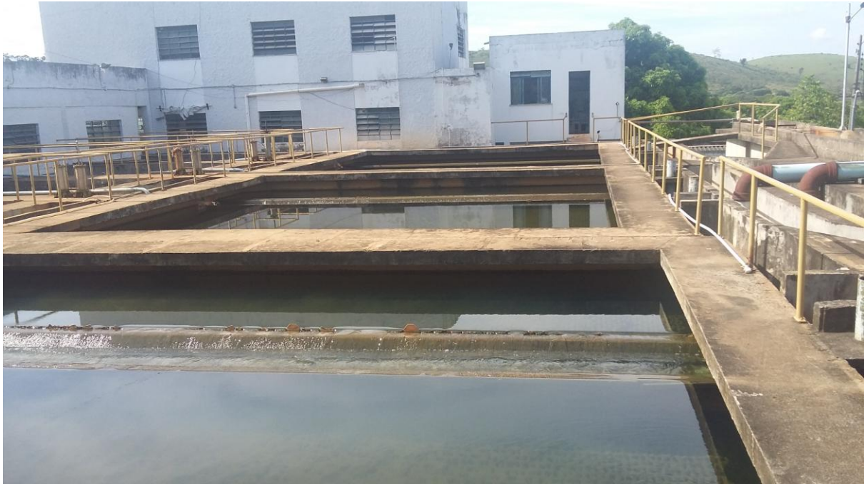
DECANTADORES - VISTA GERAL
