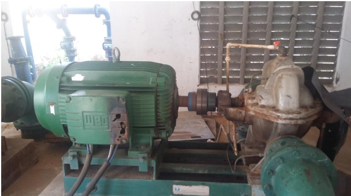
ESTAÇÃO ELEVATÓRIA - DETALHE DO CONJUNTO MOTOR-BOMBA
