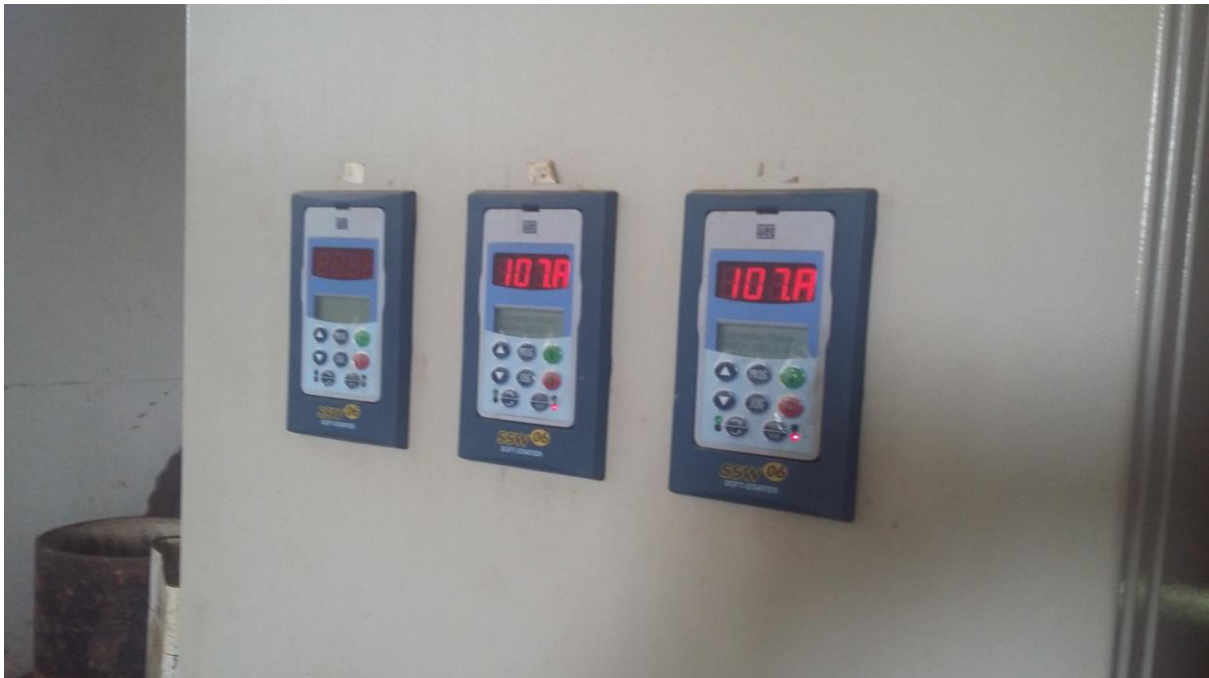
QUADRO DE COMANDO DOS CONJUNTOS MOTOR-BOMBA - DOIS EM OPERAÇÃO E UM RESERVA
