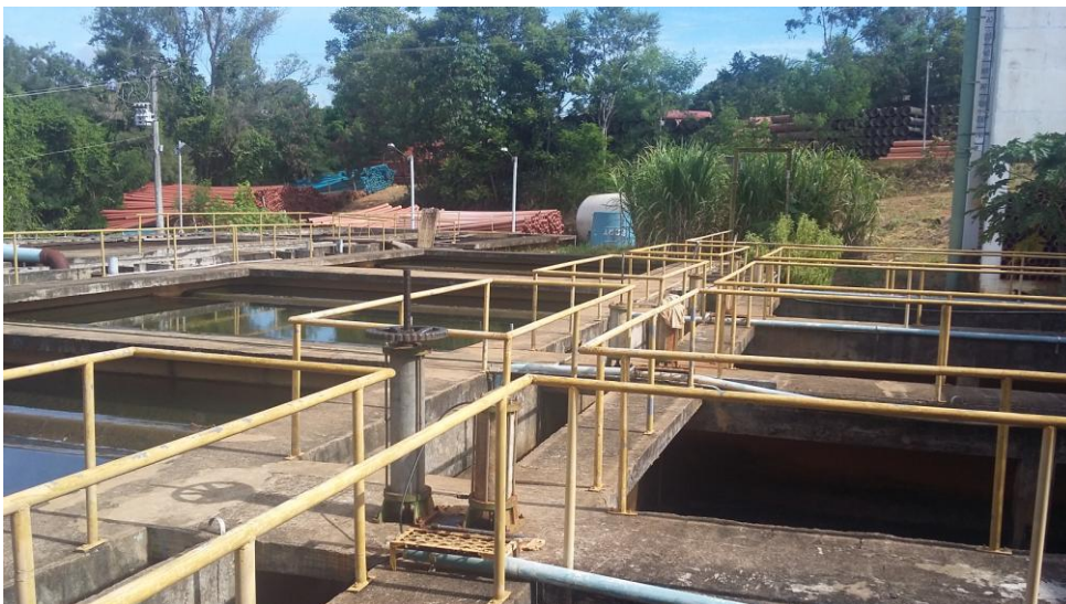
VISTA GERAL DOS FILTROS
