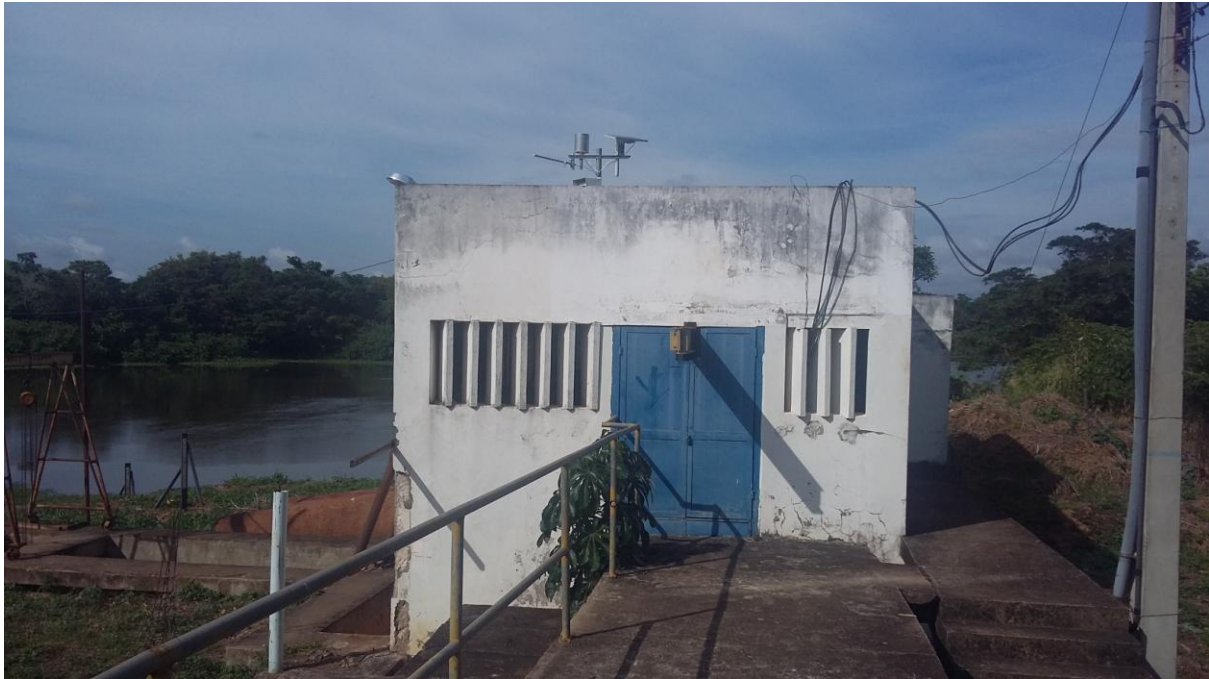
ESTAÇÃO ELEVATÓRIA DE ÁGUA BRUTA - RIO MURIAÉ
