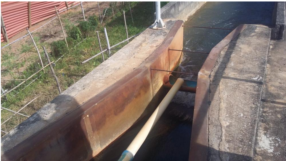
CALHA PARSHALL - PONTO DE APLICAÇÃO DE PRODUTOS QUÍMICOS
