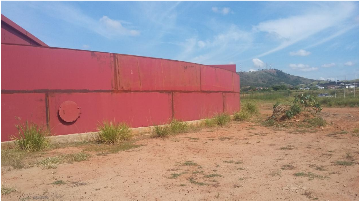
ETE ITAPERUNA - DETALHE - OBRAS PARALISADAS
