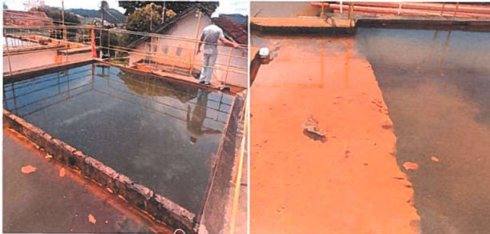
Decantador da primeira ETA
