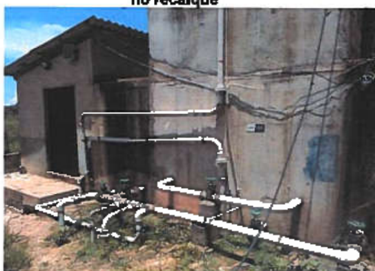
Reservatório e barrilete dos Troncos Distribuidores
