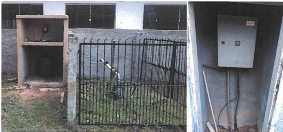
Bomba dosadora - Poço - Painelelctrico
