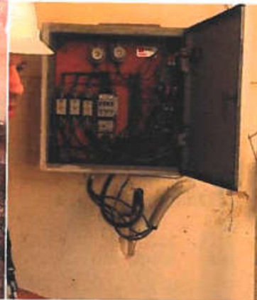
Painel de bomba
