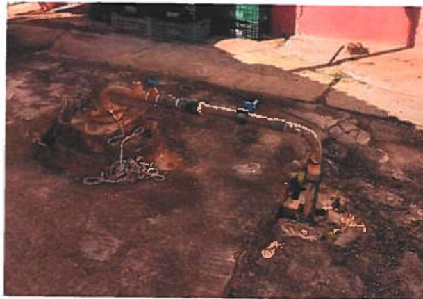
Captação do Poço Bacelar
