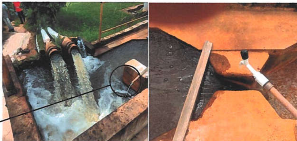
Entrada de água bruta na ETA + Cal Hidratado e PAC 10
