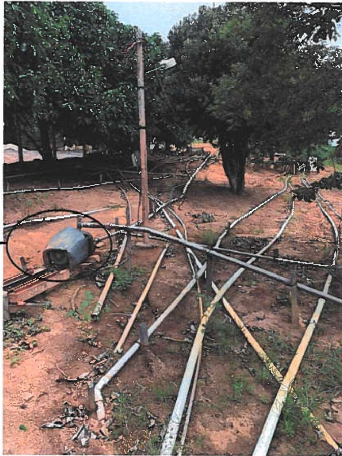
Tubulações de adução de saída da ETA Batalha
