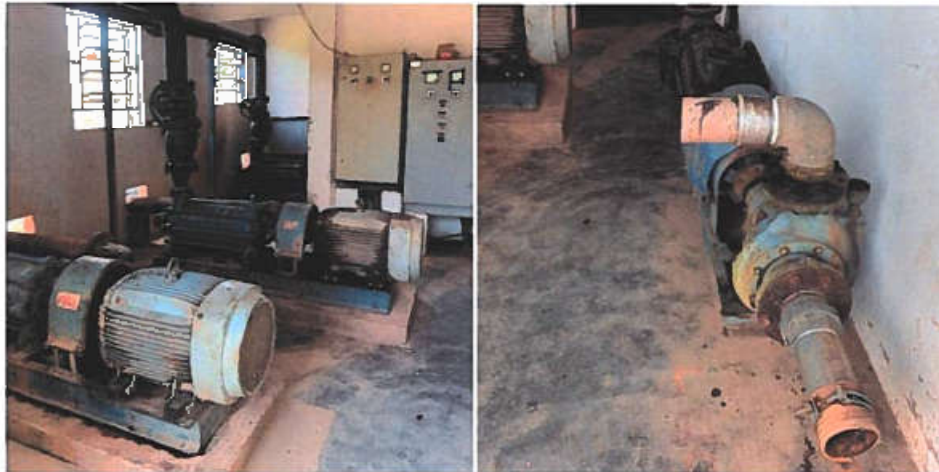
Bombas em operação e bomba para manutenção
