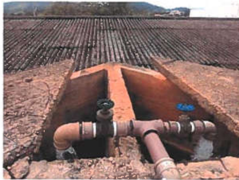
Entrada de água nos reservatórios
