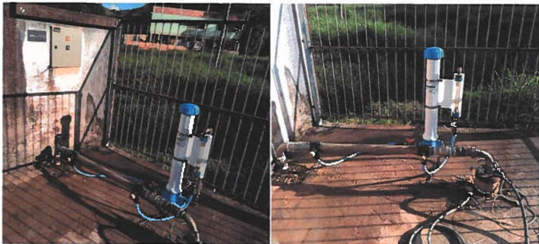
Captação do Poço Córrego da Prata - Painel elétrico - Dosador de cloro
