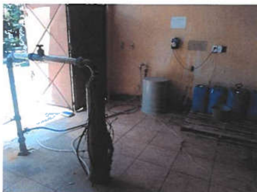
Poço e bomba dosadora injetando Hipoclorito no recalque
