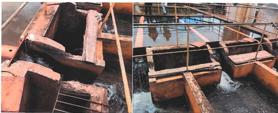
Filtros da ETA
