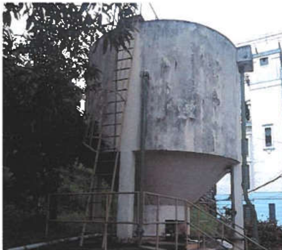
Floco-decantador cilíndrico aberto (em concreto)
