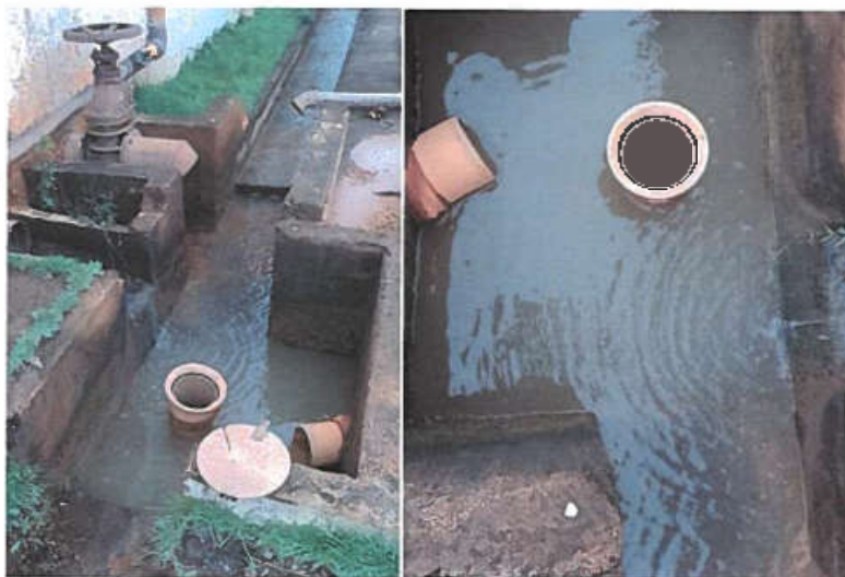
Sistema de descarga do lodo
