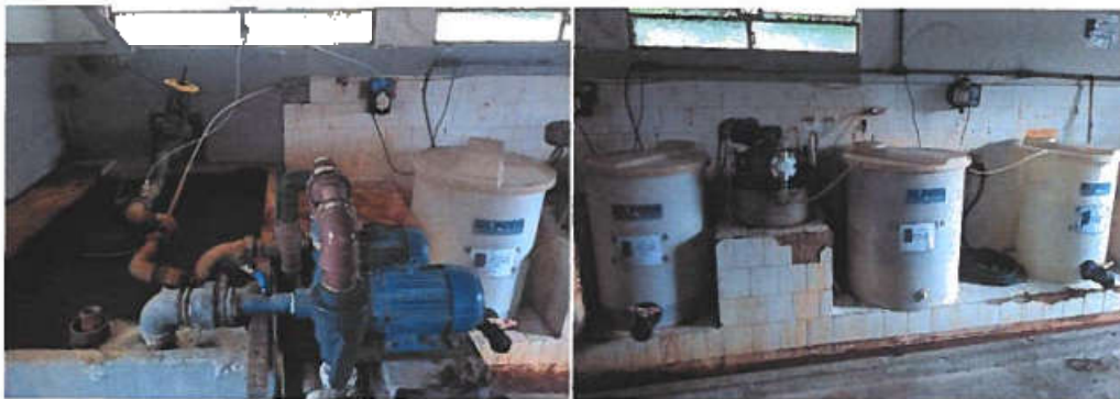
Chegada da água bruta na ETA, ponto de dosagem do PAC (floculante) e Carbonato de sódio (Alcalinizante)
