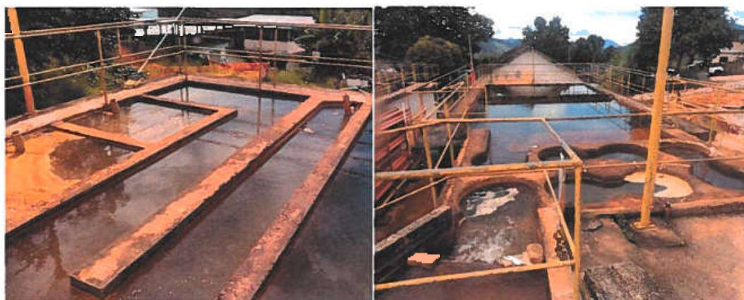
Floculador da primeira ETA
